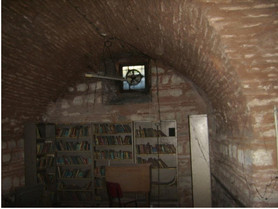
Ek-3 Murad Molla Kütüphanesi- Temelini Oluşturan Bizans Mahzeni (Fotoğraf: Mimar Serkan Akın-2006)
