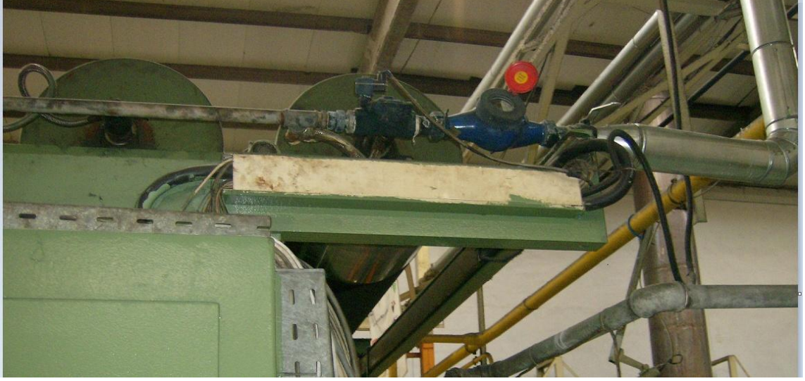
Şekil 5.5 : Su Sayacı Uygulaması
