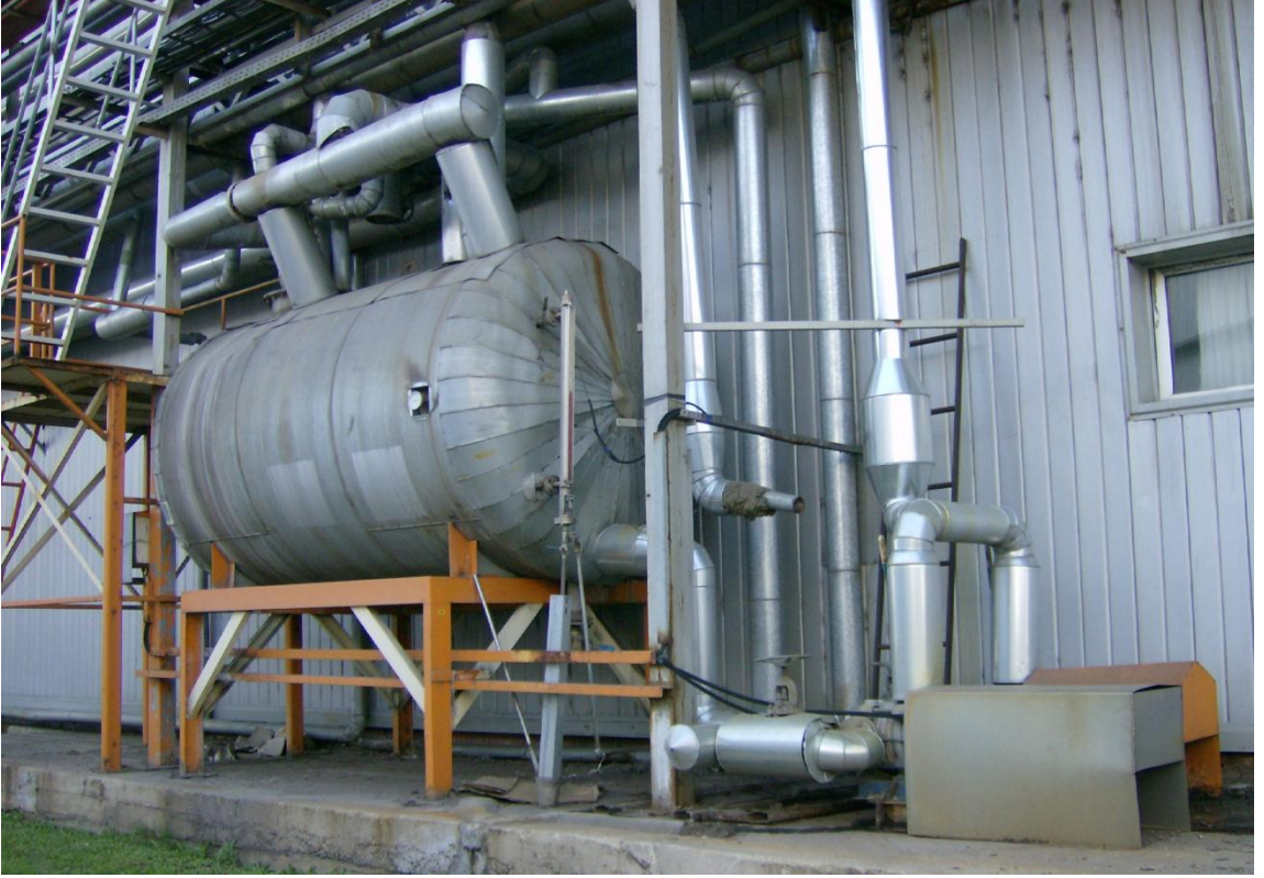
Şekil 5.2 : Ara Kondens Toplama Tankı ve Hatları
