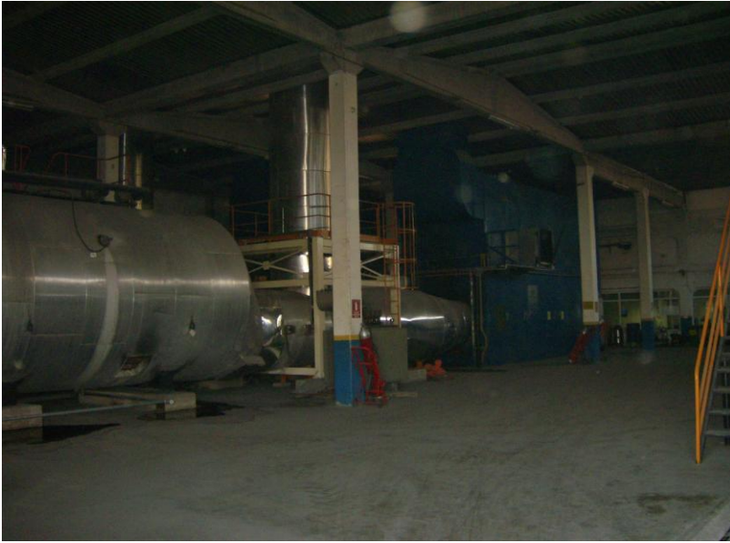
Şekil 5.8 : Kojenerasyon Ekonomizer Tesisi
