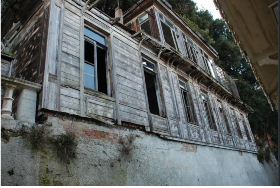
Resim 3.29 Set Köşkü Restorasyon öncesi
