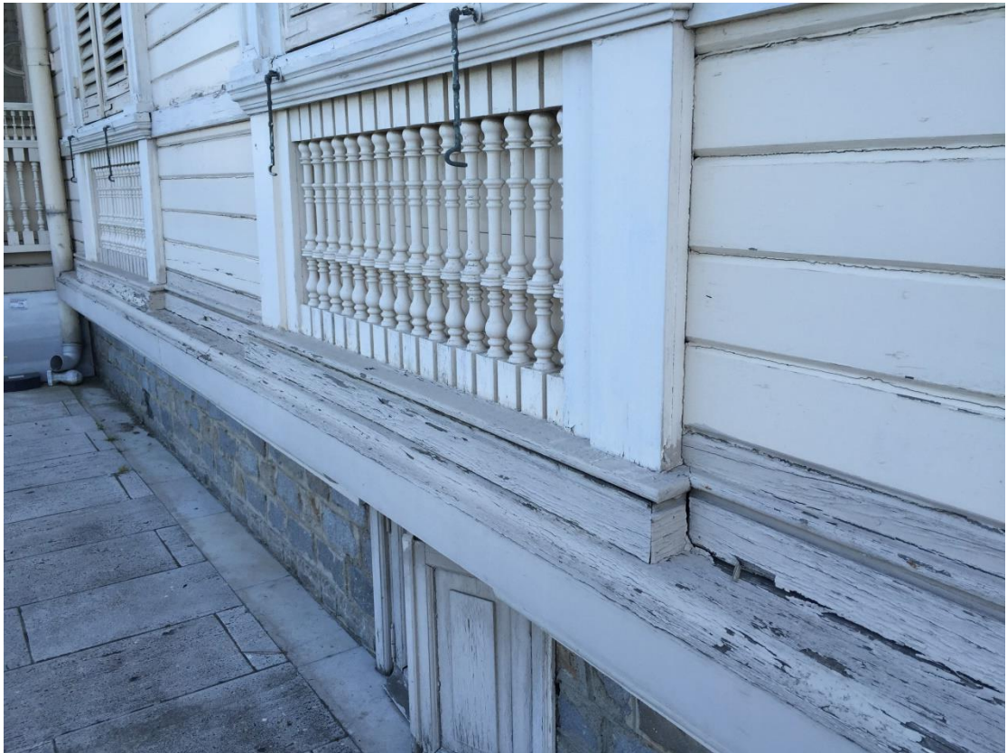
Resim 4.42 Huber köşkü cephe aşınmaları
