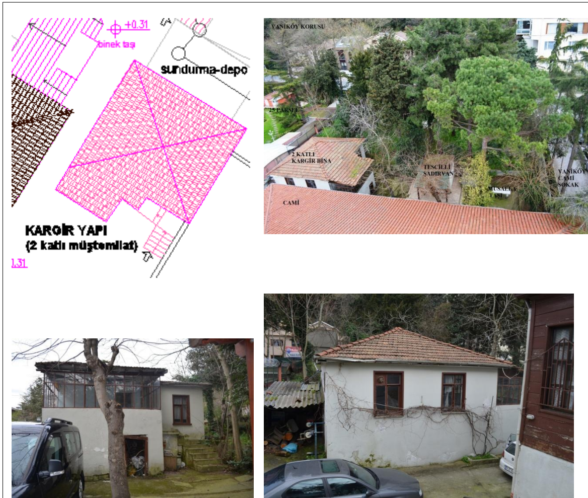
Şekil-13. İki katlı Müştemilat yapısına ait, rölöve kısmi vaziyet planı ve görüntüler.
