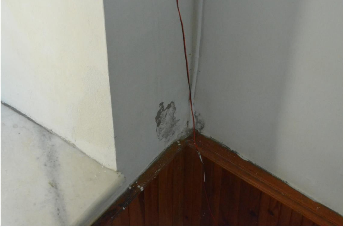
Resim-287. Harim Bölümü güneydoğu-güneybatı duvarı çimento esaslı iç sıvası, pamuklanma ve boya dökülmesi detay görünüşü. 03.04.2015
