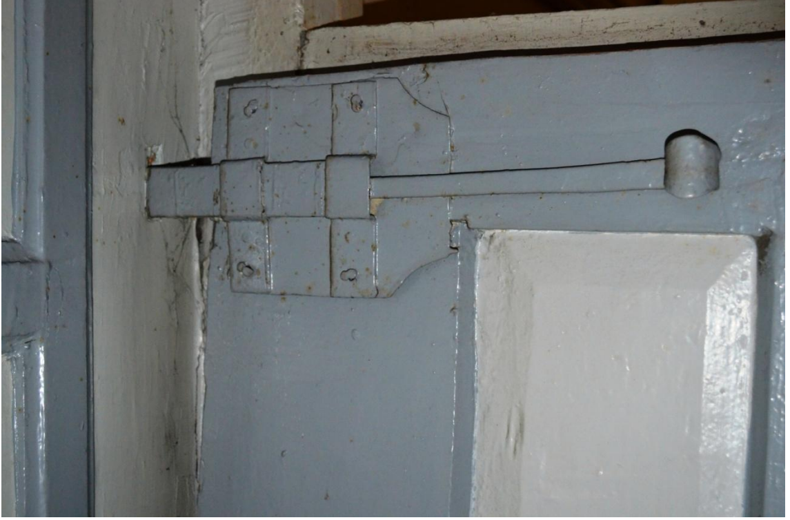
Resim-262. Hünkar Köşkü alt katı depo giriş kapısı kanatları üzerindeki üst kilit sistemi detay görünüşü. 03.04.2015.
