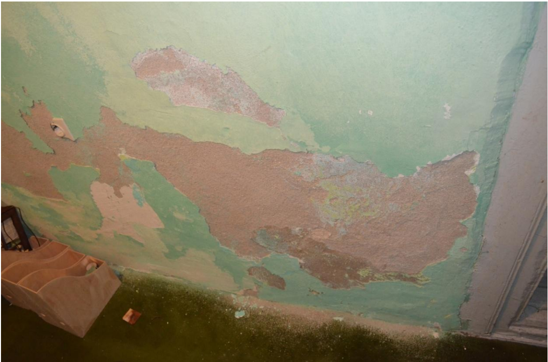
Resim-288. Hünkar Köşkü alt katı depo bölümü duvarı iç yüzeyindeki boya- çimento esaslı sıva dökülmesi ve pamuklanma detay görünüşü. 03.04.2015
