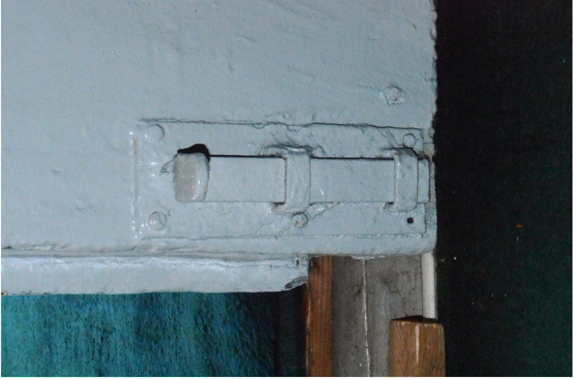
Resim-258. Harim giriş kapısı kanatları üzerindeki alt kilit sistemi detay görünüşü. 03.04.2015.
