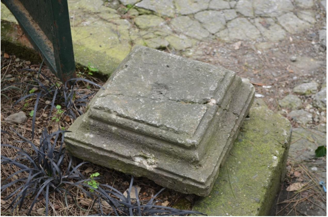
Resim-290. Bahçe giriş kapısı önündeki beton bordürlerin üzerinde yer alan dört adet kesme taş kaideden biri. Hünkar Köşkü önü merdivenlerine ait. 03.04.2015
