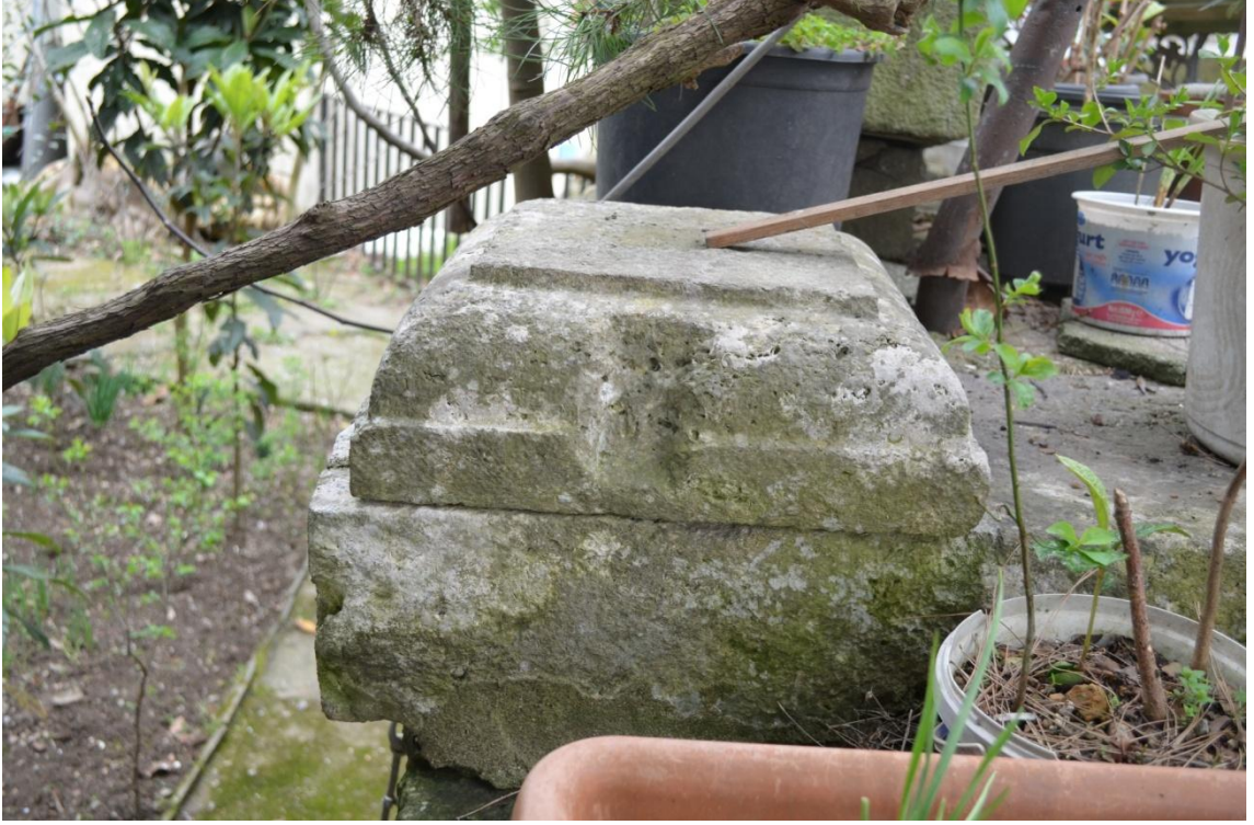
Resim-86. Hünkar Köşkü önü merdiven korkuluklarının bastığı taş kaide... 03.04.2015
