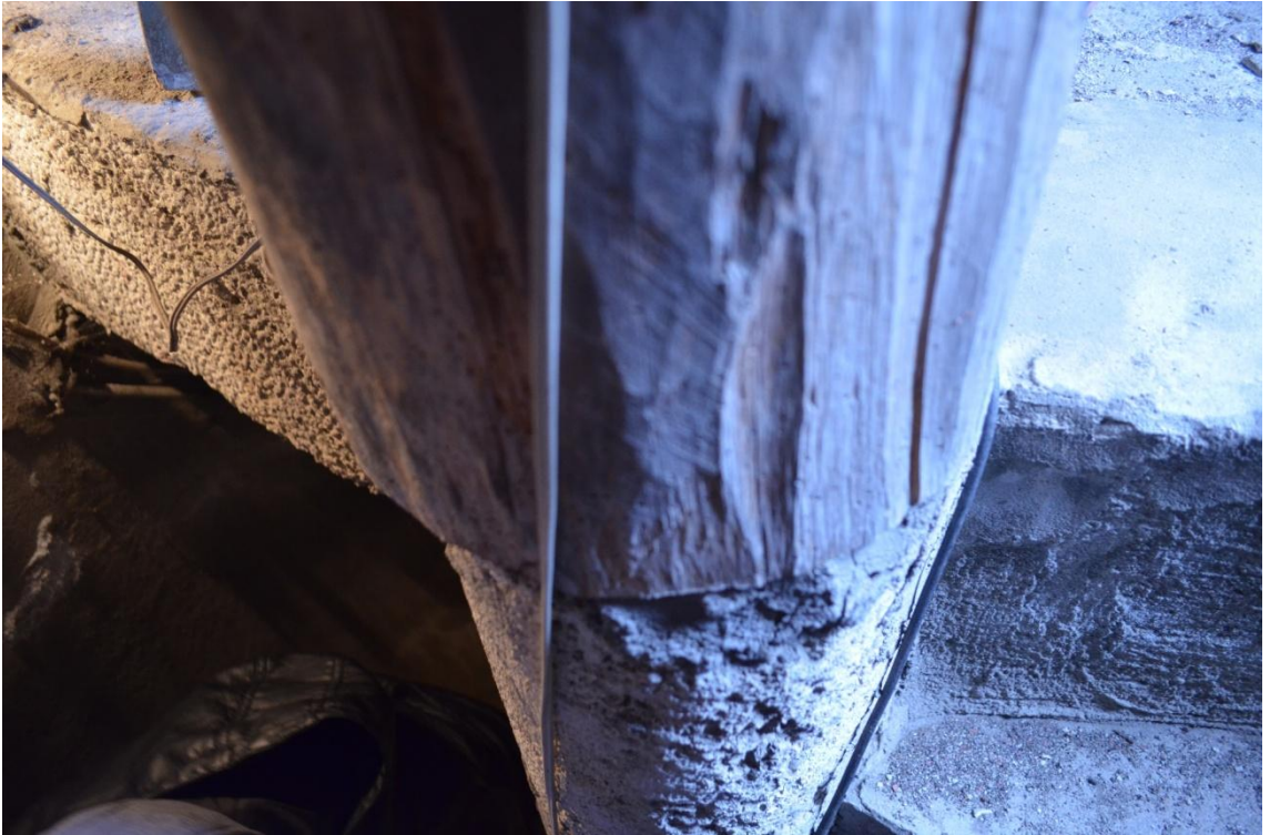
Resim-211. Minare seren tabanı detay görünüşü. 03.04.2015.
