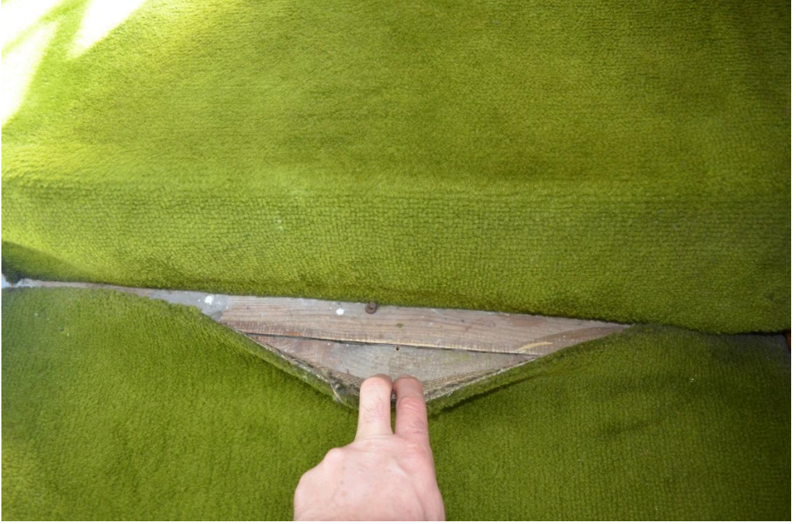
Resim-168. Kadınlar mahfili çıkış merdiveni basamakları ahşap kaplaması üzeri halı örtü. 03.04.2015.
