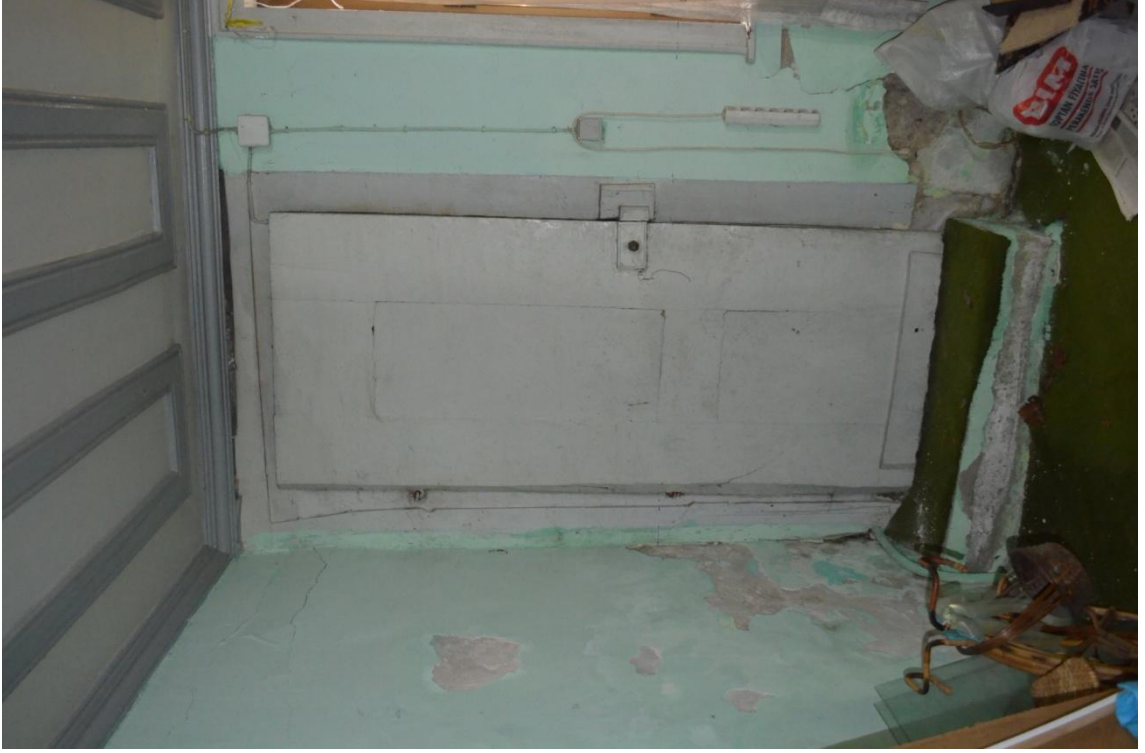
Resim-248. Hünkar köşkü altı depo bölümünün güneydoğu duvarındaki bahçeden giriş kapısının depodan görünüşü. 03.04.2015.
