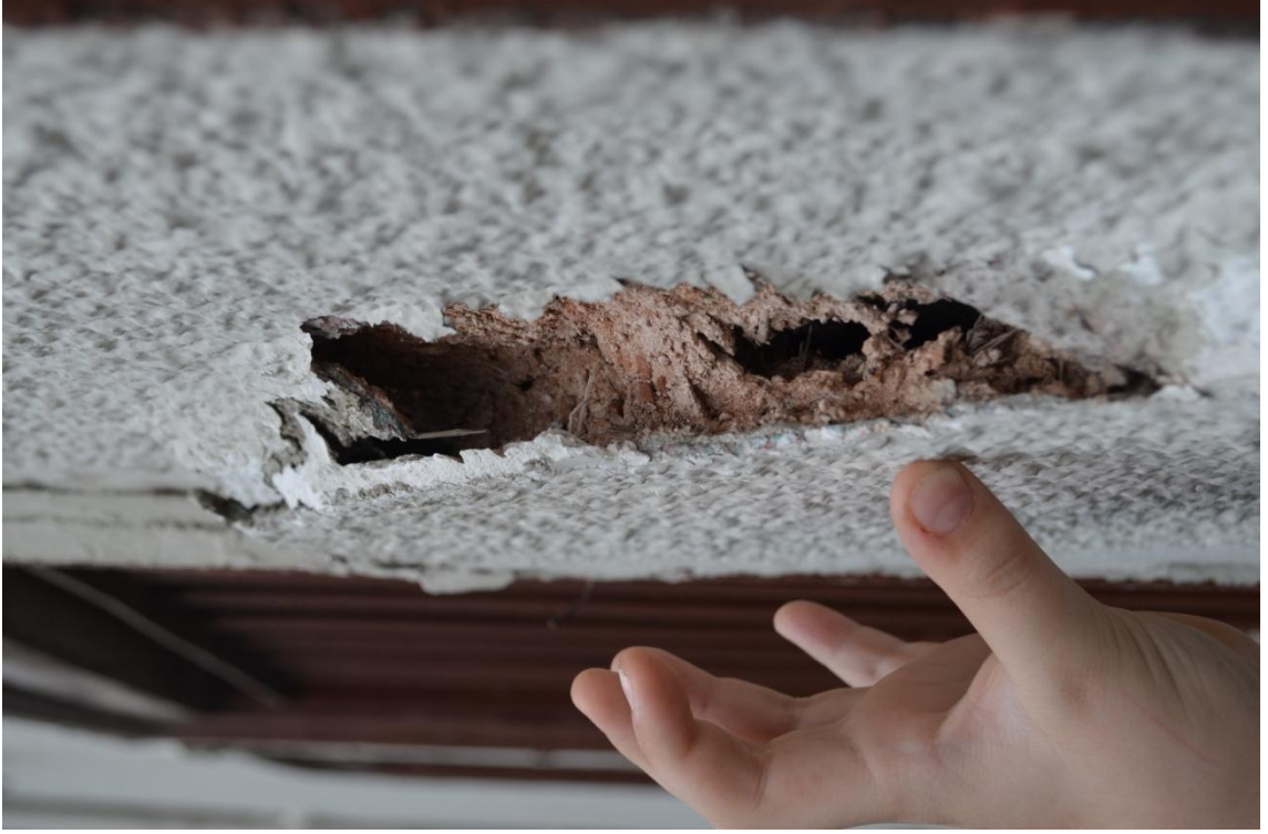
Resim-283. Hünkar Mahfili güneydoğu duvarı çimento esaslı dış sıvası, kireç-horasan katkılı iç sıva ve ahşap duvar konstrüksiyonu detay görünüşü. 03.04.2015
