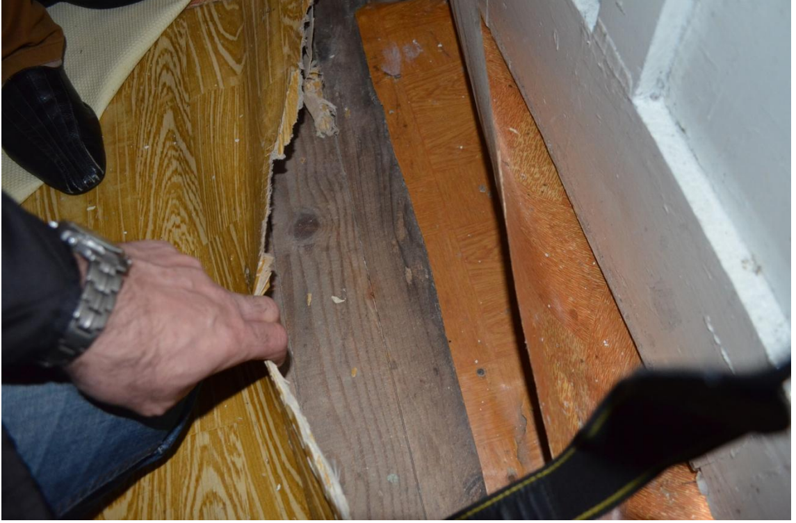
Resim-170. Hünkar köşkü döşeme ahşap kaplaması üzeri muşamba kaplama. 03.04.2015.
