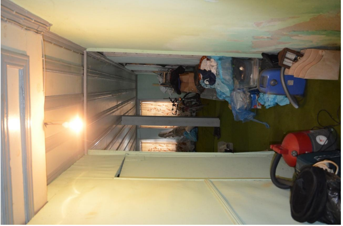
Resim-122. Depoya giriş holünden mekan içi görünüşü. Hünkar Köşkü alt kat. Soldaki niteliksiz sunta bölücü duvar. 03.04.2015.
