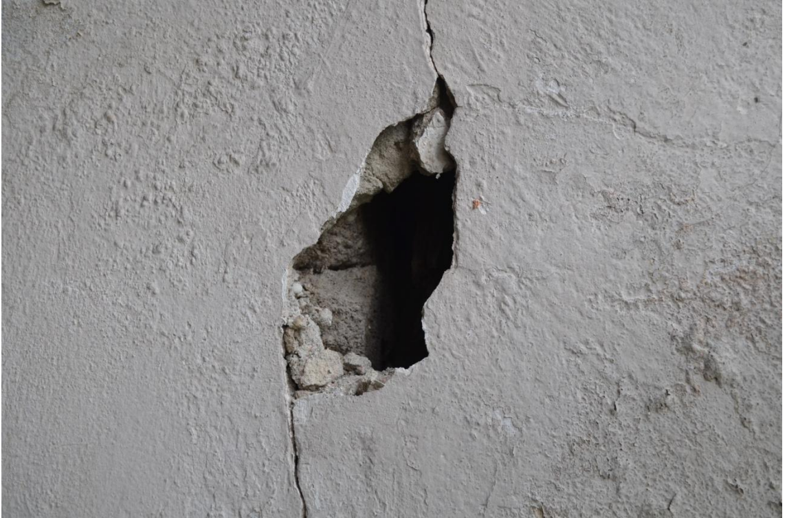
Resim-282. Bahçedeki müştemilat yapısının kuzeybatı duvarı çimento esaslı dış sıvası ve briket örgü duvar konstrüksiyonu detay görünüşü. 03.04.2015
