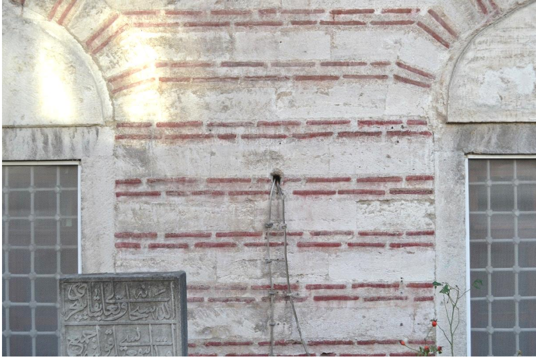
Şekil 168 :Cephede Elektrik Kablolarından Kaynaklı Bozulma (E.Aluç 2014)
