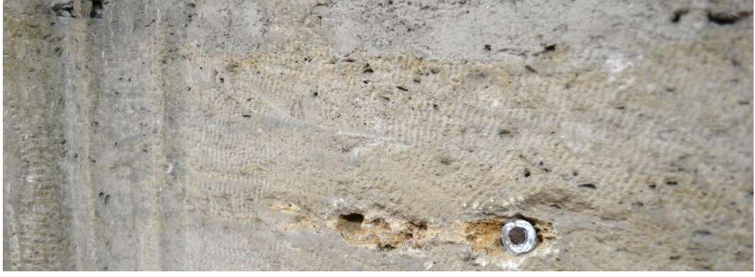
Şekil 169 :Cümle Kapısında Çivi ve Dübelden Sebep Bozulma (E.Aluç 2014)
