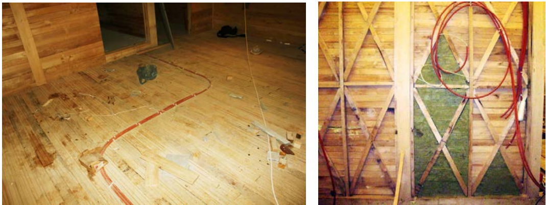
Şekil 5.70: Zemin ve duvar lambrilerinin üzerine döşenen elektrik kabloları.
