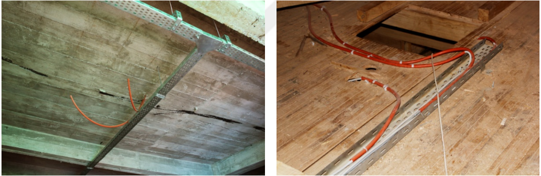
Şekil 5.69: Bodrumun tavanına ve çatı katının zeminine döşenen elektrik kabloları.
