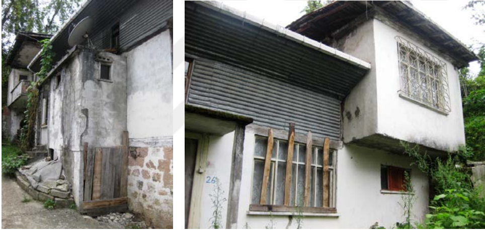
Şekil 5.2: Banyo eklentisi ve arka cephedeki betonarme ek yapı.
