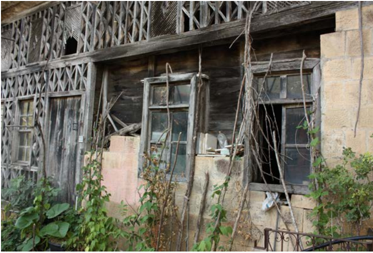
Şekil 4.93: Yapının dökülen aşena taş duvarları.
