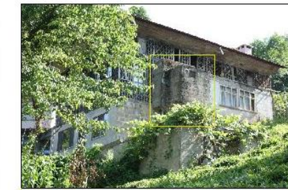
Betonarme-briket banyo ekentisi
