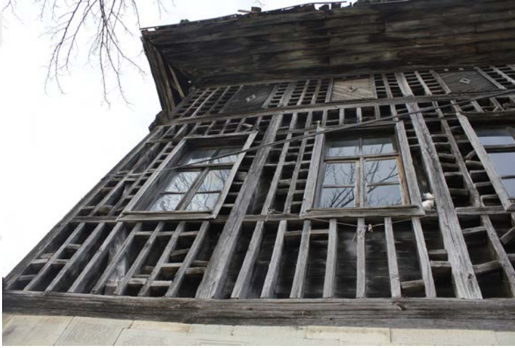
Şekil 4.102: Dolgu malzemesi dökülen ve çıtaları düşen cepheler.
