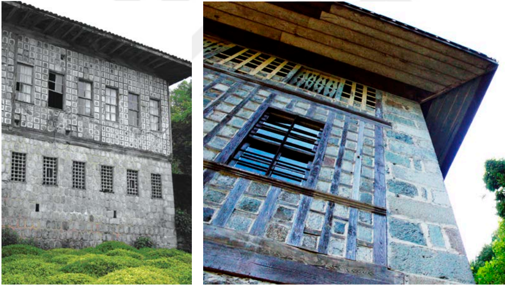
Şekil 3.42: Göz dolma sistem yapım tekniğine sahip konut (Başkan,2008) ve duvar detayı (yazara ait).
