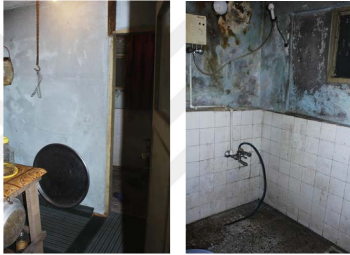
Şekil 5.9: Kiler ve banyo birimlerinin rutubetlenen duvarları.
