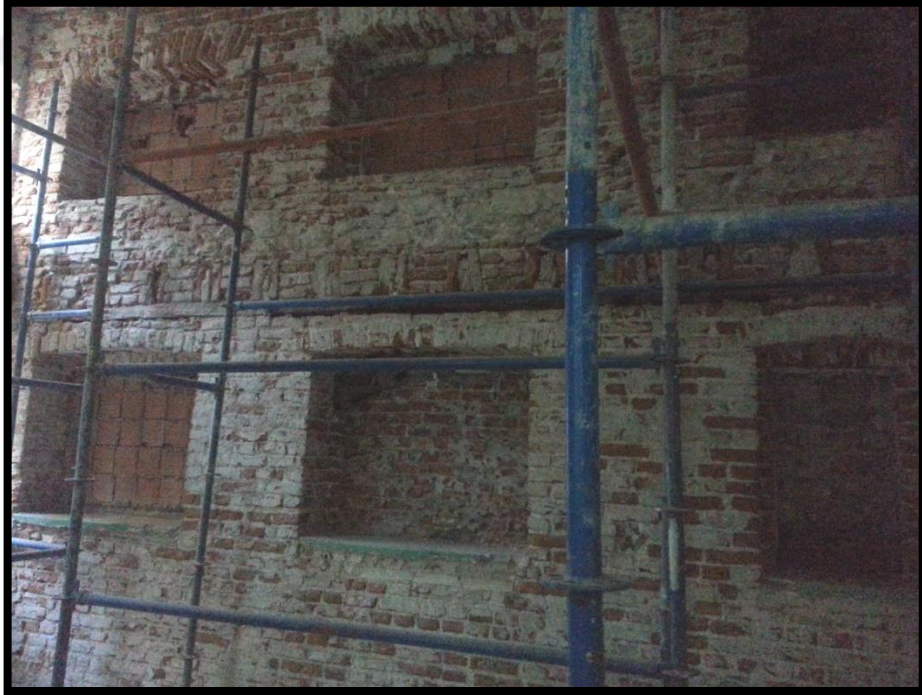
Şekil 3.81: Birinci kat mescit alanı batı duvarında bulunan işlevini yitirerek kapatılan pencere boşlukları
