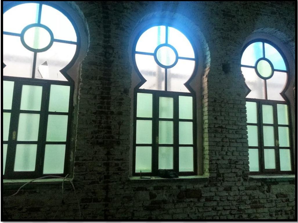
Şekil 3.74: Birinci kat mescit alan at nalı kemerli pencerelerin arasında tesisat nedeniyle oluşan tuğla duvardaki kütle kaybı.
