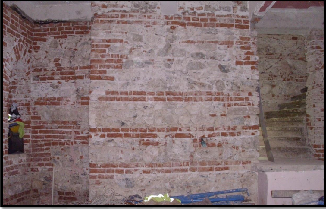
Şekil 3.61: Minare kaidesi yanı tuğla duvarda üst kısımda oluşmuş çatlak.
