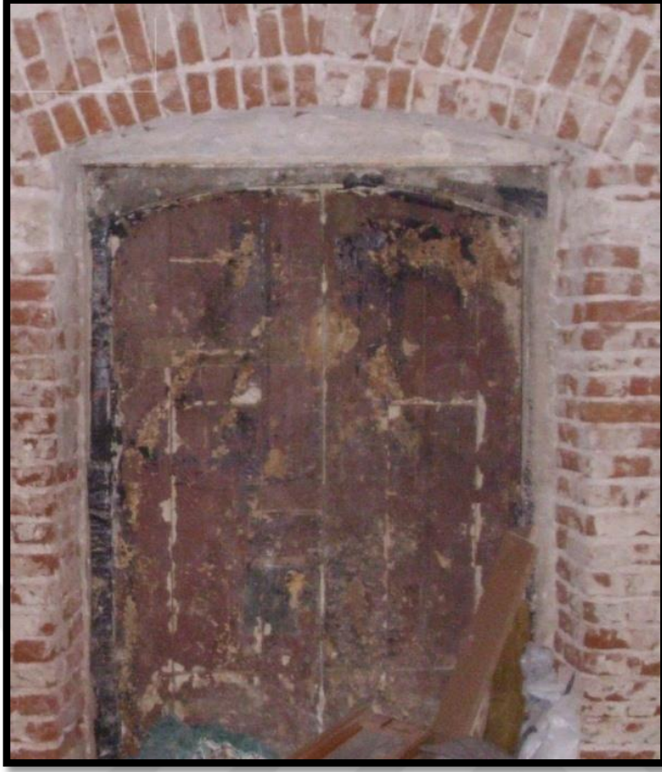
Şekil 3.92: Güney cephede bulunan kullanılmayan kapıda oluşan deęişim ve bozulmalar.
