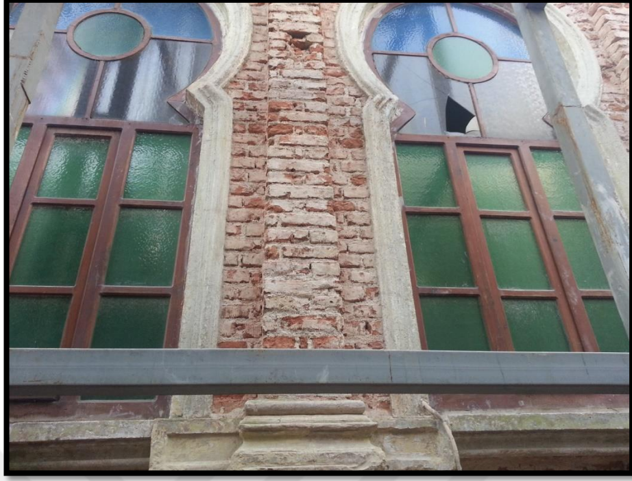
Şekil 3.82: Doğu cephesinde bulunan sütunçe üzerinde doğal nedenlerle dolayı kütle kaybı.
