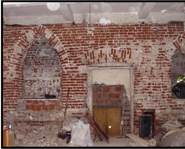
Şekil 3.79: Zemin kat son cemaat alanı batı duvarında bulunan işlevini yitirerek kapatılan pencere ve kapı boşlukları.
