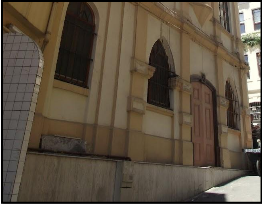
Şekil 3.71: Güney cephesinde bulunan yuvarlak kemerli ve sivri kemerli pencerelere sonradan eklenmiş demir parmaklıklar.
