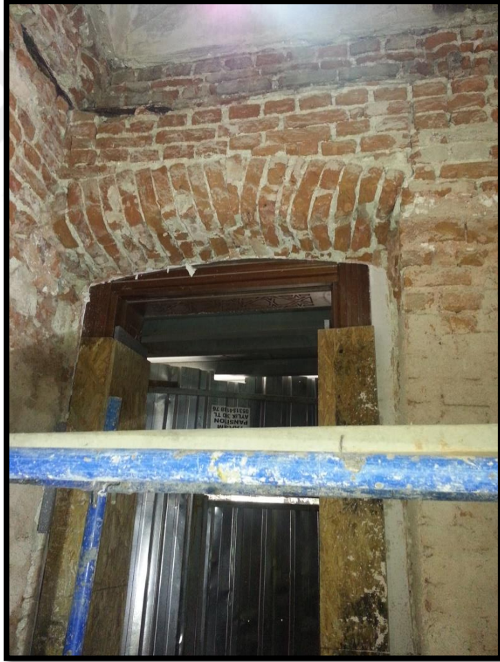
Şekil 3.64: Doğu cephesi giriş kapısı üst köşede oluşan çatlak.
