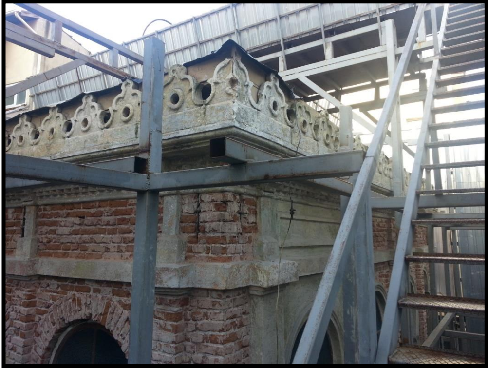
Şekil 3.87: Taç alınlıkta oluşan renk değişimleri ve dökülmeler.
