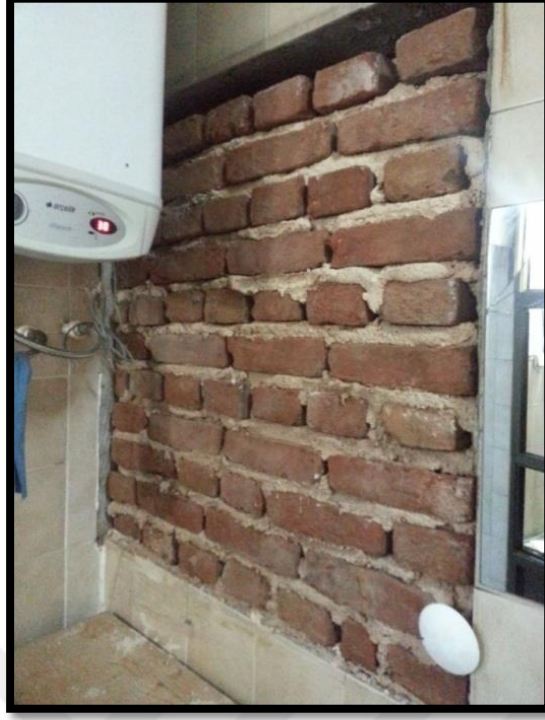
Şekil 3.80: Zemin kat son cemaat alanı batı duvarında bulunan işlevini yitirerek kapatılan kapı boşluğunun şadırvan tarafından görünüşü.
