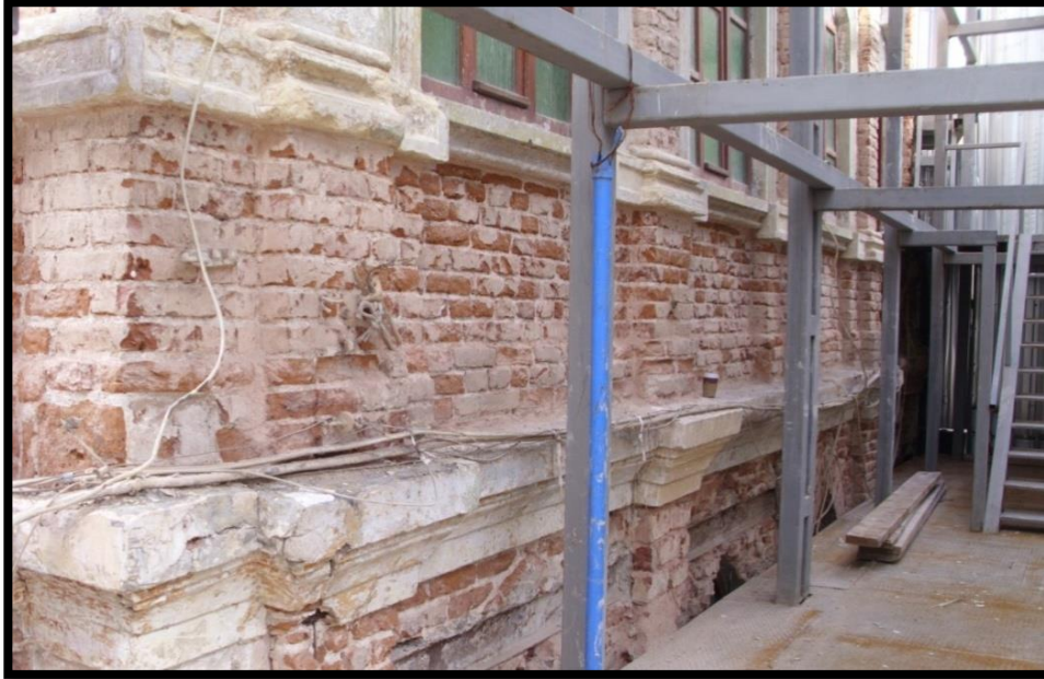
Şekil 3.85: Doğu cephesinde bulunan kat silmesinde oluşan kütle kayıpları ve renk değişimleri.
