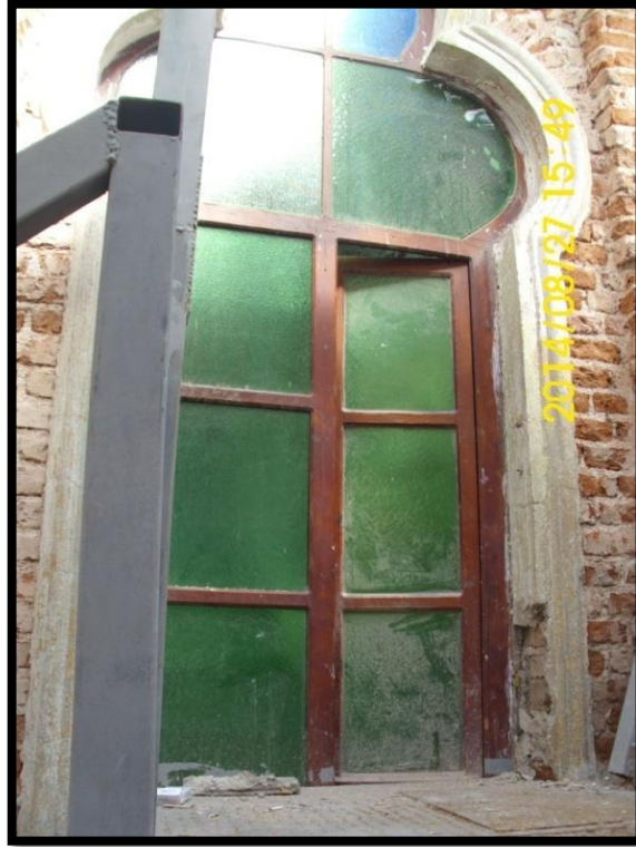
Şekil 3.83: Doğu cephesinde yonca kemerli pencerenin sövelerinde dökülmeler.
