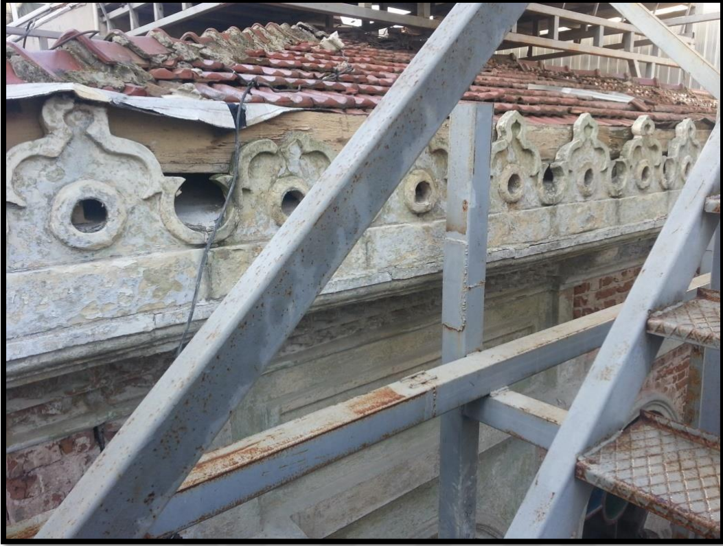
Şekil 3.88: Taç alınlıkta oluşan renk değişimleri ve dökülmeler.
