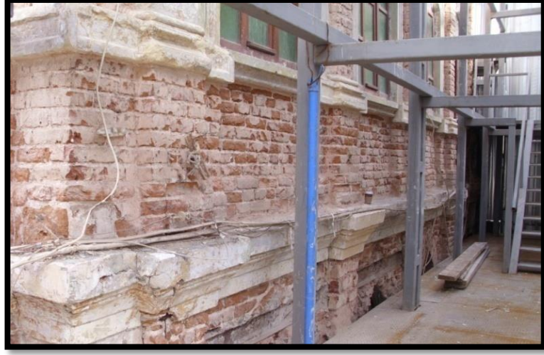
Şekil 3.63: Doğu cephesinde bulunan Kat silmesi ve altındaki tuğla duvarda bulunan yapısal çatlak.
