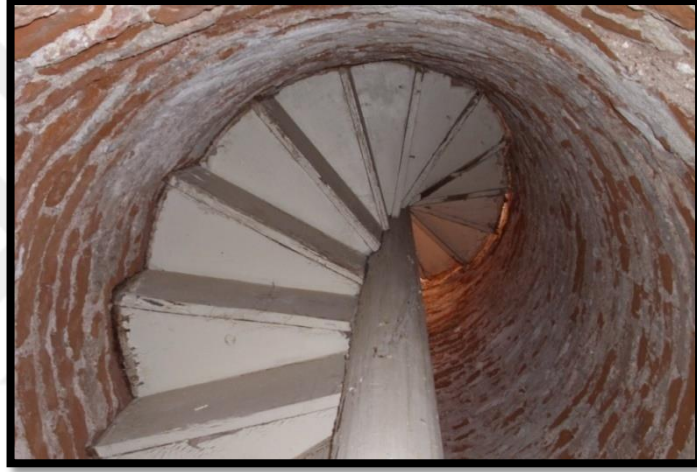
Şekil 3.95: Minare merdivenlerinde oluşan çürümeler.
