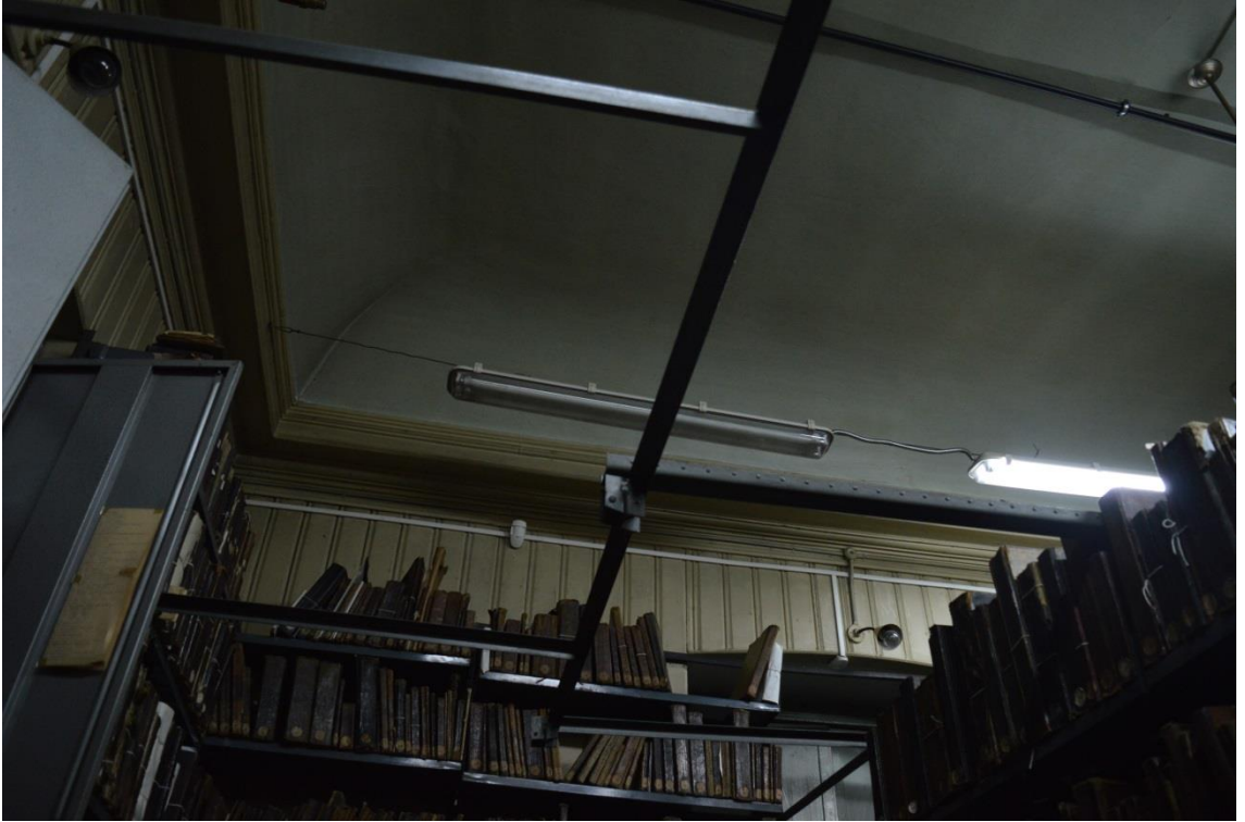
Resim 92: Depo Aydınlatma Sistemi(2016)
