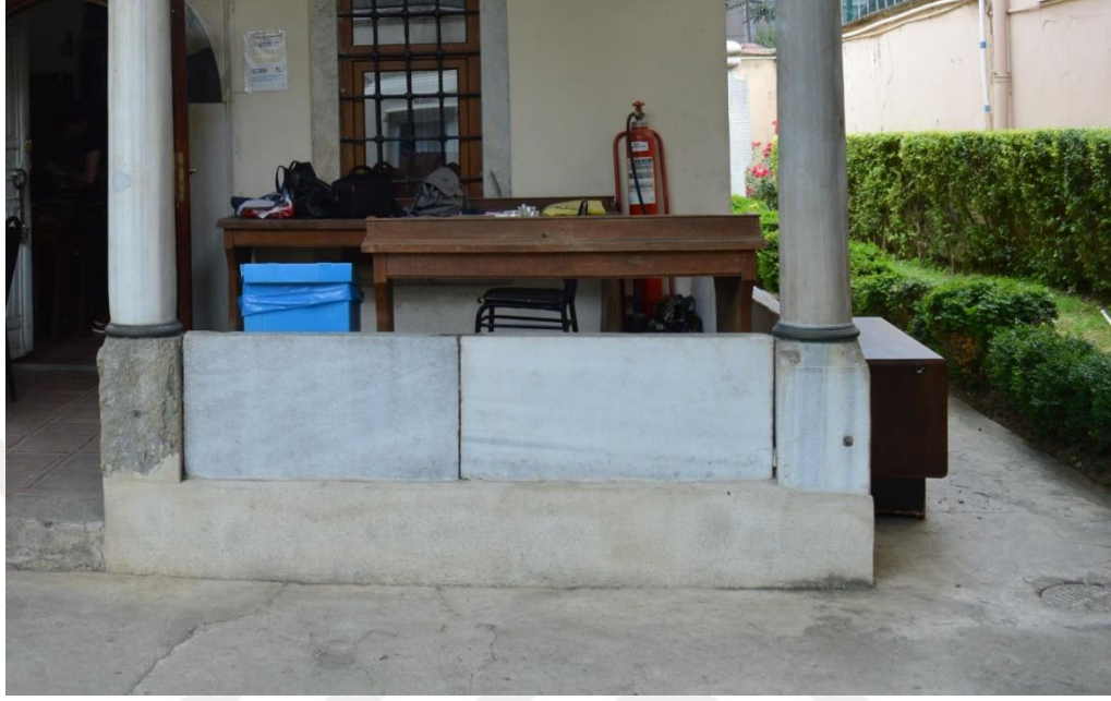
Resim 105: Revaklı girişteki sütun ve kaidelerdeki bozulmalar.(2016)
