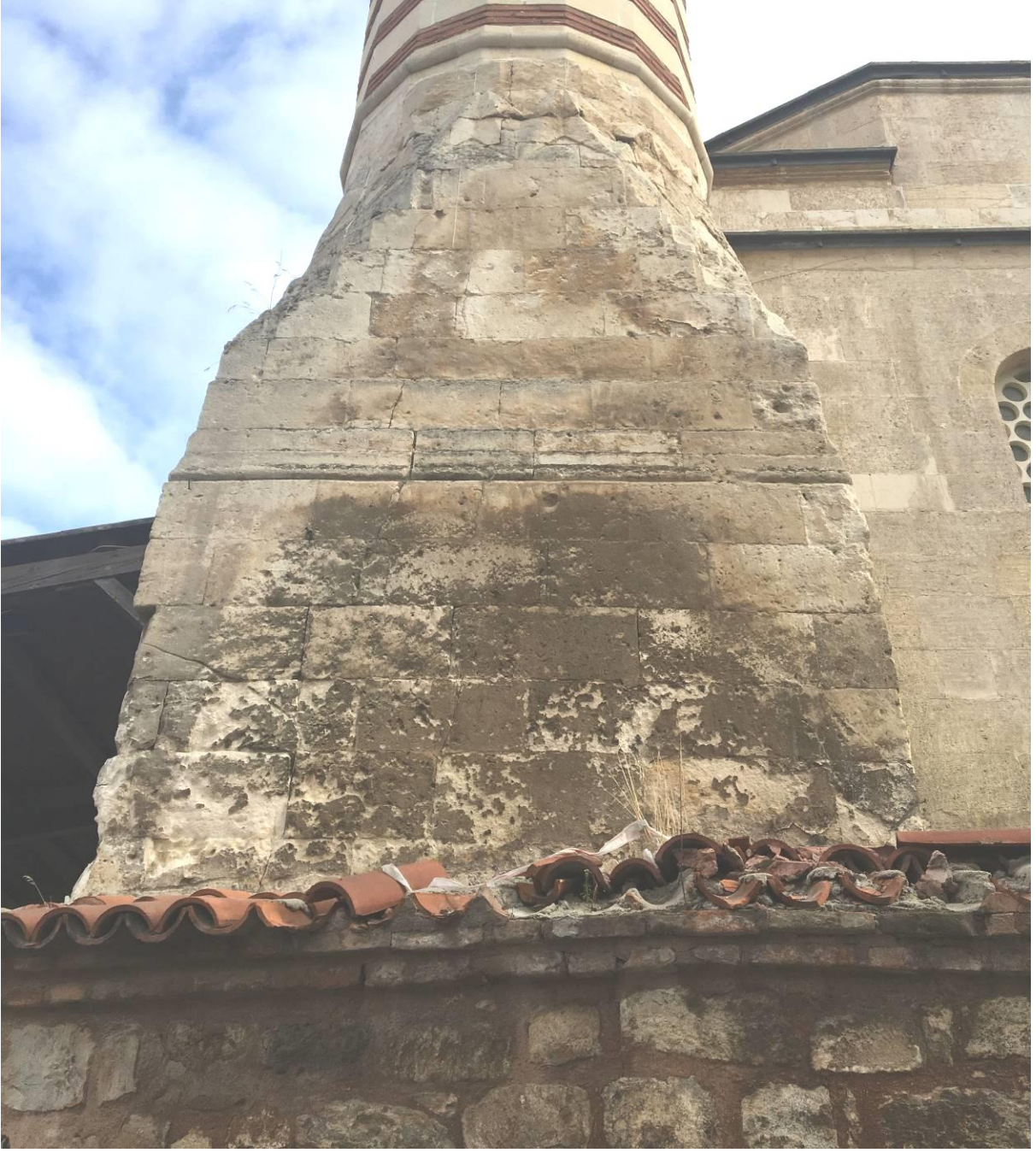
Şekil 117 : Minare Kaidesindeki Yüzey Erozyonları (İ. Ceran, 2016)
