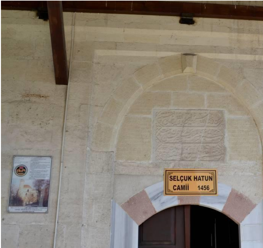
Şekil 121 : Cephede Klima, Kablo ve Tabelalar ile Bozulmalar (İ.Ceran 2016)
