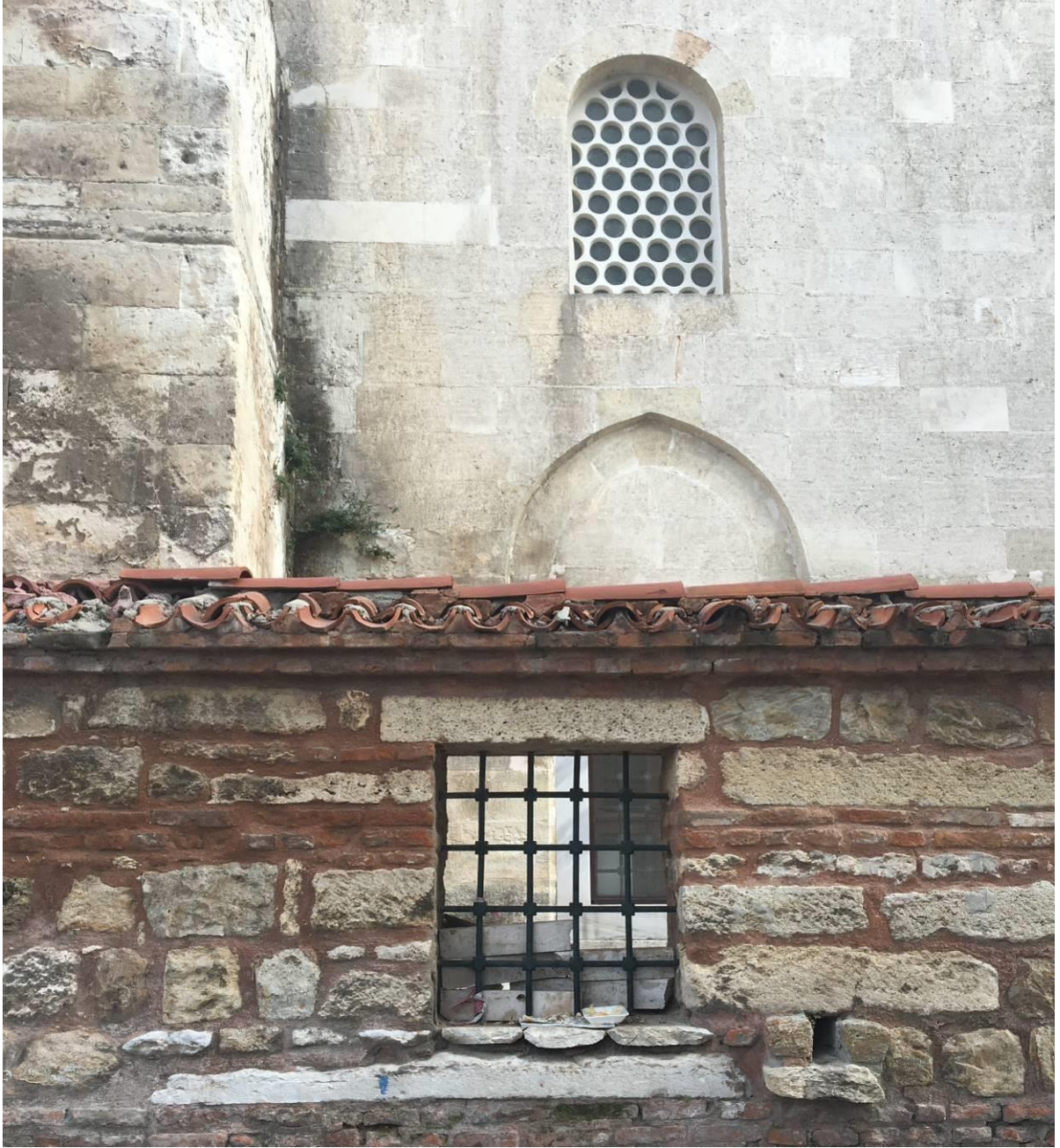
Şekil 123 : Minare Köşesindeki Bitki Oluşumu ve Kararmalar(İ.Ceran,2016)
