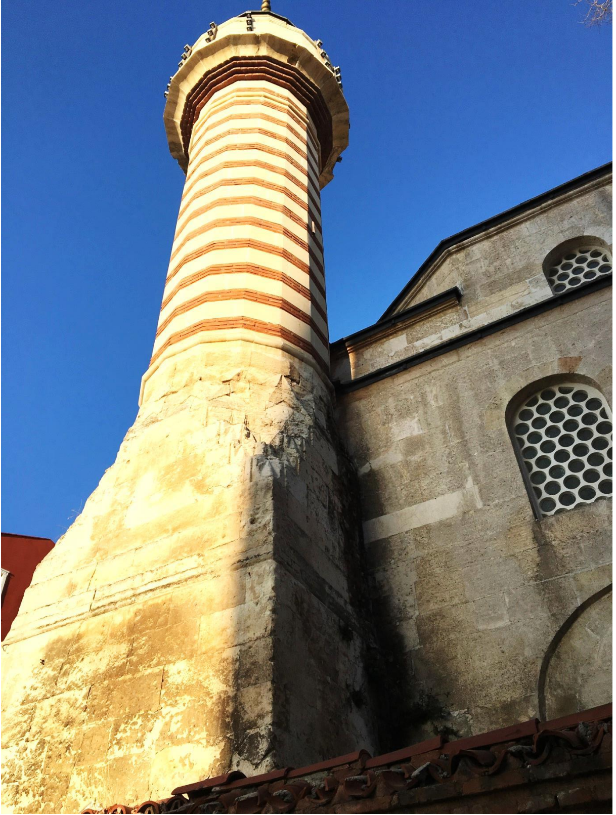
Şekil 126 : Minarede Görülen Bitki Oluşumları ve Karamalar (İ.Ceran,2016)
