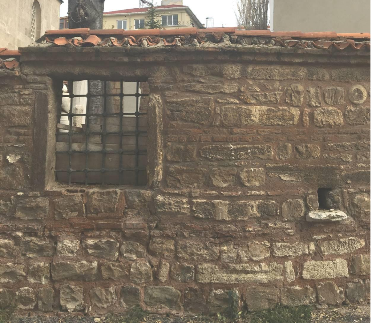
Şekil 118 : İhata Duvarı Çatlaklar ve Parça Kopmaları (İ. Ceran,2016)
