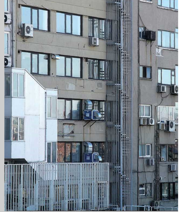
Dağınık, Estetik Olmayan, Servis Vermenin Zor Olduğu Mini Split Dış Ünite Yerleşimi
