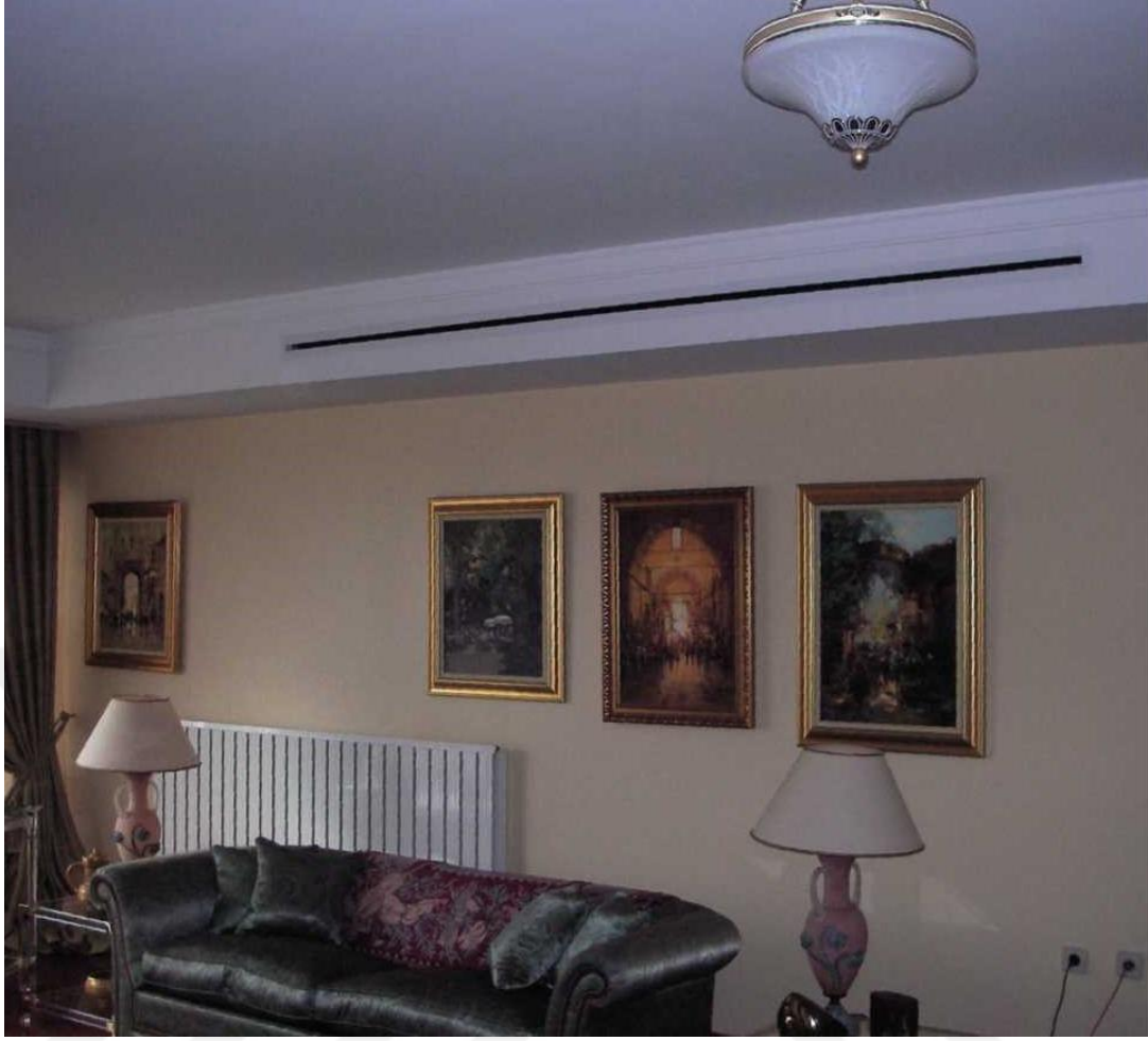
Şekil 4.13: Hava Kanallı Sistemin İç Mimariye Olan Etkisi Şekil 4.12’de Gösterilen Mimari Plandaki Salon Uygulaması Slot Difüzör Trio Konutları (Anonim, 2007).
