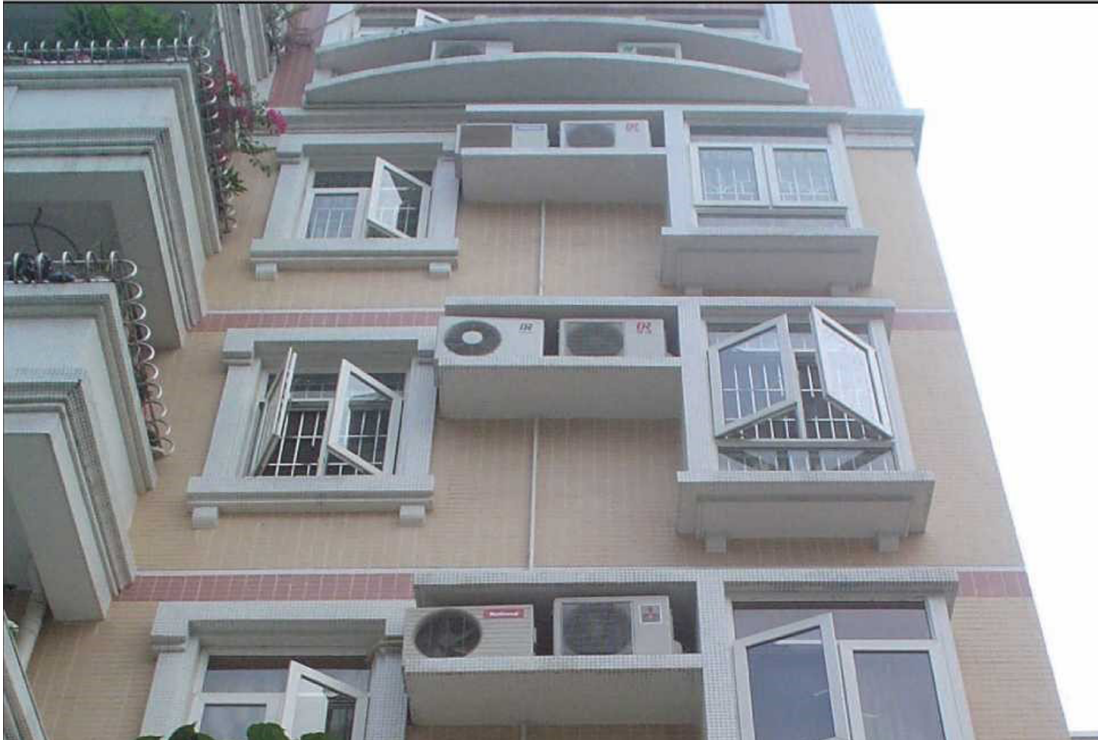
Düzenli, Estetik, Dış Üniteler Arasında Yeterli Servis Açıklığı Olmadığından Servis Vermenin Zor Olduğu Mini Split Dış Ünite Yerleşimi
