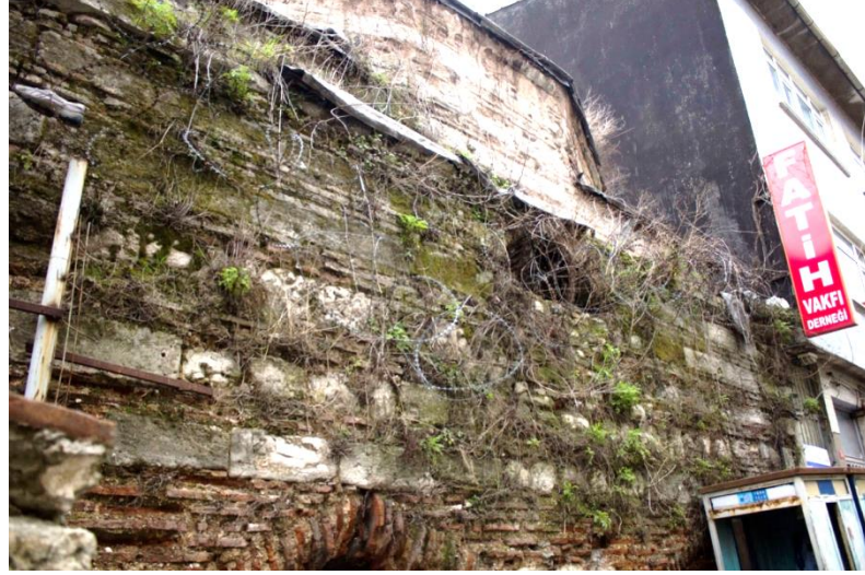
Şekil 90. Dershanenin batı cephesi - bitkilenme, taş kaybolması, siyah kabuk oluşumu, uygun olmayan ekler ve kurşun hasarı
