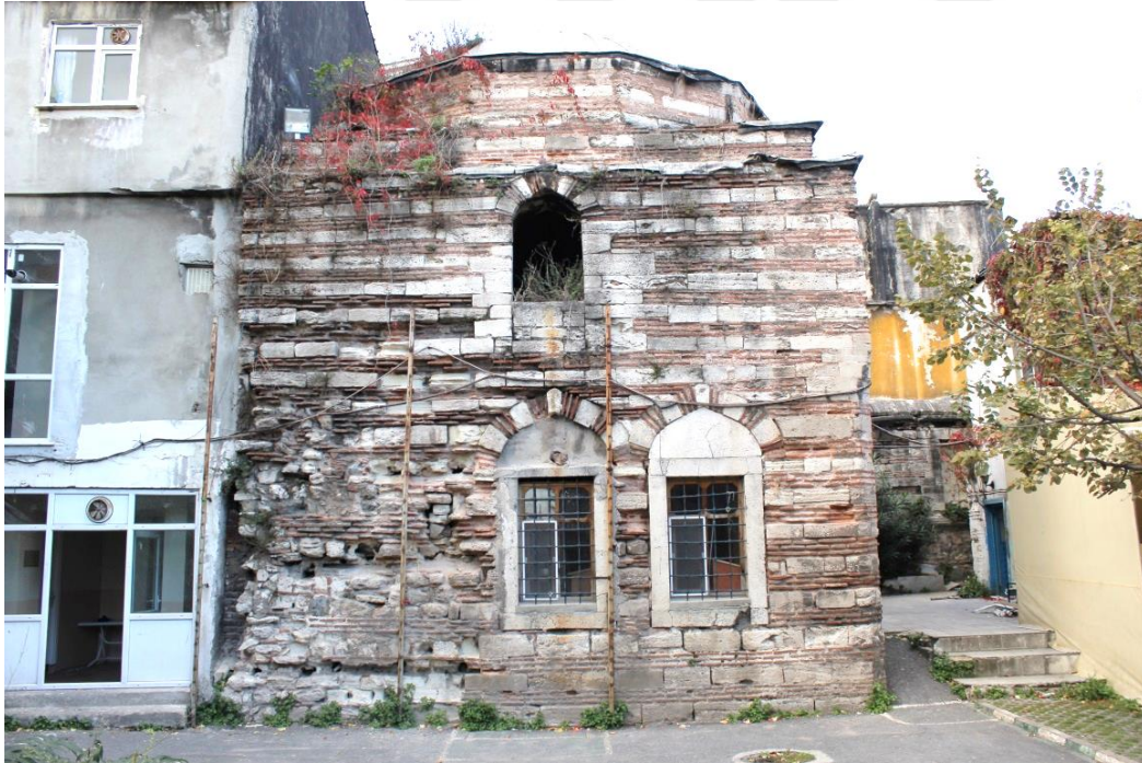
Şekil 89. Dershanenin doğu cephesi-kopma, köşe formu kaybolmuş-derzler boşalmıştır (Masri, 2017)
