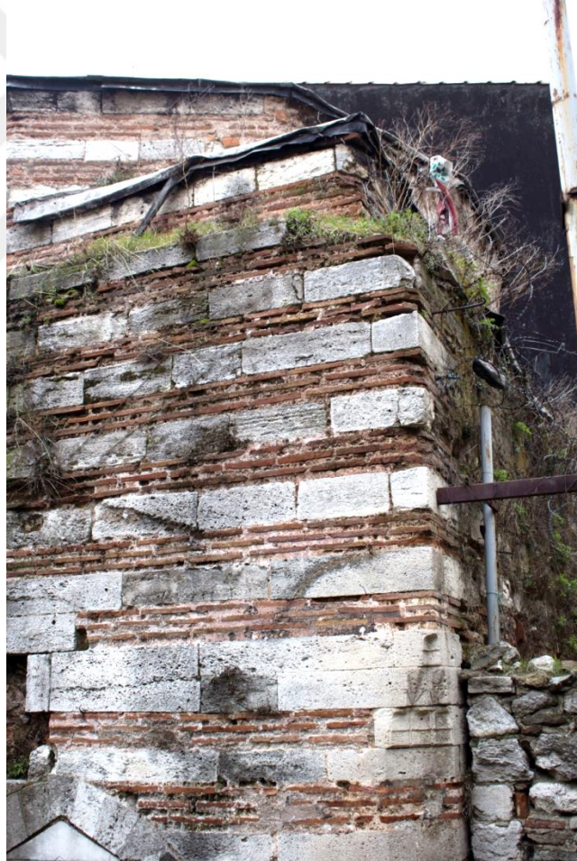
Şekil 91. Dershanenin kuzeybatı köşesi- ekler, bitkilenme, taş kaybolması, siyah kabuk ve kurşun hasarı
