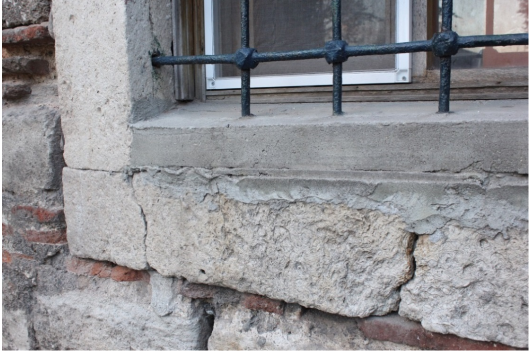
Şekil 87. Dershanenin doğu cephesi – pencere sövesinde çatlaklar görülmektedir (Masri, 2017)
