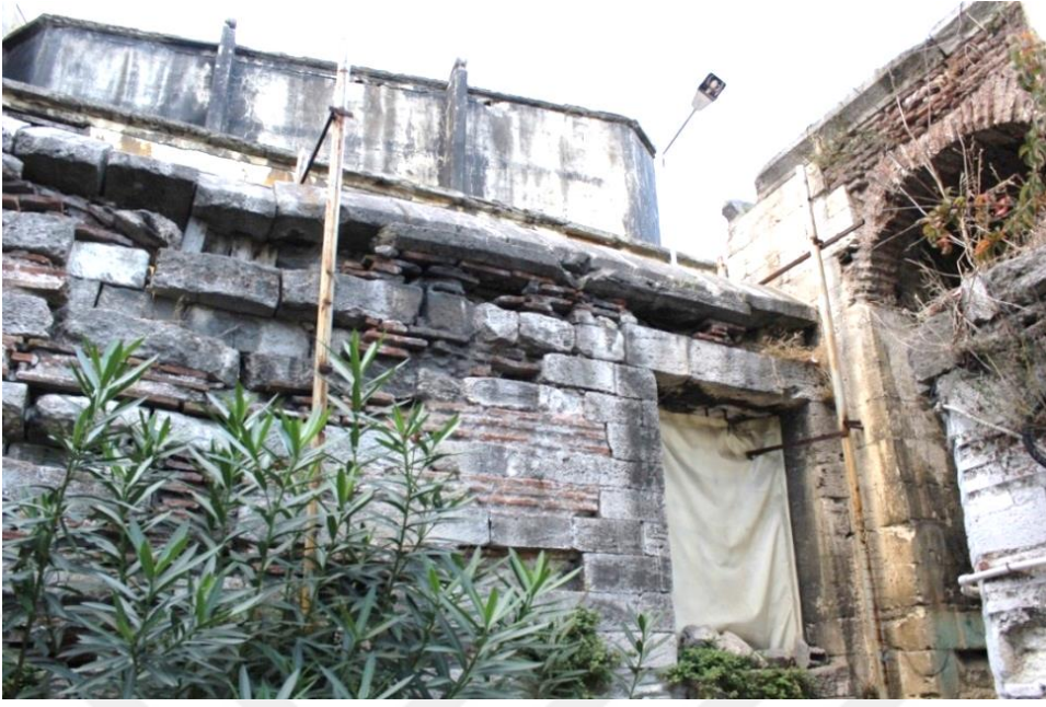
Şekil 95. İçeriden giriş duvarı – ekler, bitkilenme, taş kaybolması ve siyah kabuk oluşumu (Masri, 2017)
