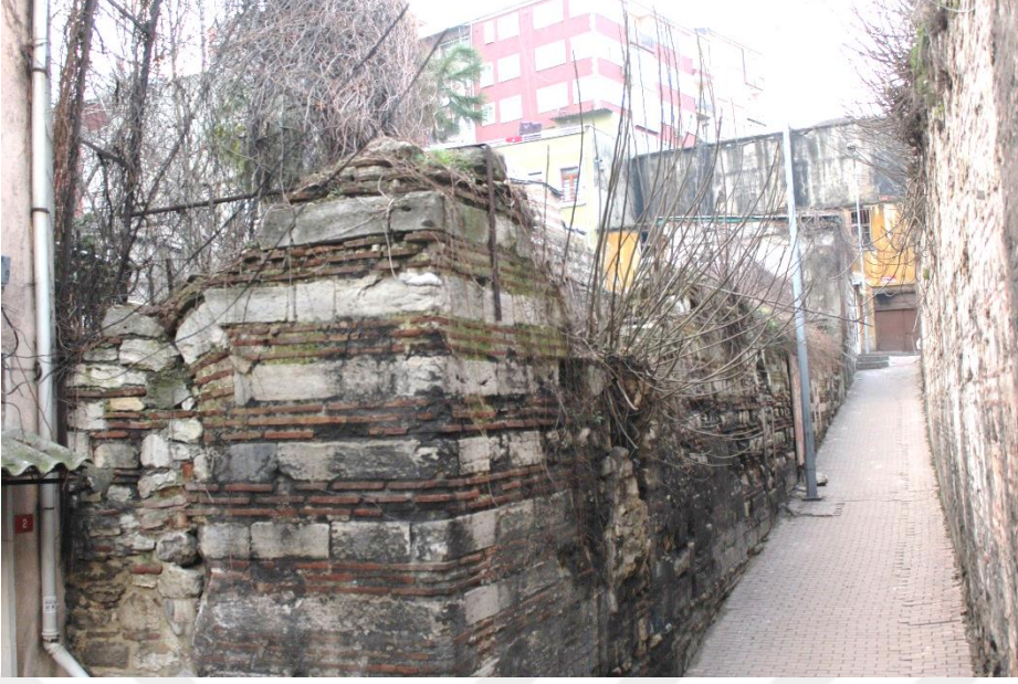
Şekil 85. Medresenin kuzey duvarı – bitkilenme, taş kaybolması, siyah kabuk oluşumu, uygun olmayan ekler ve yıkılma
