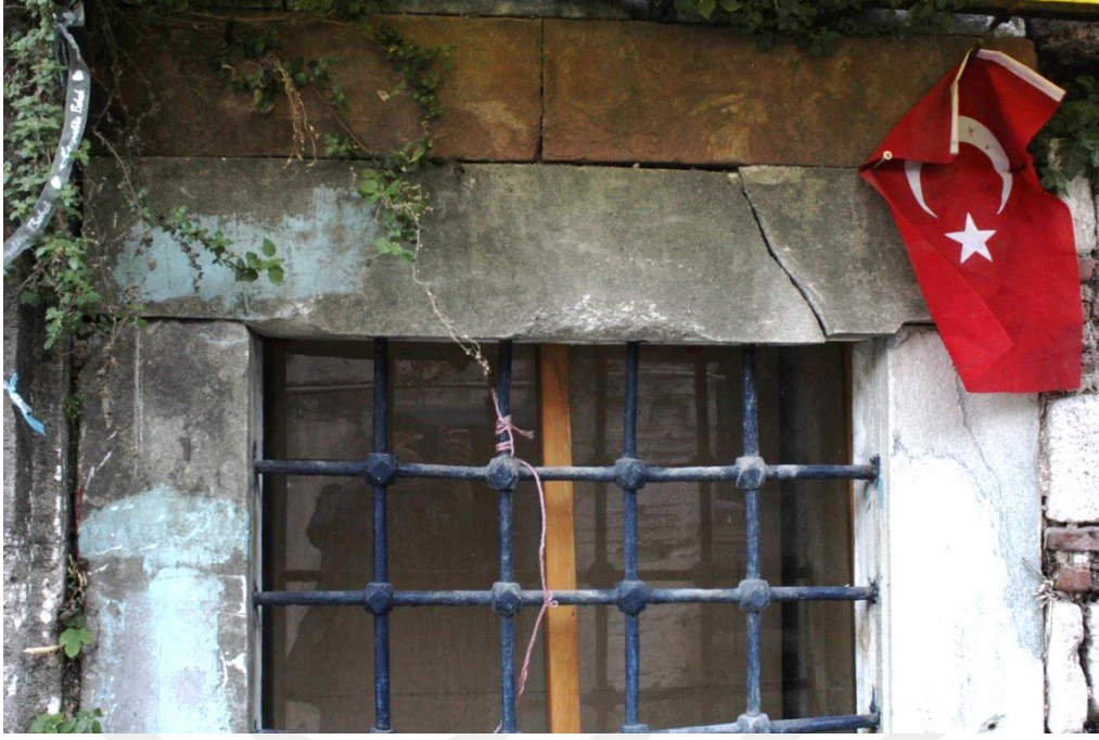
Şekil 88. Dershanenin kuzey cephesi – pencere sövesinde çatlak görülmektedir (Masri, 2017)
