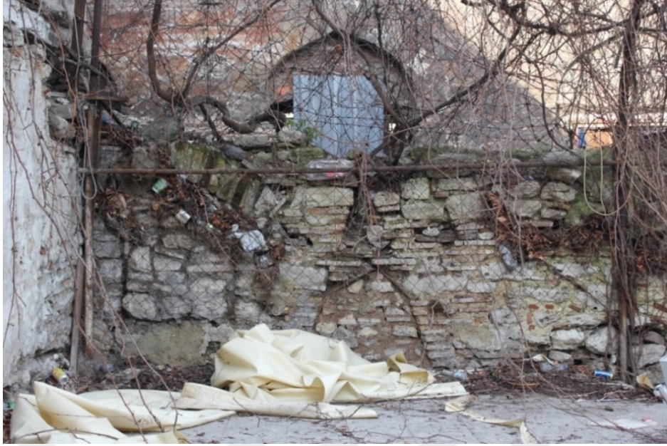
Şekil 93. Avlunun kuzey duvarı - bitkilenme, taş kaybolması, siyah kabuk oluşumu, ekler ve çimentolu harç kullanılması
