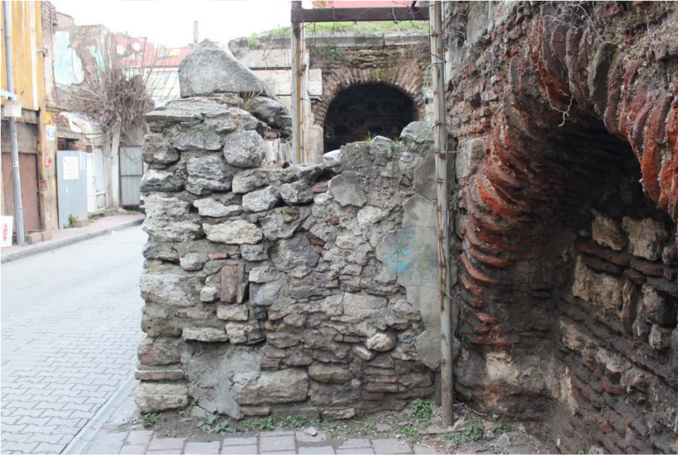
Şekil 96. Giriş duvarı – bitkilenme, taş kaybolması, çimento eklenmesi ve siyah kabuk oluşumu (Masri, 2017)
