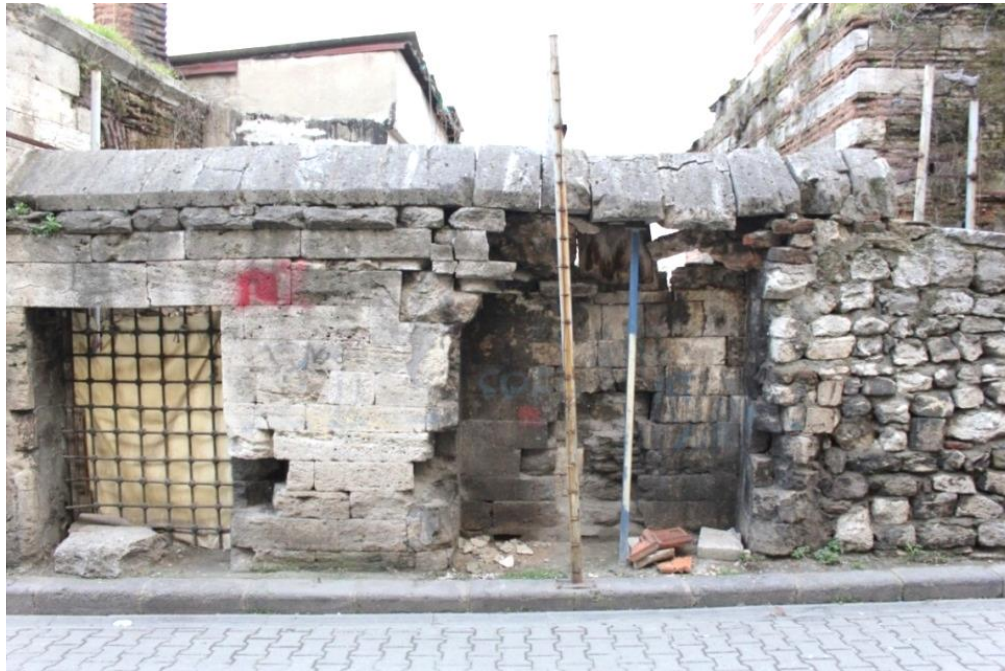
Şekil 94. Giriş duvarı – bitkilenme, taş kaybolması, siyah kabuk oluşumu, ekler ve yıkılma hasarı görülmektedir
