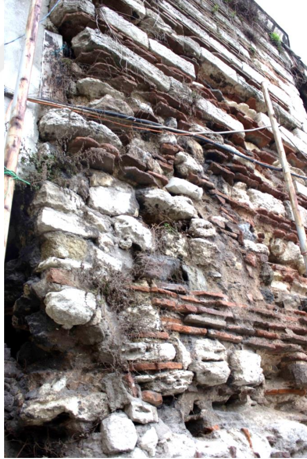
Şekil 86. Dershanenin doğu cephesi – strüktürel hasar; taş kaybolması ve derzlerin boşalması
