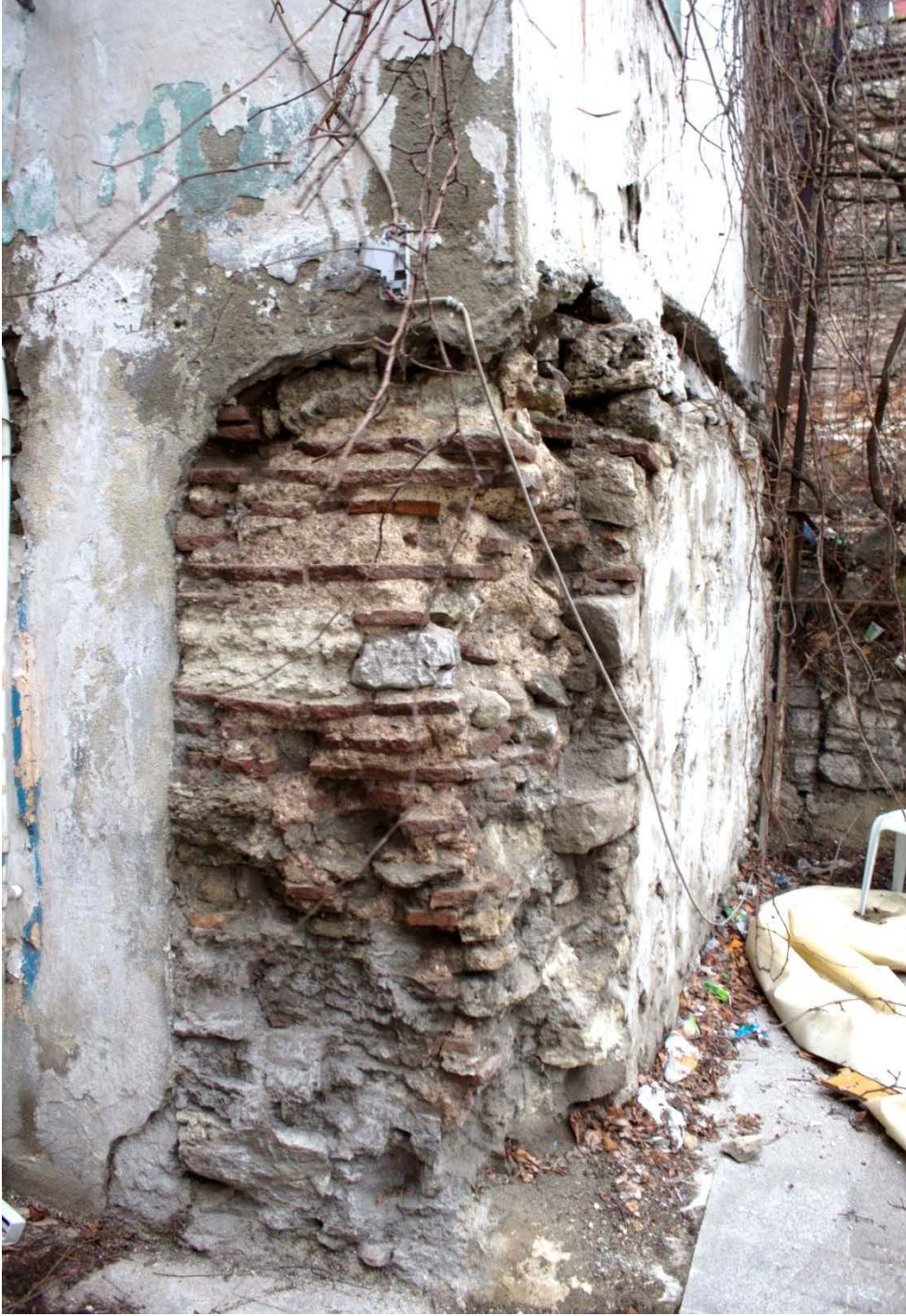
Şekil 99. Girişteki oda – taş kaybolması ve derz boşalması hasarı (Masri, 2017)
