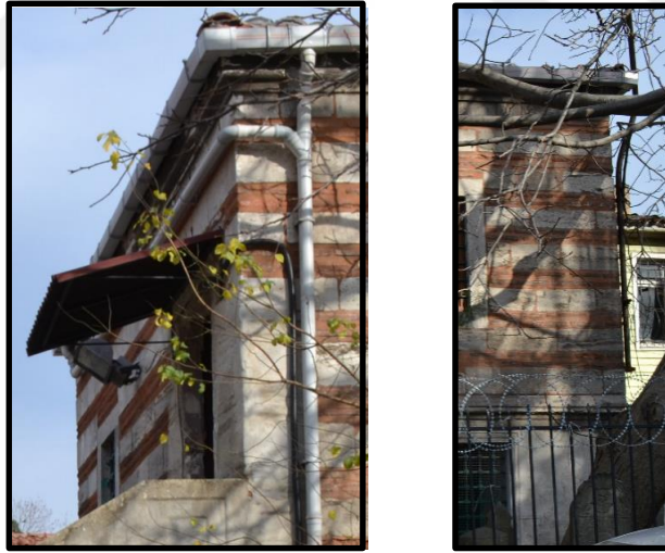
Şekil 5.150: 54 Parsel Yapı Yüzeyinde Yer Alan Muhdes Elemanlar (Keskin, T. 2018).
