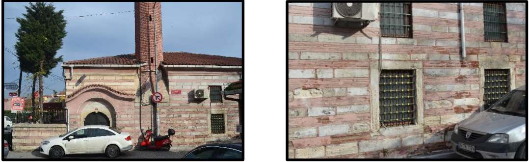
Şekil 5.146: 53 parsel Cephe Yüzeyinde Görülen Bozulmalar (Keskin, T. 2018).
