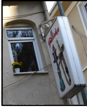
Şekil 5.162: 1. Normal Kat Pencere Kemerinde Oluşan Bozulma ve Yapı Yüzeyindeki Muhdes Elemanlar.
