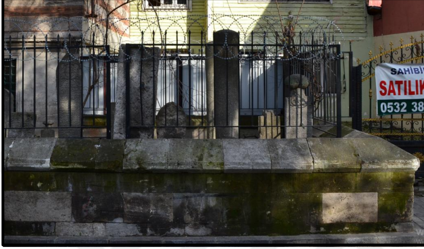
Şekil 5.151: 52 Parsel Hazire ve Taş Duvarda Yer Alan Bozulmalar (Keskin, T. 2018).
