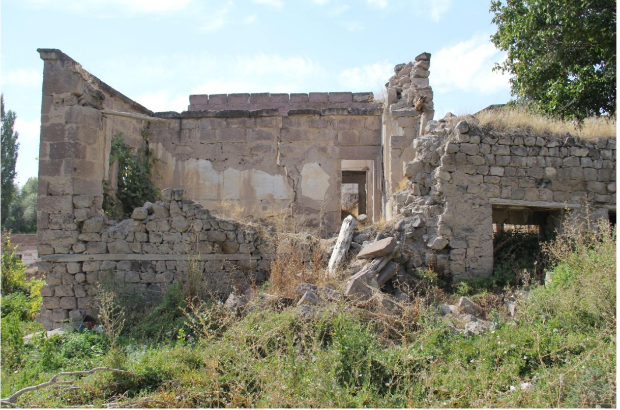
Şekil 150. Doğu duvarı ve bitki oluşumları
