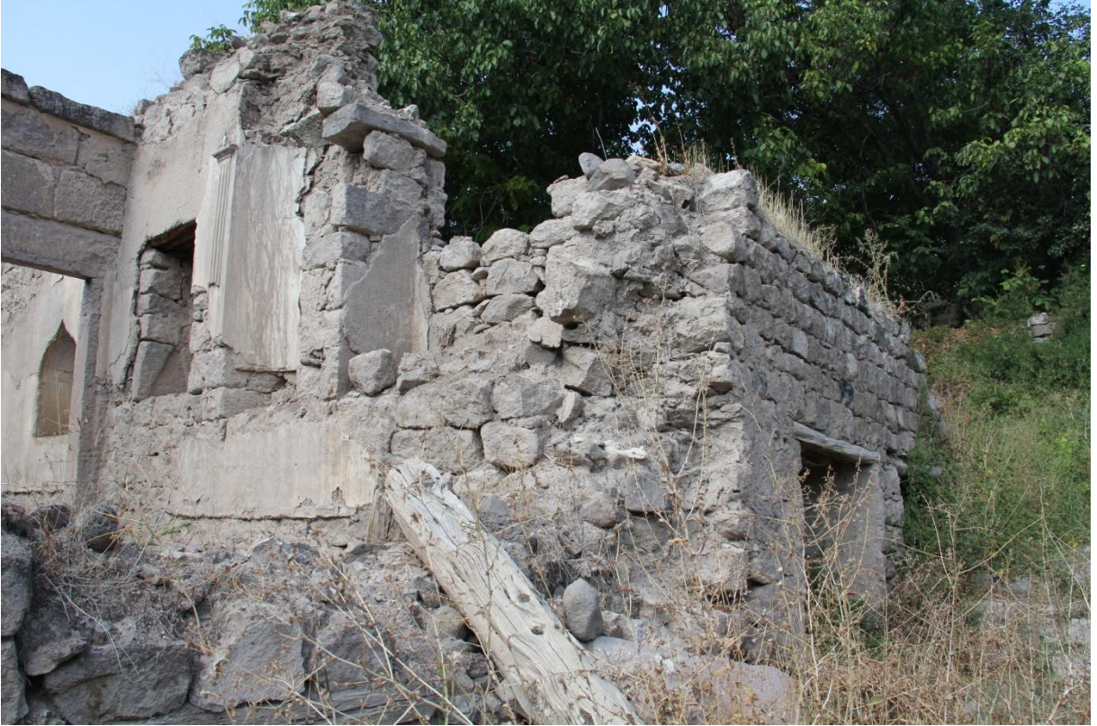
Şekil 135. 106 mekanı yıkılmış kuzey duvarı ve doğu duvarı birleşimi
