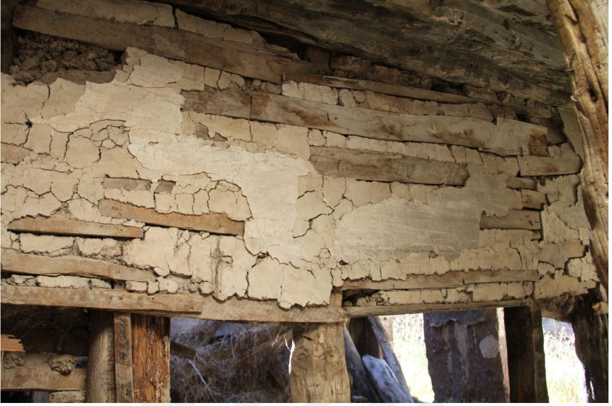
Şekil 58. Z02 mekanı batı yönündeki ahşap bölücü duvarın sıvaları
