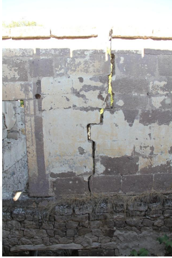
Şekil 126. 105 mekanı doğu duvarındaki strüktürel çatlak
