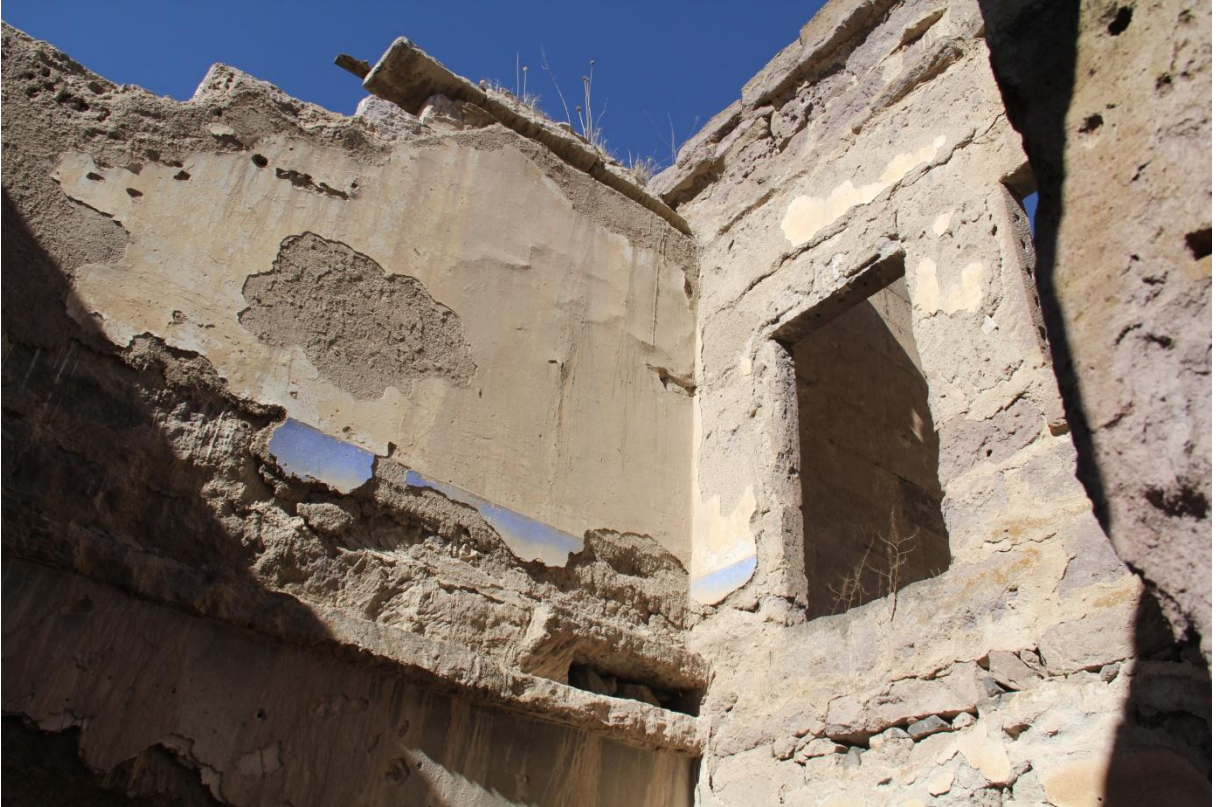
Şekil 111. 103 mekanı yok olmuş döşeme ve tavan
