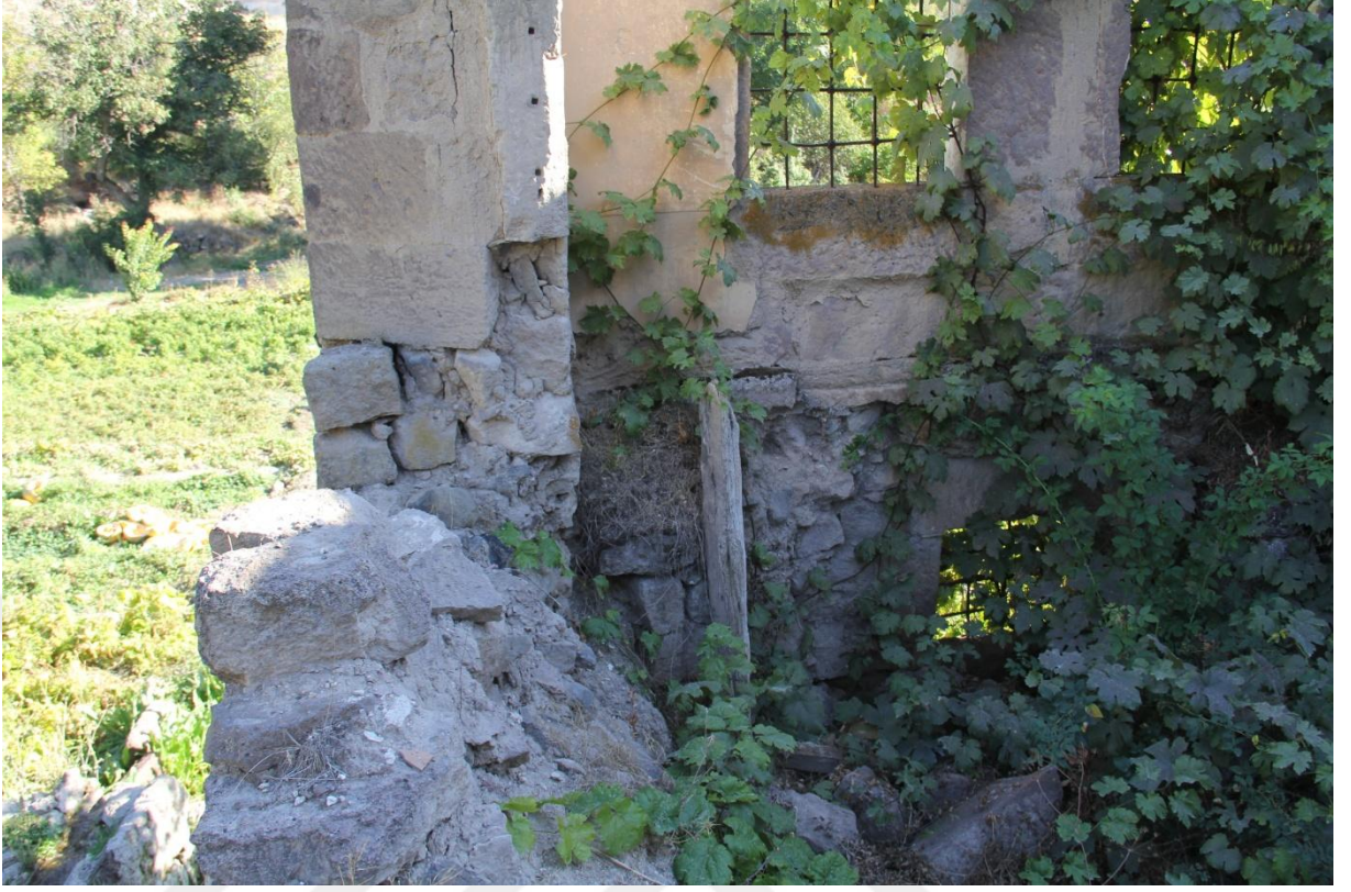
Şekil 132. 106 mekanı yıkılmış doğu duvarı
