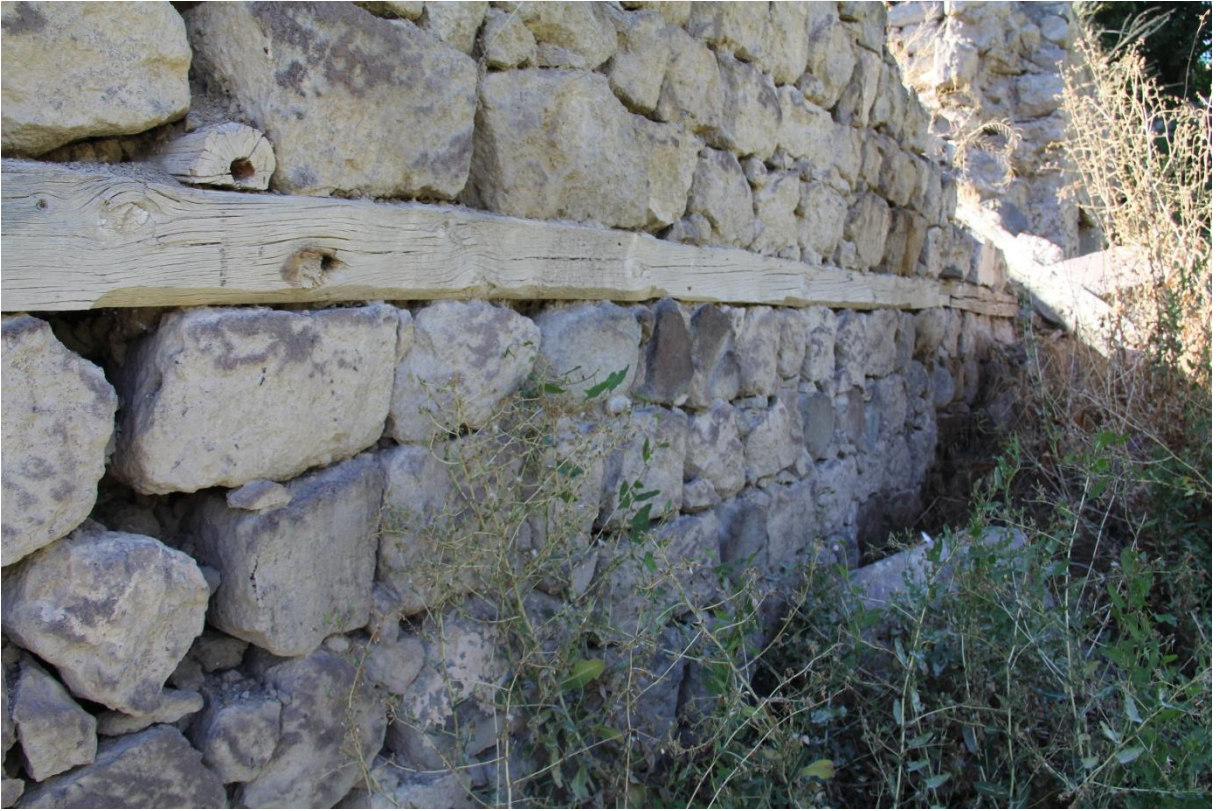
Şekil 151. Doğu duvarı moloz taş kalıntıları ve ahşap hatıl
