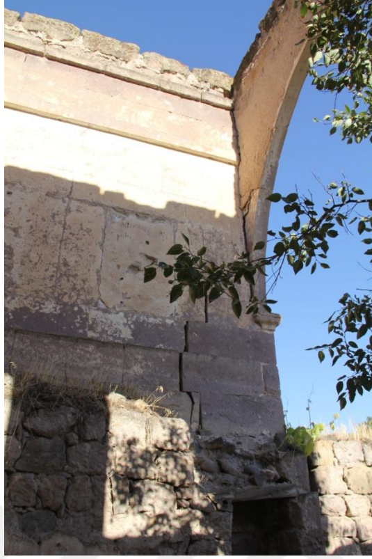
Şekil 120. 104 mekanı doğu duvarındaki strüktürel çatlak
