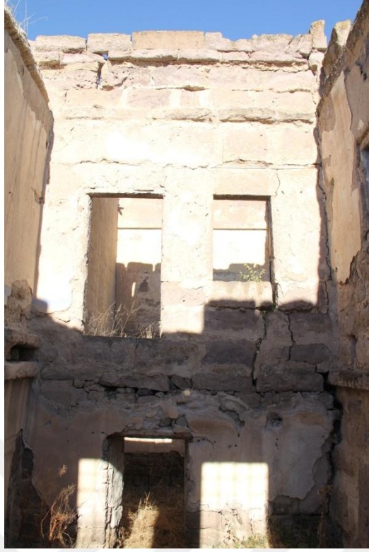
Şekil 114. 103 mekanı doğu duvarındaki kapı ve pencere boşluğu, strüktürel çatlak
