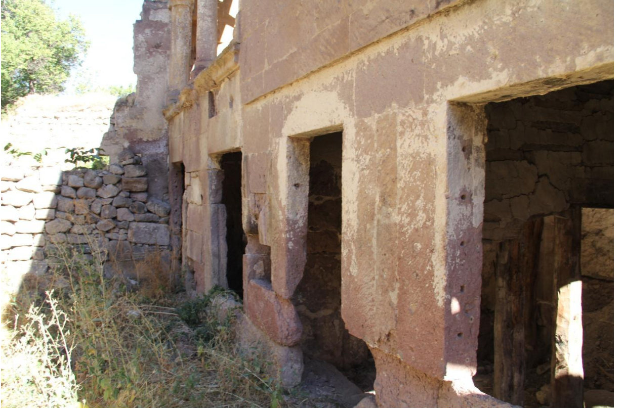
Şekil 137. Kuzey duvarı deformasyona uğramış pencere boşlukları
