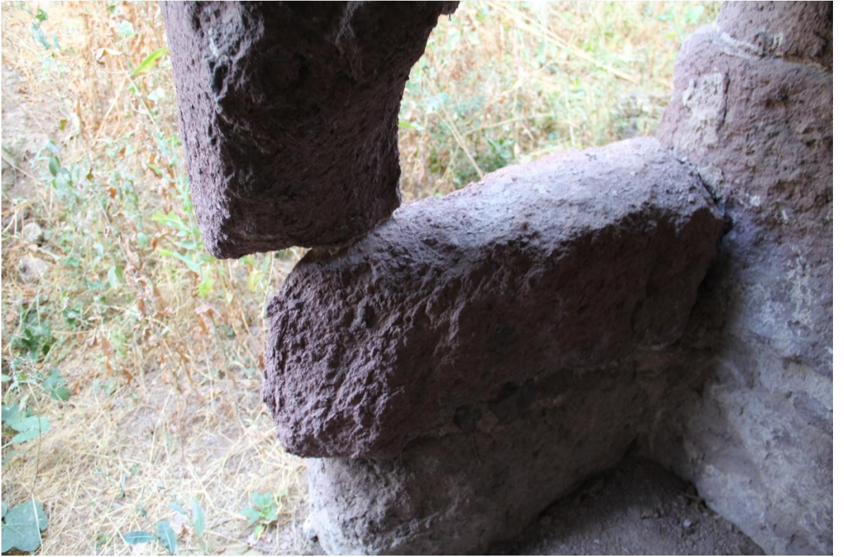
Şekil 57. Z02 mekanı strüktürel hasarlı taşlar
