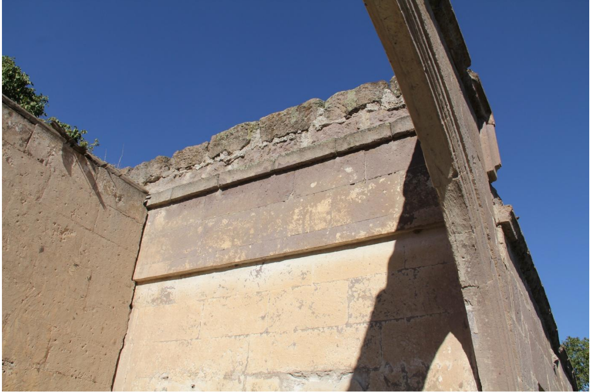
Şekil 117. 104 mekanı yok olmuş döşeme ve tavan
