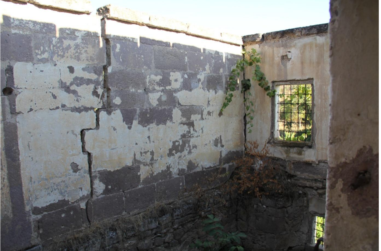
Şekil 127. 105 mekanı doğu duvarındaki strüktürel çatlak
