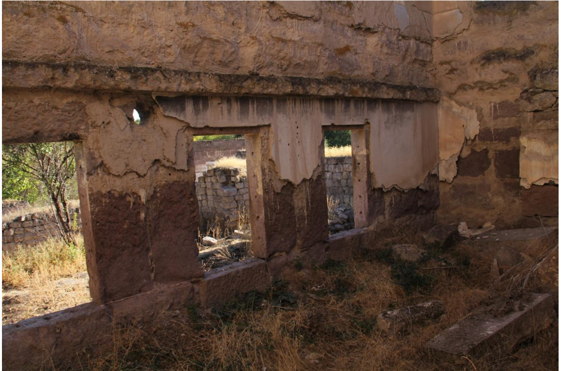
Şekil 73. Z04 mekanı güney duvarındaki pencere boşlukları
