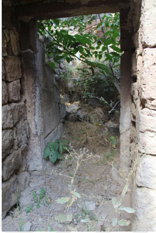
Şekil 82. Z06 mekanı Z06-D01 mekanları arasındaki kapı boşluğu
