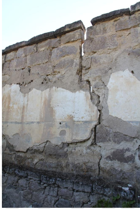
Şekil 130. 106 mekanı batı duvarındaki strüktürel çatlak
