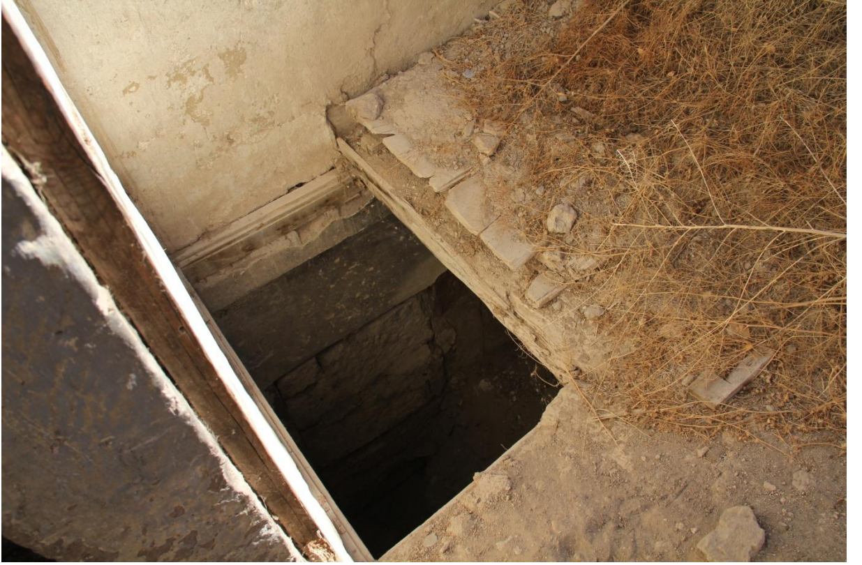
Şekil 105. 102 mekanı döşemedeki boşluk
