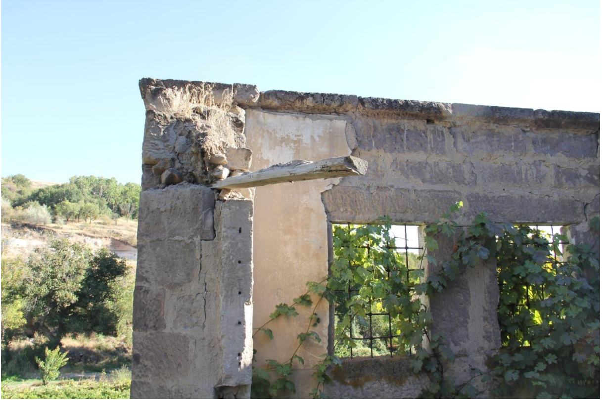
Şekil 133. 106 mekanı doğu duvarındaki parmaklık izleri
