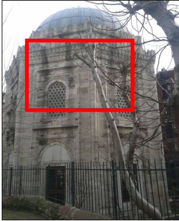
Resim 6.3 Hüseyin Paşa Türbesi Yüzey Erimeleri ve Kirlenmeler
