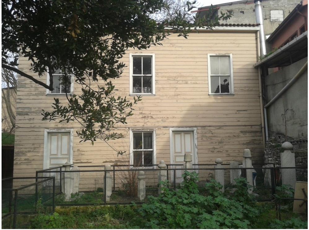
Resim 6.10 Hindular Tekkesi Batı Cephesi Ahşap Kaplamalarının Çürümesi
