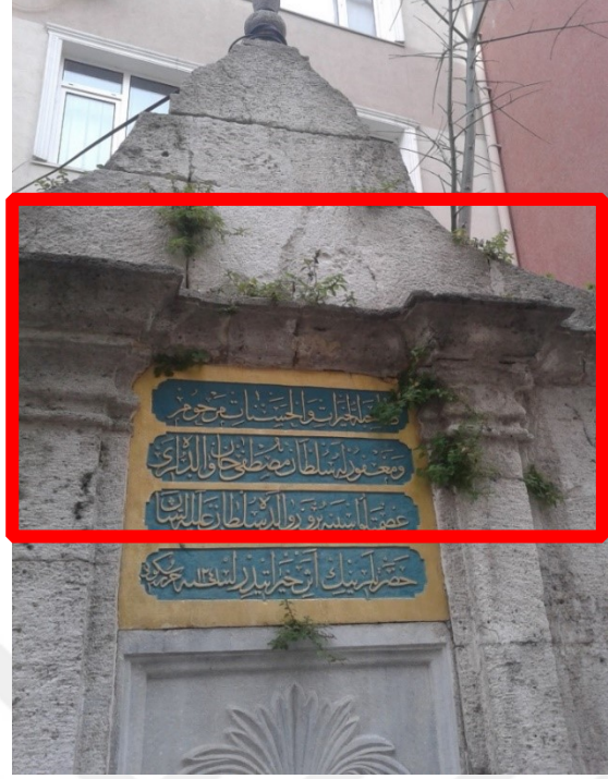
Resim 6.31 Örtü ve Saçaktaki Bozulmalar
