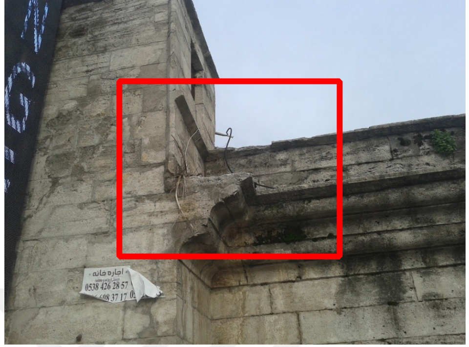
Resim 6.16 Köşe Kuledeki Hasarlar
