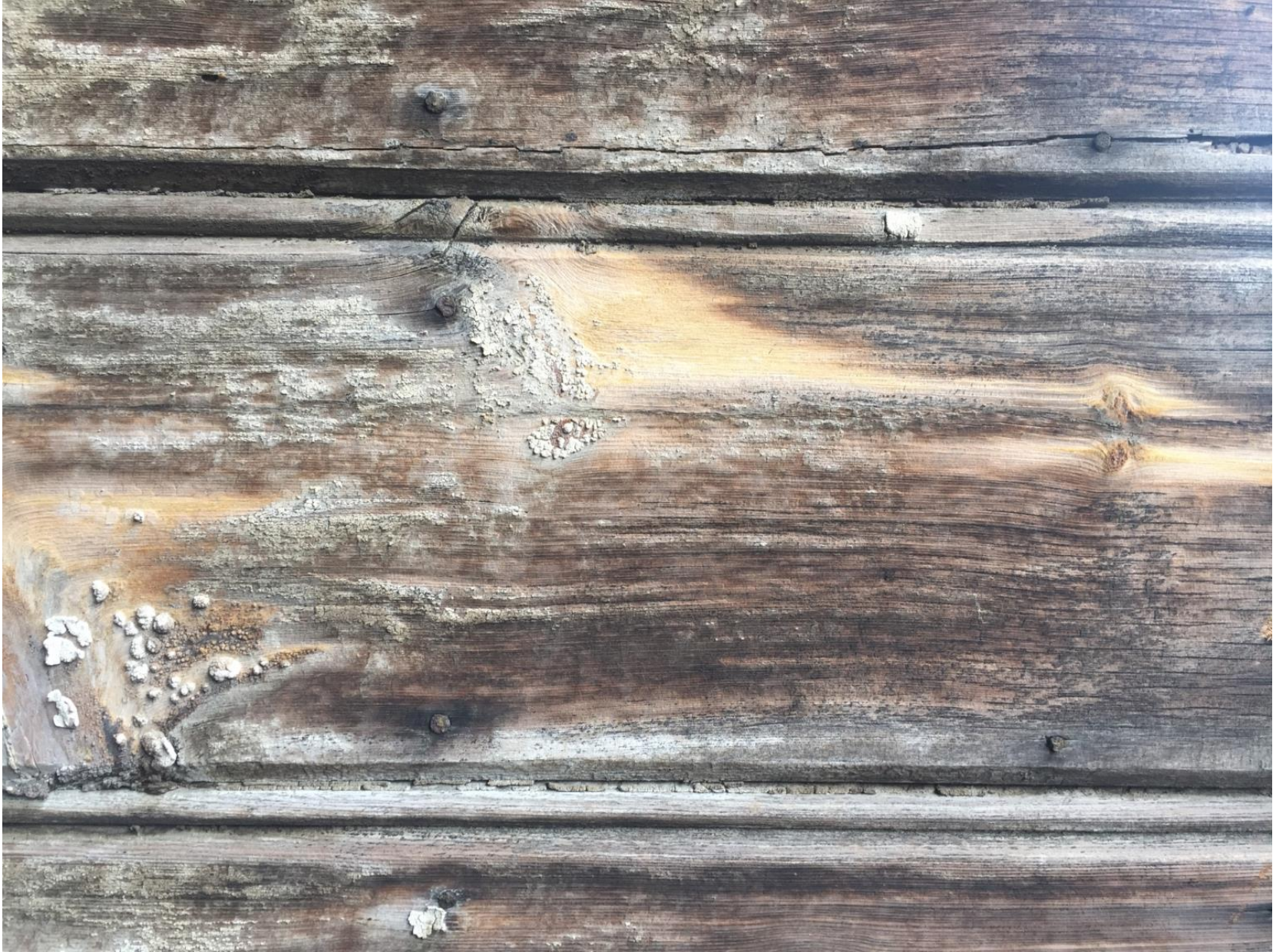
Fotoğraf 84: Cephe Kaplamasında Mantar Oluşumu
