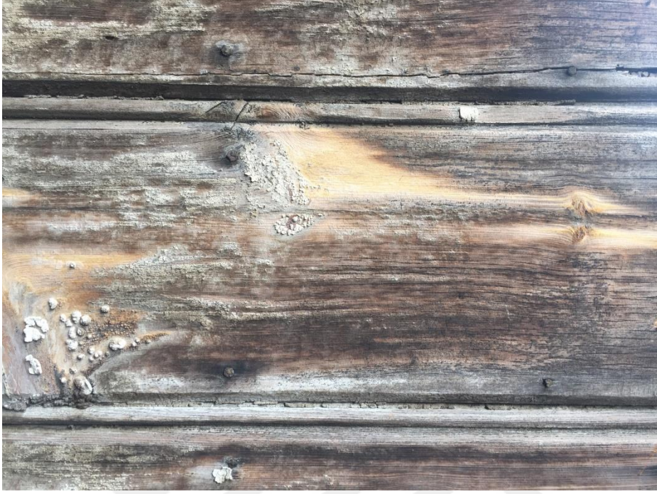
Şekil 4.10: Cephedeki Ahşabın Çürümesi ve Mantar Oluşumu
