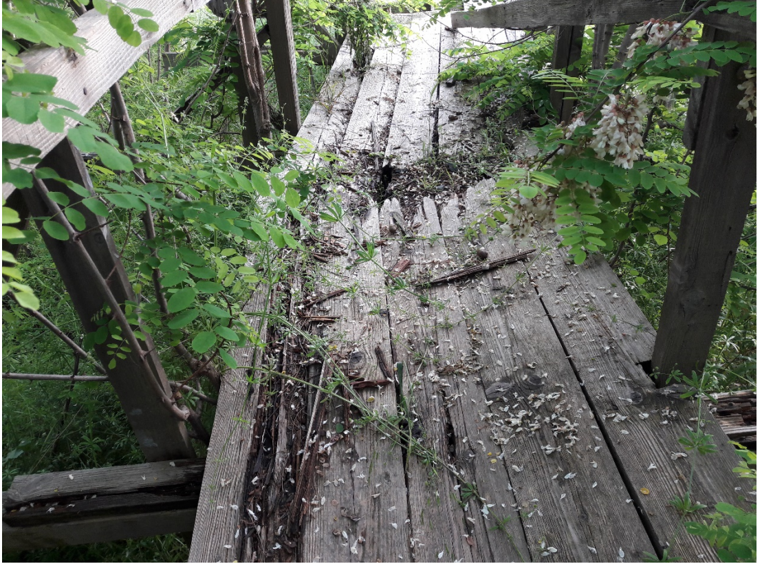
Şekil 4.1.8: Büyük Saray arazisinde ahşap yürüme yollarının durumu.
