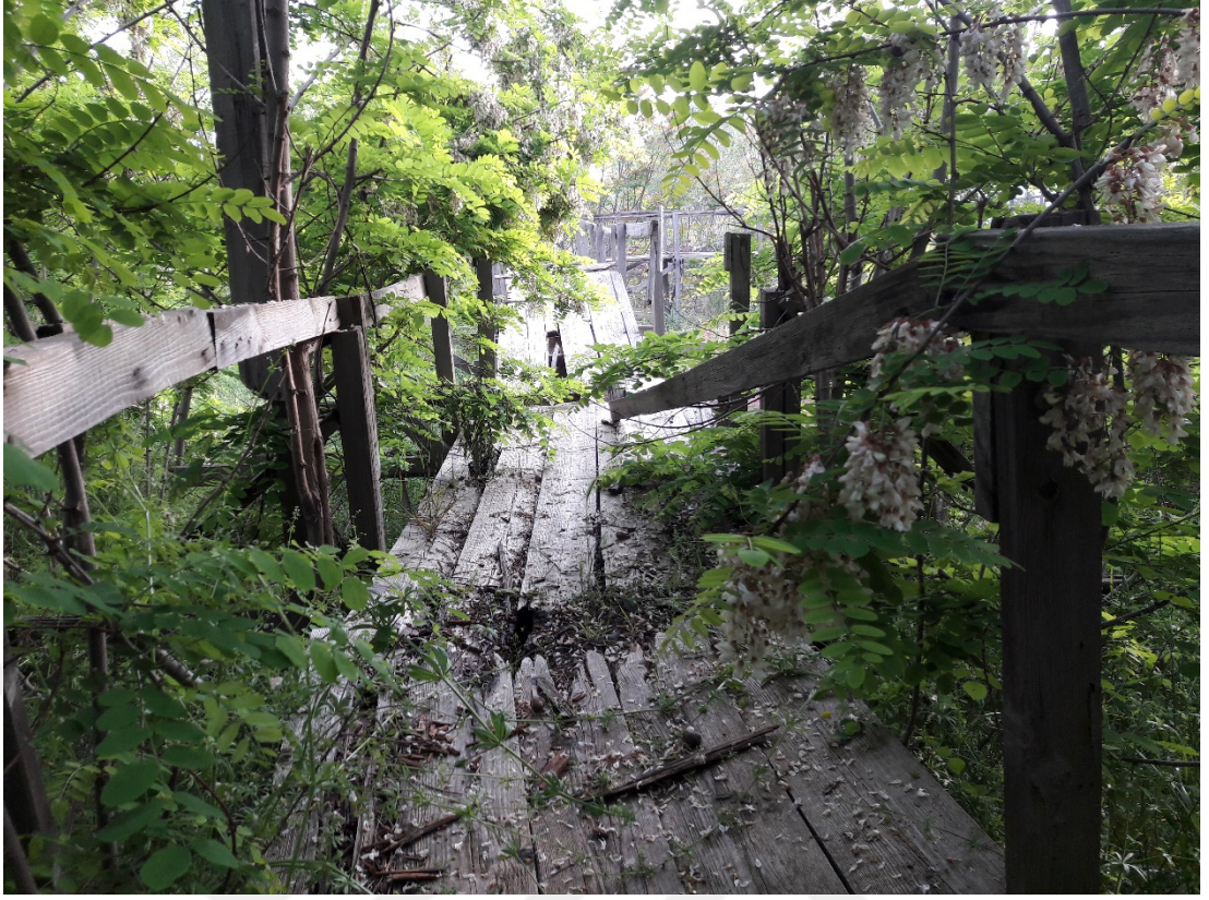
Şekil 4.1.7: Büyük Saray arazisinde ahşap yürüme yollarının durumu.
