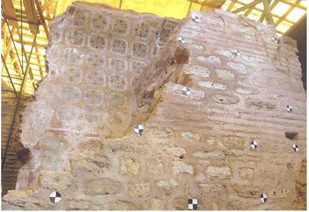
Şekil 3.26: 23 Numaralı Mekana Ait Duvar ve Fresko 205
