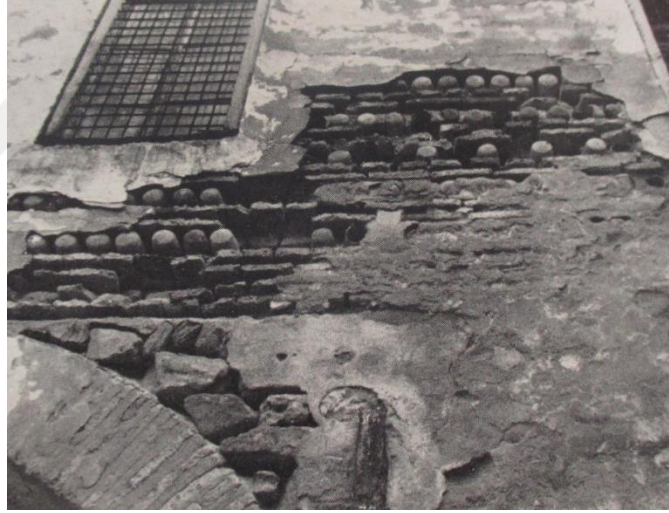
Şekil 3. 3 : Bir evin üst duvar uygulaması- Tuğla ve çomlek boruları. Tunus Medina’sında (Kaynak : Jacques Revault, 1978, s307)
