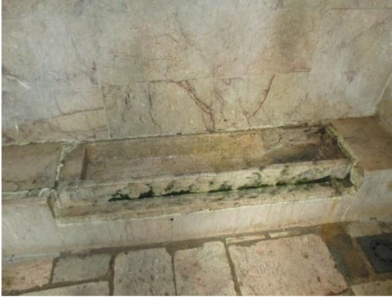
Şekil 4.46: Nemden dolayı Hasarlar (Giris Holu – Mihrab – Abdest yeri) (kaynak: Hazırlayan çekimi, Aralık 2016-Ağustos 2017)
