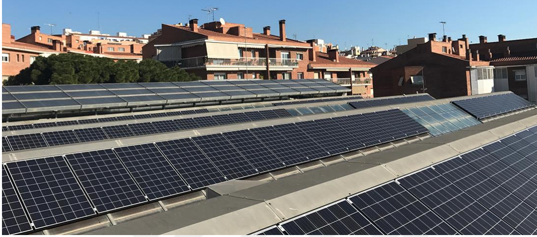
Resim 5.15: Çatıya monte edilen fotovoltaiik modüllerden bir görünüm (Url-34).
