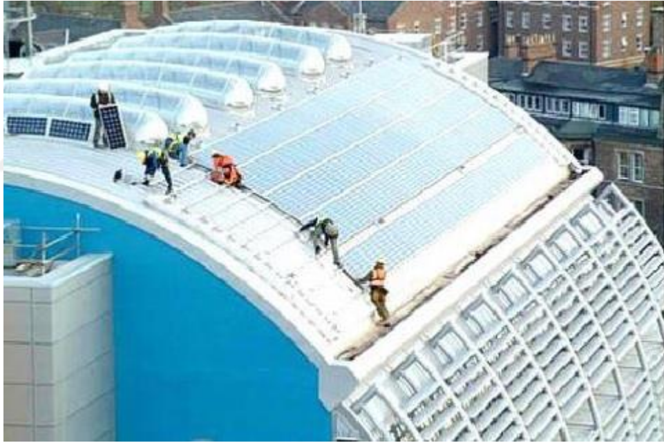
Resim 5.53: Çatıda kullanılan fotovoltaiik panellerden görünüm (Url-56).
