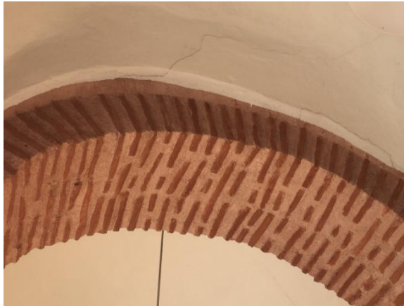
Şekil 569.Revaklarda bulunan kılcal çatlaklar (Öztürk, 2017)
