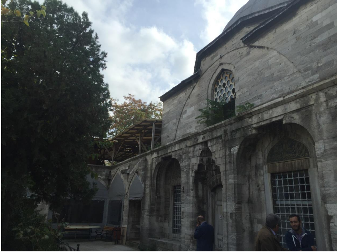
Şekil 191. Dershanenin avluya bakan cephesinde malzeme kayıpları ve siyah kabuk oluşumu (Öztürk, 2017)
