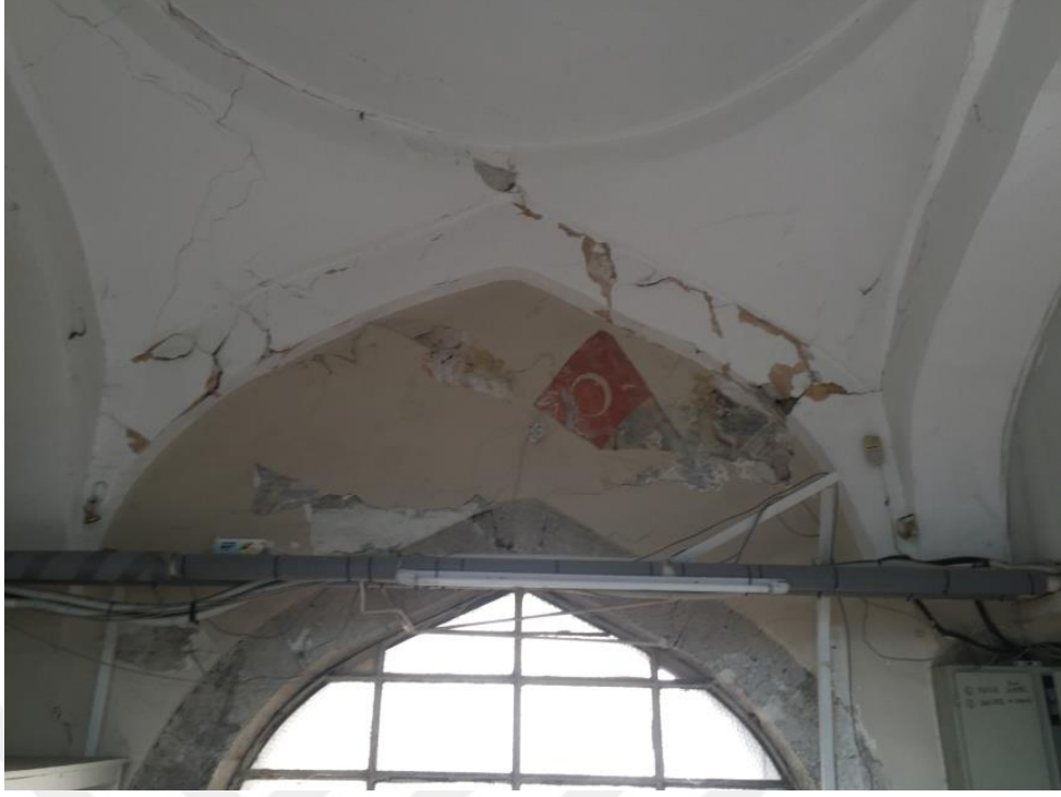
Şekil 190. Asıl giriş kapısında strüktürel ve kılcal çatlaklar (Öztürk, 2017)
