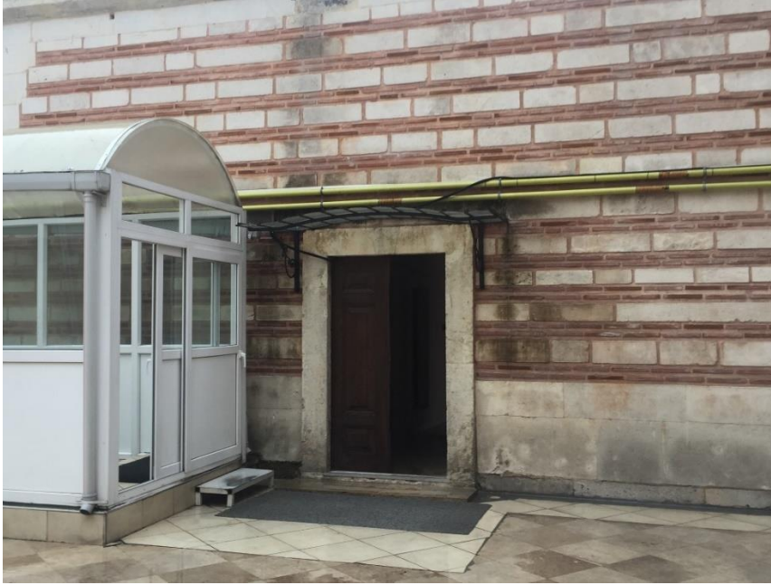
Şekil 396.Medresenin bugün kullanılan kuzeybatı cephesindeki giriş kapısı, tesisat bağlantıları ve kapı girişine yapılan sundurma (Öztürk, 2017)
