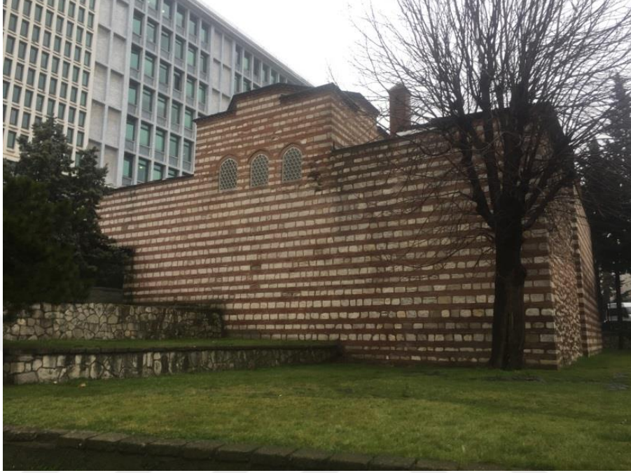
Şekil 515.Cephede malzeme kayıpları, derz boşalmaları (Öztürk, 2017)
