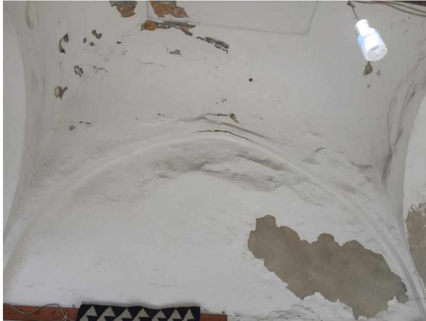
Şekil 530.Revaklarda bulunan sıva dökülmeleri (Öztürk, 2017)
