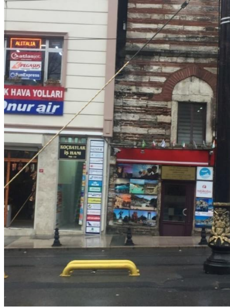
Şekil 146.Derz boşalmaları, malzeme kayıpları (Öztürk, 2017)
