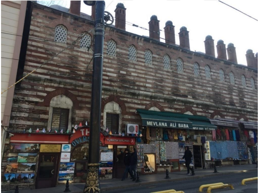
Şekil 144.Siyah kabuk oluşumu, yağmurdan dolayı cephede yıkanmalar, çimento ile derzleme (Öztürk, 2017)
