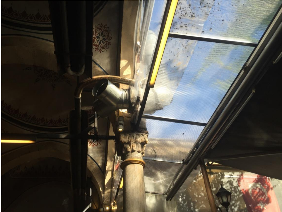
Şekil 533.Revaklara yapılan ısıtma ve havalandırma tesisatları (Öztürk, 2017)
