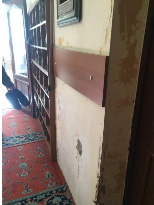
Şekil 12. Dershane girişinde sıva ve boya dökülmeleri (Öztürk, 2017)
