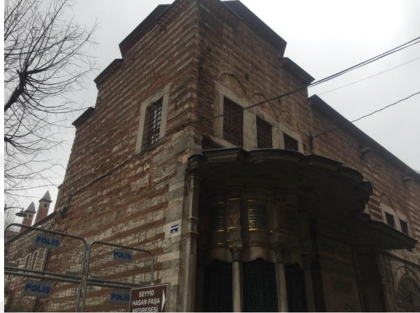
Şekil 597.Cephede siyah kabuk oluşumu ve yıkanmalar (Öztürk, 2017)
