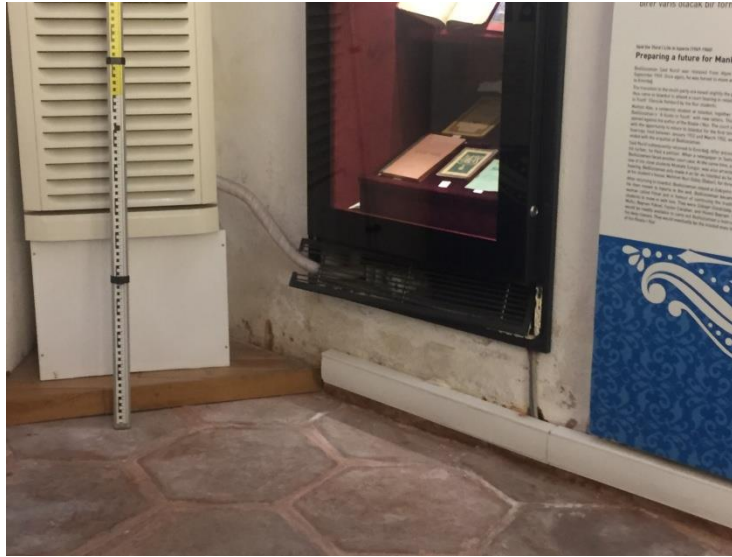
Şekil 94.Müze kısmındaki su problemleri (Öztürk, 2017)
