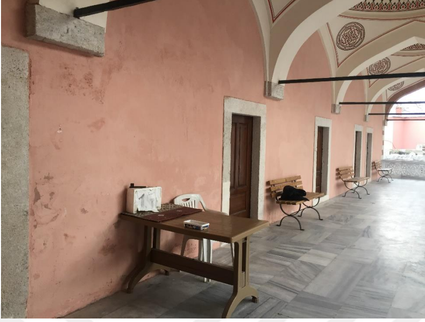
Şekil 283.Su problemleri görünümü (Öztürk, 2017)
