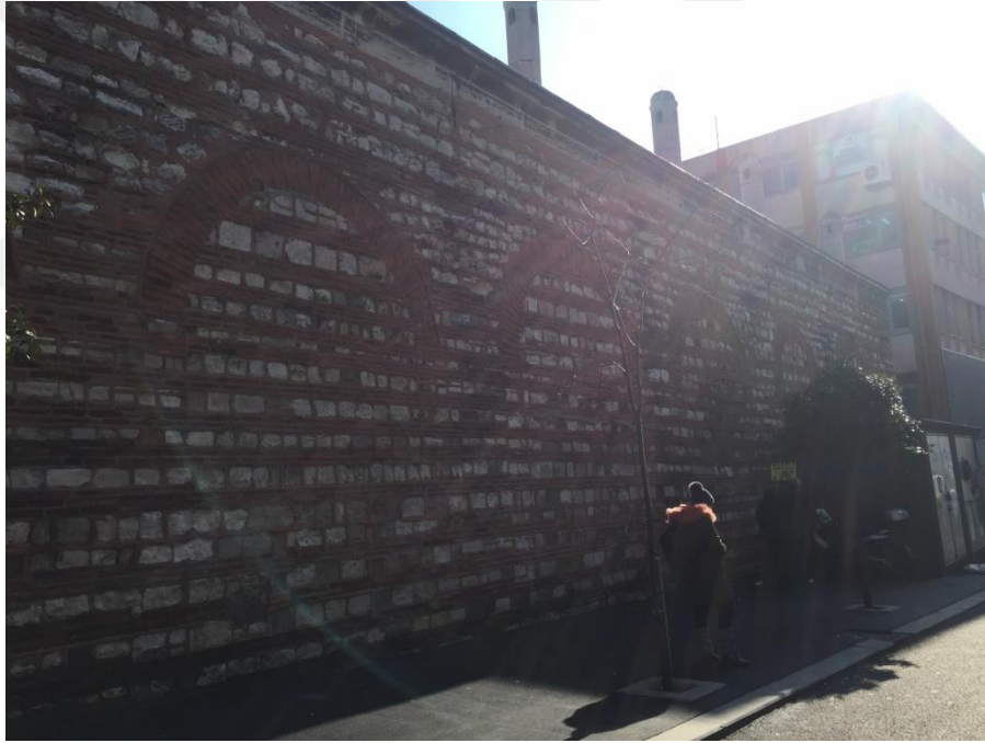
Şekil 448.Batı cephesi yıkanmalar ve siyah kabuk oluşumu (Öztürk, 2017)
