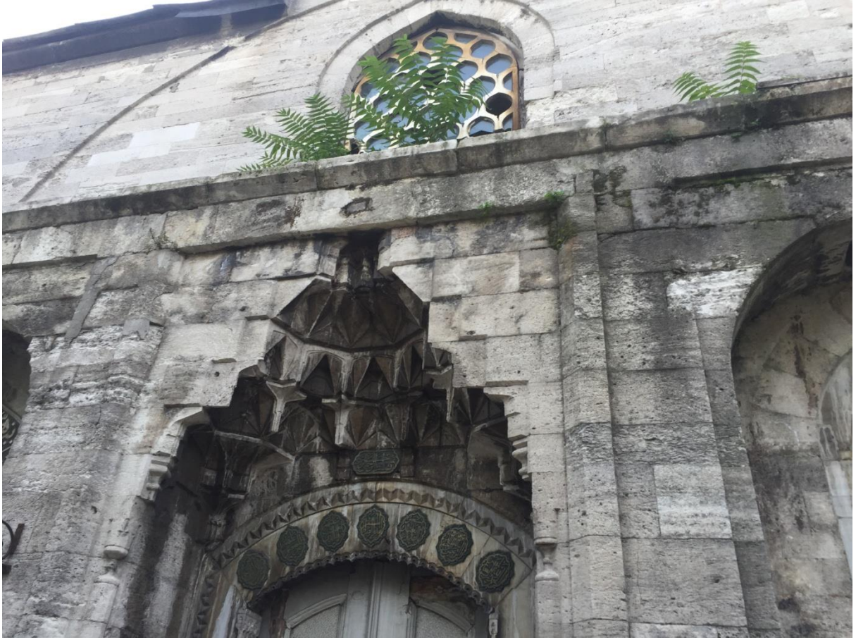
Şekil 186.Dershane giriş kapısı üzerinde bitkilenme, mukarnasta siyah kabuk oluşumu, aydınlık penceresinin camları kırılmış durumdadır
