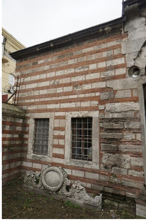
Şekil 465.Medrese hücre duvarında derz boşalmaları ve siyah kabuk oluşumu (K.M.K.M., 2017)
