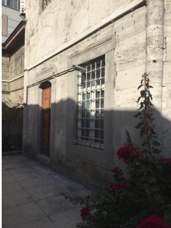
Şekil 438.Dış cepheden bağlanmış doğalgaz borusu ve pvc pencereden çıkan doğalgaz bacası (Öztürk, 2017)
