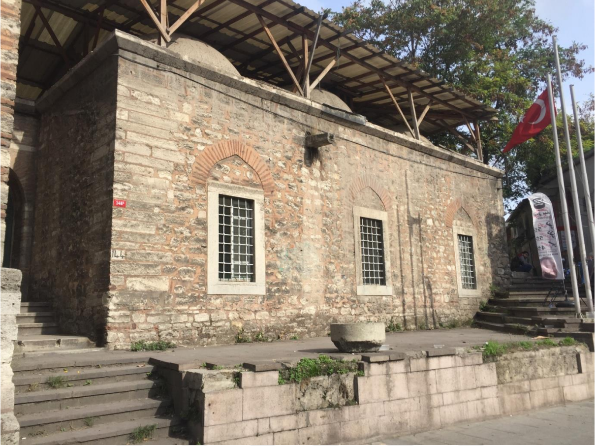
Şekil 189.Dış cephe üzerinde siyah kabuk oluşumu, yıkanmalar, zemin suyundan bitkilenme (Öztürk, 2017)
