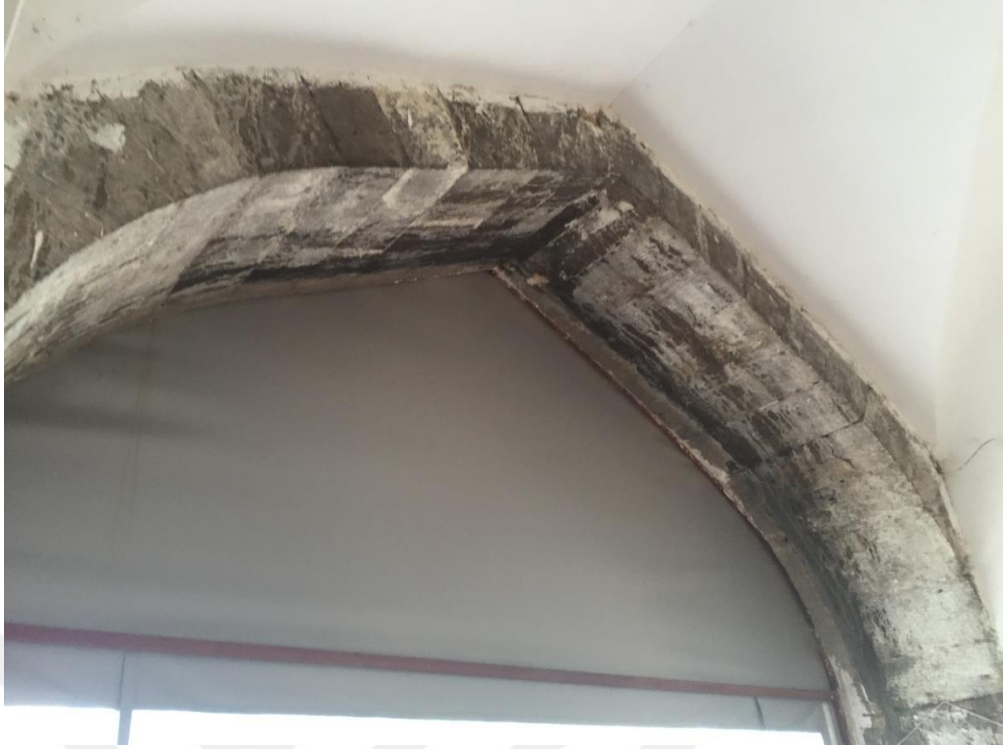
Şekil 193.İç mekanlarda oluşan siyah kabuk oluşumu boya ve sıva ile kapatılmaya çalışılmış (Öztürk, 2017)
