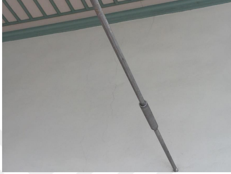
Şekil 347.Revaklardaki kılcal çatlaklardan bir görünüm (Öztürk, 2017)
