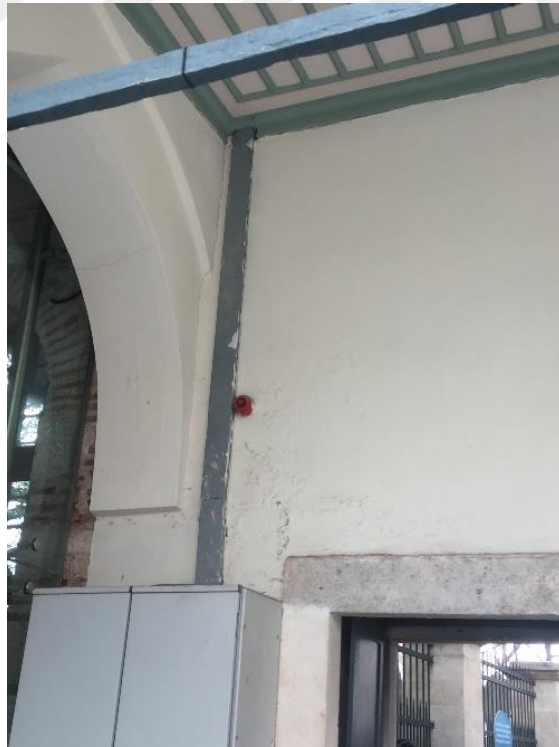
Şekil 346. Revaklardaki rutubet ve kılcal çatlaklar (Öztürk, 2017)
