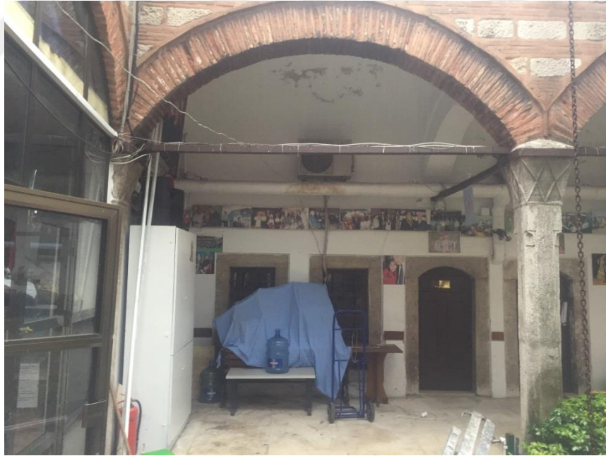
Şekil 519.Uygun olmayan tesisat uygulamaları (Öztürk, 2017)
