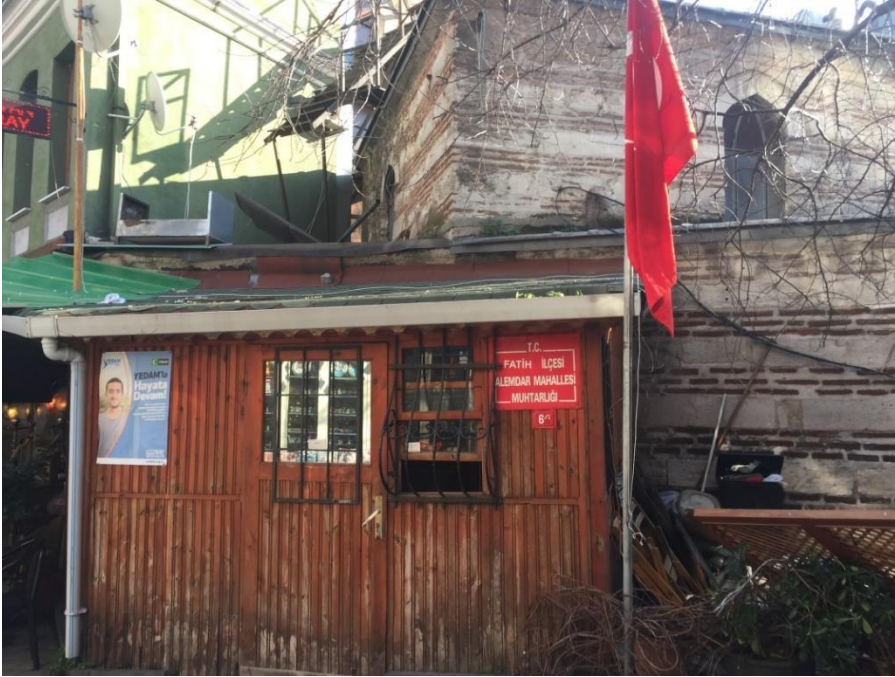
Şekil 252.Kuzeybatı cephesindeki siyah kabuk oluşumu (Öztürk, 2017)
