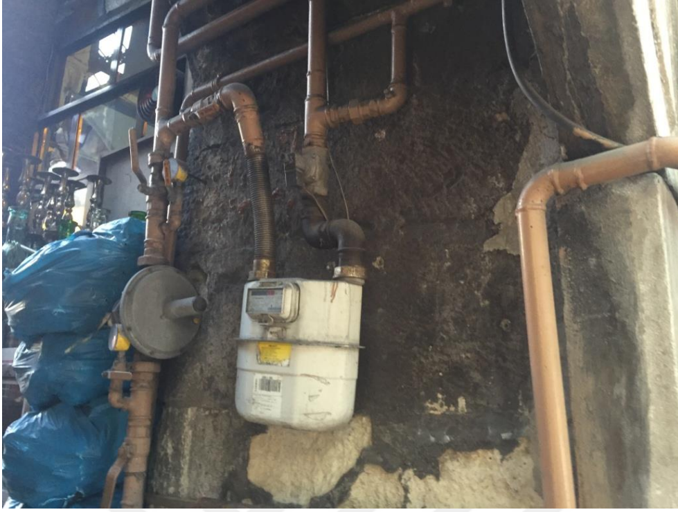
Şekil 532.Girişe yapılan doğalgaz tesisatı (Öztürk, 2017)
