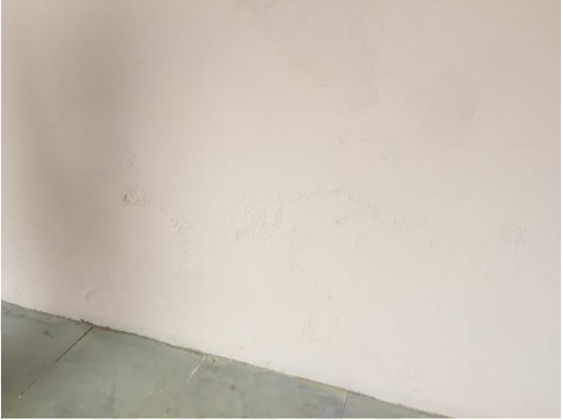
Şekil 394.Yeni boyanmış duvardaki rutubet sorunu (Öztürk, 2017)
