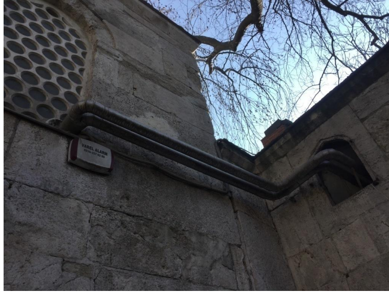
Şekil 455.Kütüphane için yapılan ısıtma tesisatı (Öztürk, 2017)
