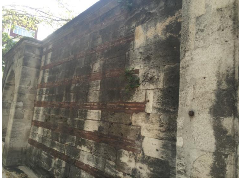
Şekil 76.Cephede siyah kabuk oluşumuna bağlı olarak yıkanmalar (Öztürk, 2017)
