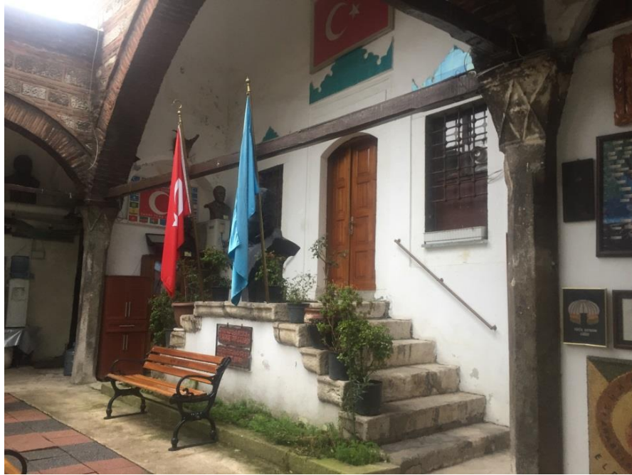
Şekil 516.Avludaki siyah kabuk oluşumları ve kılcal sıva çatlakları (Öztürk, 2017)
