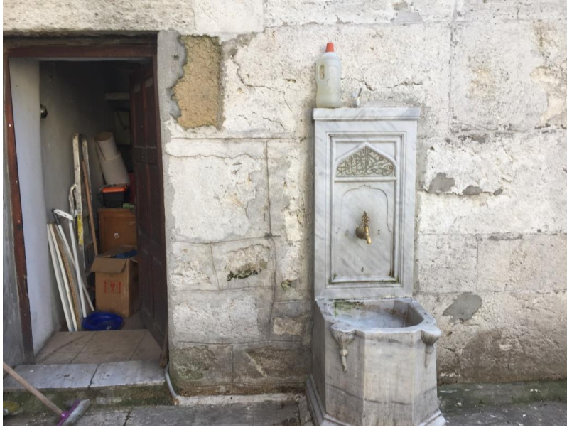
Şekil 449.Çeşme duvarındaki çimento ile yapılan uygulamalar (Öztürk, 2017)
