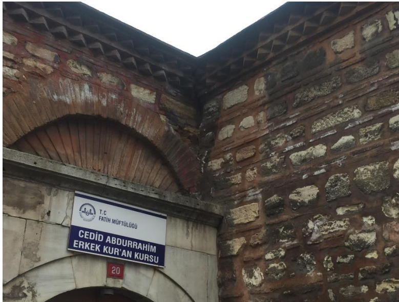
Şekil 605.Giriş cephesinde bulunan siyah kabuk oluşumu, yıkanmalar ve rutubet oluşumları
