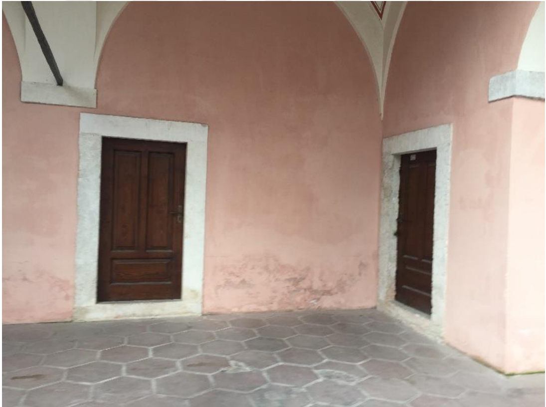
Şekil 282.Su problemleri görünümü (Öztürk, 2017)
