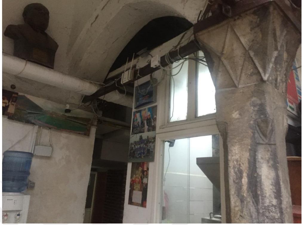
Şekil 518.Uygun olmayan tesisat uygulamaları (Öztürk, 2017)
