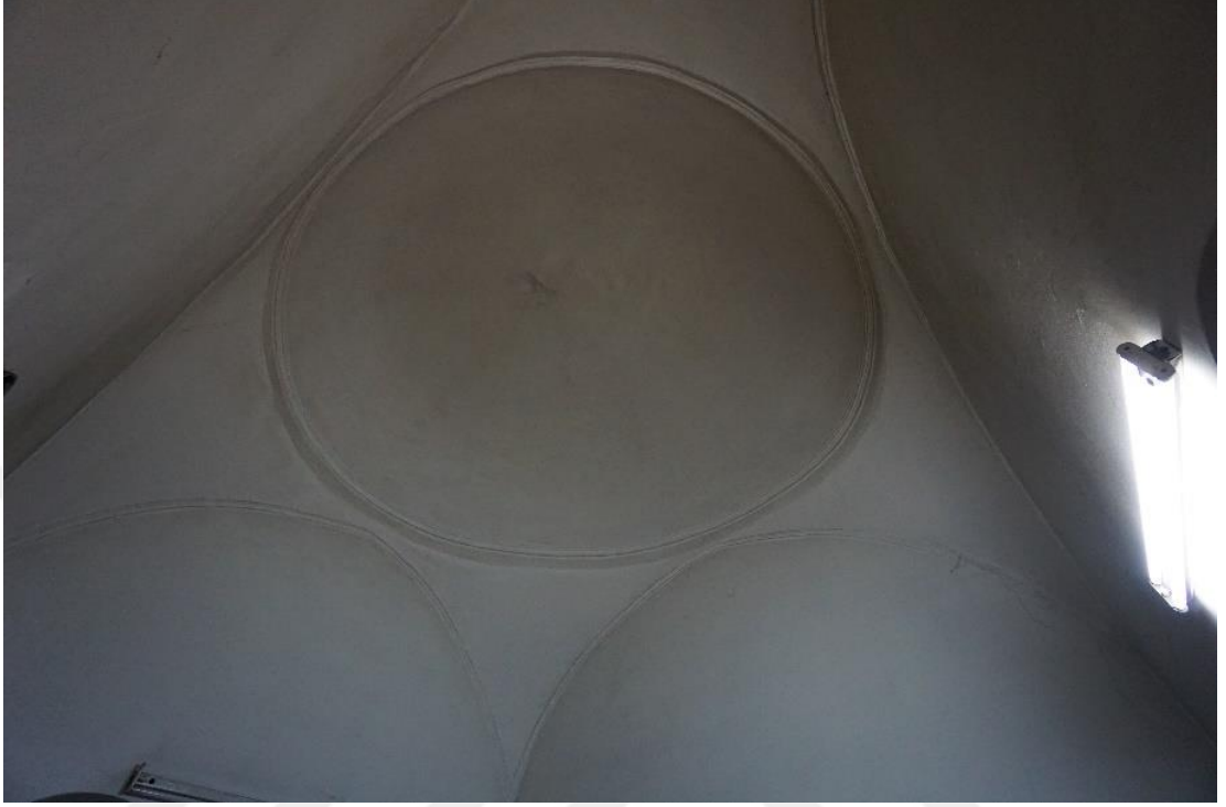
Şekil 467.Hücre kubbelerinde bulunan kılcal çatlaklar (K.M.K.M., 2017)
