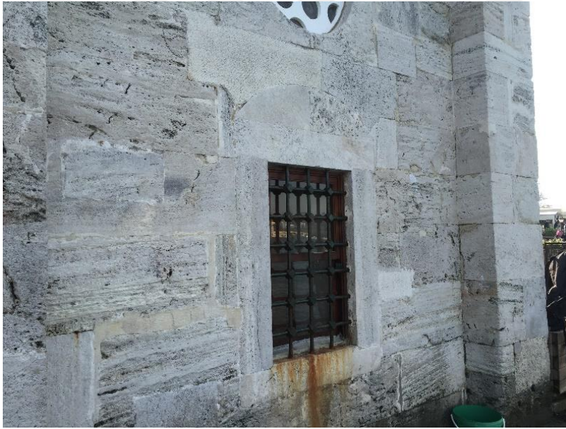
Şekil 275.Cephedeki korozyon görünümü (Öztürk, 2017)
