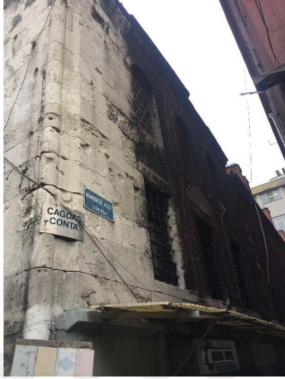
Şekil 499.Cephede yıkanmalar ve siyah kabuk oluşumu görünümü (Öztürk, 2017)
