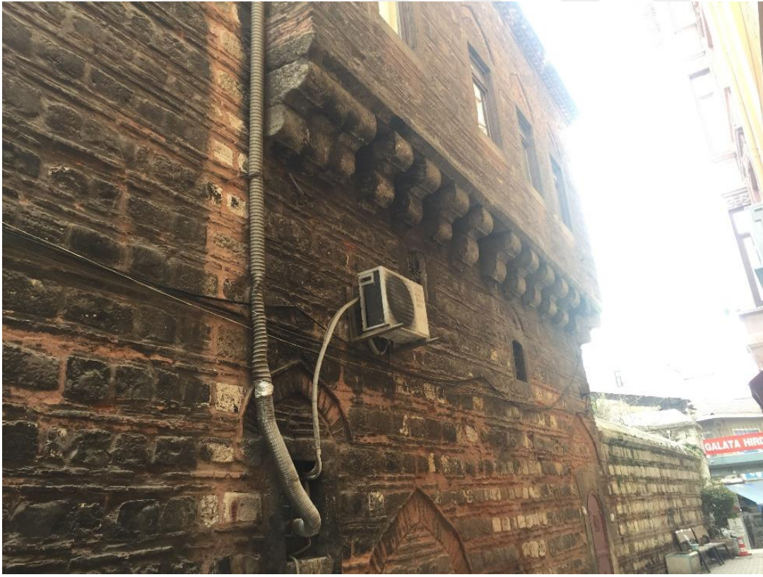
Şekil 498.Cephede yıkanmalar ve siyah kabuk oluşumu görünümü (Öztürk, 2017)
