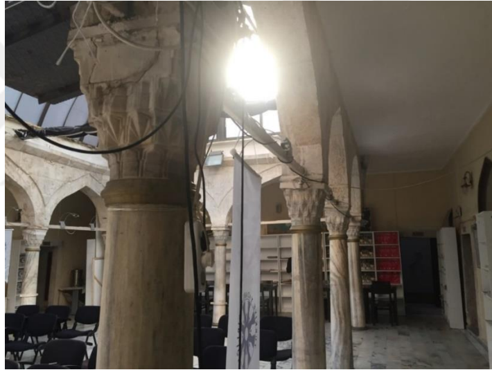
Şekil 258.Revaklarda bulunan elektrik tesisatı (Öztürk, 2017)
