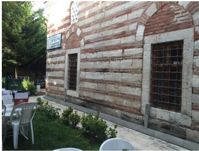
Şekil 167.Medrese cephesinin alt kotlarında başlayan siyah oluşumlar (Öztürk, 2017)
