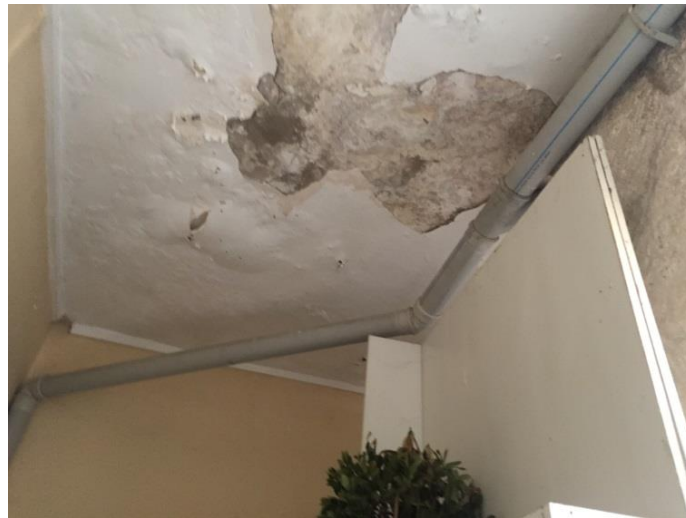
Şekil 250.Revak koridorundaki nem problemi ve su tesisatı (Öztürk, 2017)
