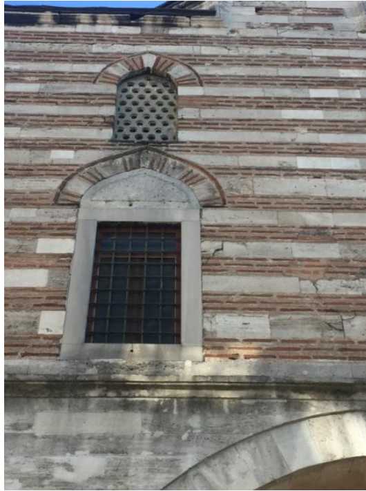
Şekil 239.Cephede bulunan çatlaklar (Öztürk, 2017)
