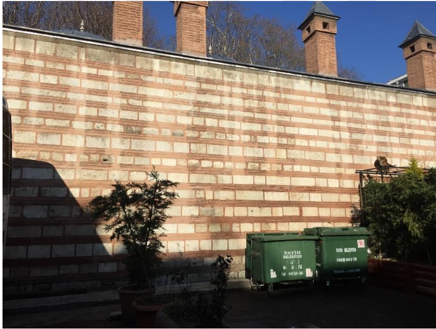
Şekil 491.Cephede siyak kabuk oluşumu ve yıkanmalar (Öztürk, 2017)
