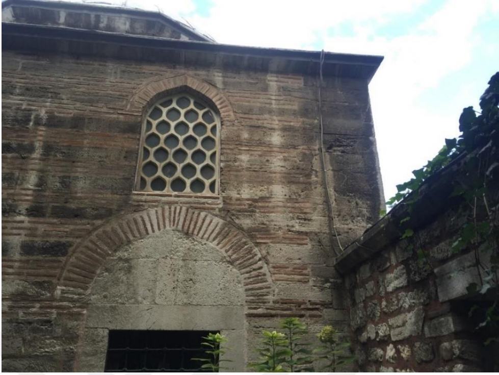
Şekil 143.Siyah kabuk oluşumu, yağmurdan dolayı cephede yıkanmalar, çimento ile derzleme (Öztürk, 2017)
