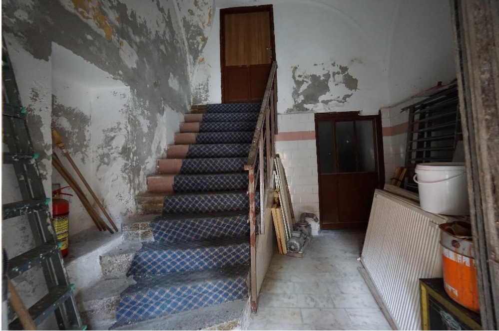
Şekil 607.Duvarlarda bulunan rutubete bağlı sıva dökülmeleri (K.M.K.M., 2017)
