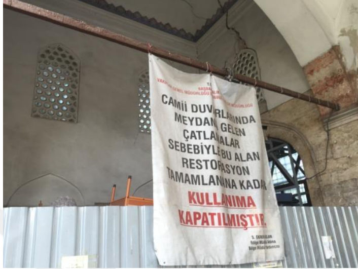
Şekil 168.Cami duvarı ve revaklardaki çatlaklar (Öztürk, 2017)
