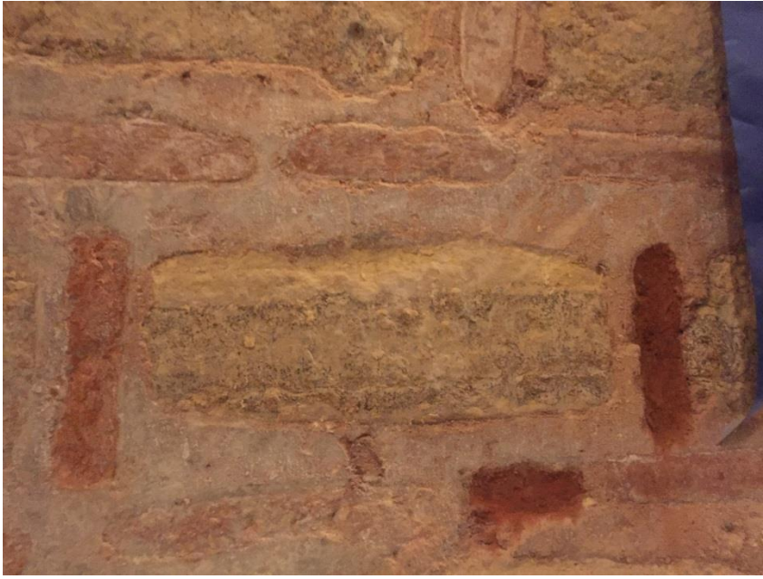
Şekil 372.İç mekân duvarlarında bulunan çiçeklenme (Öztürk, 2017)
