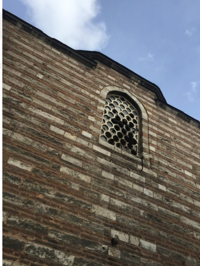
Şekil 188. Dershanenin dış cephesinde çatlaklar, siyah kabuk oluşumu, aydınlık penceresi kırılmış (Öztürk, 2017)
