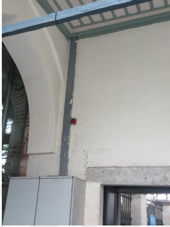
Şekil 120.Revaklardaki rutubet ve kılcal çatlaklar (Öztürk, 2017)
