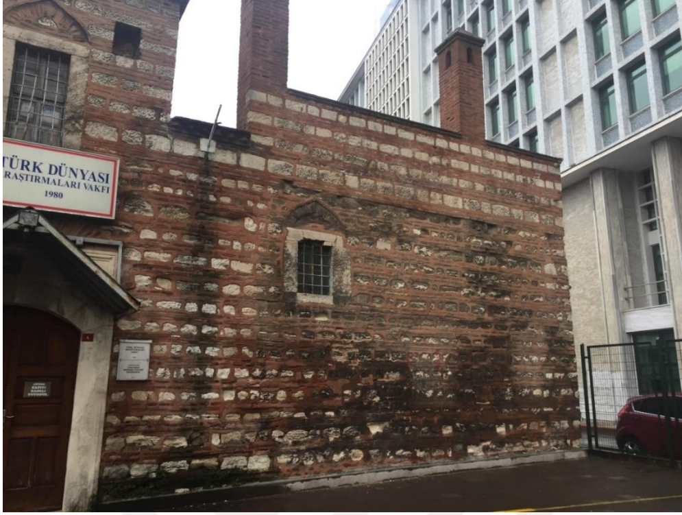
Şekil 513.Cephede siyah kabuk oluşumu ve yıkanmalar (Öztürk, 2017)
