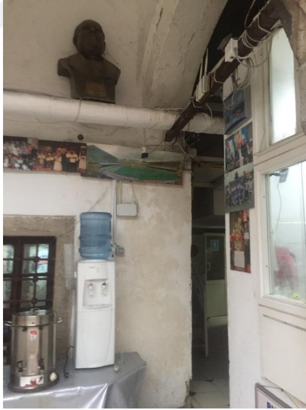
Şekil 514.Hücre duvarındaki rutubetlenme (Öztürk, 2017)
