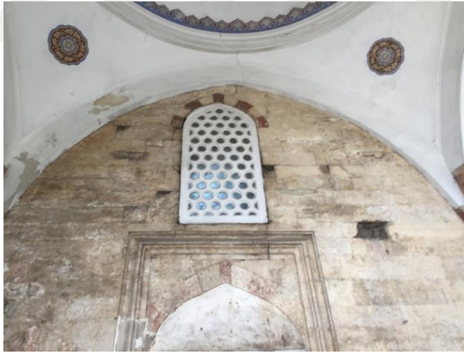
Şekil 169.Cami duvarı ve revaklardaki çatlaklar (Öztürk, 2017)
