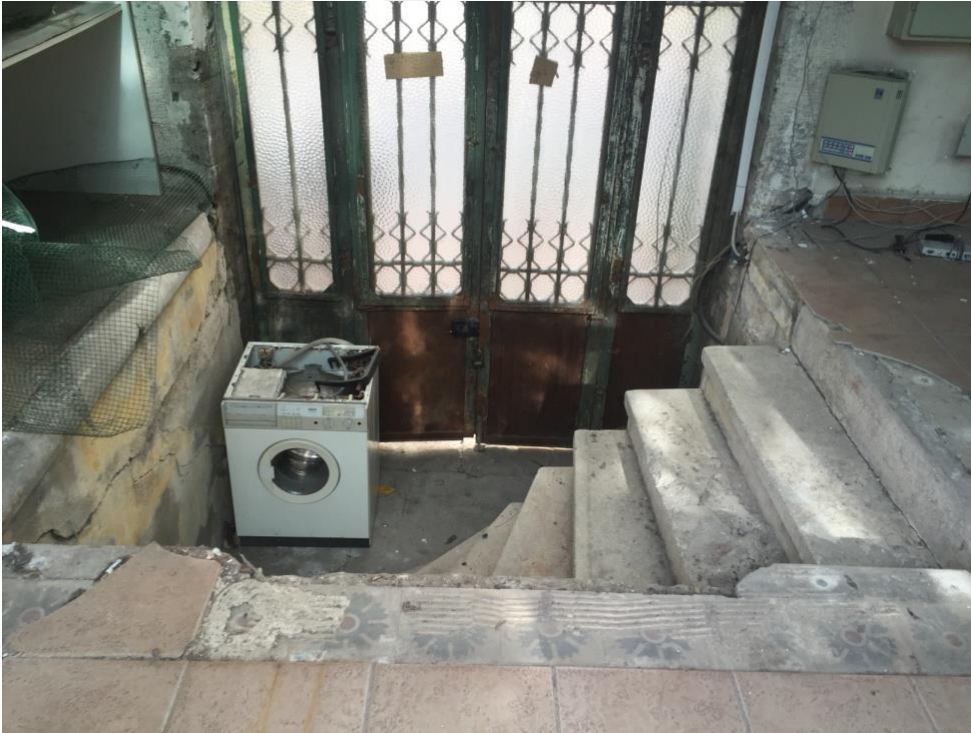
Şekil 192.Zemin üst üste farklı malzemeler ile kaplanmış, elektrik tesisatları gelişmiş, güzel çekilmiş, özgün olmayan bir kapı kullanılmıştır
