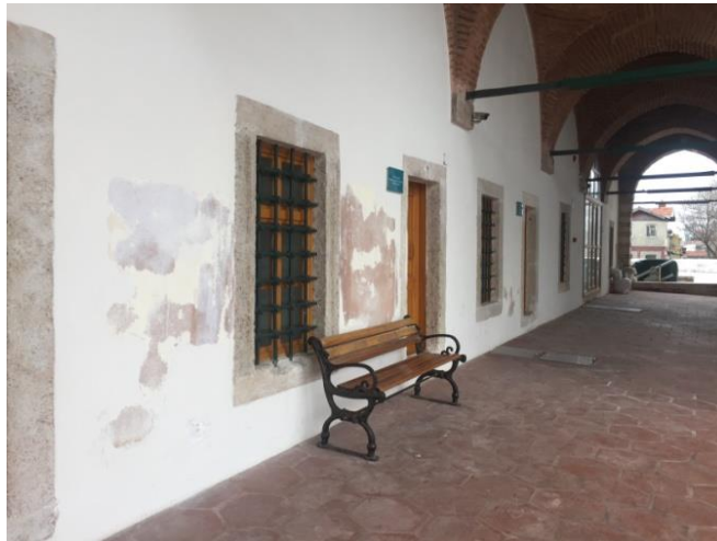
Şekil 221.Hücre duvarlarında görülen rutubet (Öztürk, 2017)
