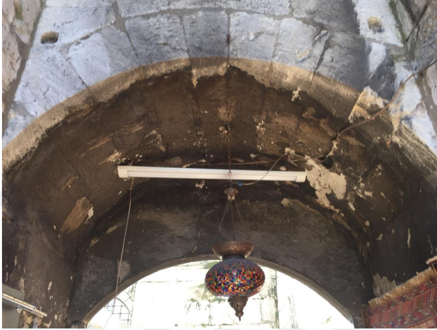
Şekil 529.Siyah kabuk oluşumuna bağlı malzeme deformasyonları (Öztürk, 2017)
