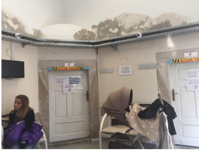
Şekil 77.Hücrelerin revaklara bakan cephelerinde sıva dökülmeleri (Öztürk, 2017)
