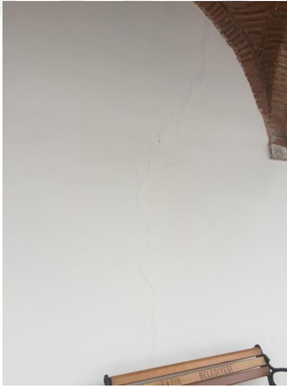
Şekil 223.Duvarlarda bulunan kılcal çatlaklar (Öztürk, 2017)
