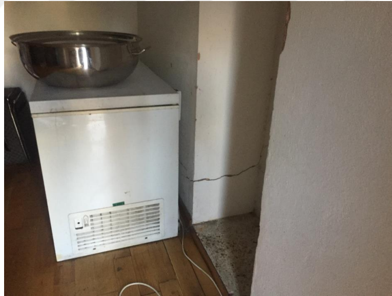
Şekil 96.Hücre içindeki çatlak ve özgün olmayan yer kaplaması (Öztürk, 2017)
