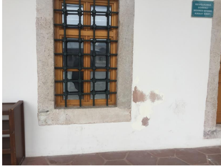
Şekil 222.Hücre duvarların bulunan rutubet (Öztürk, 2017)
