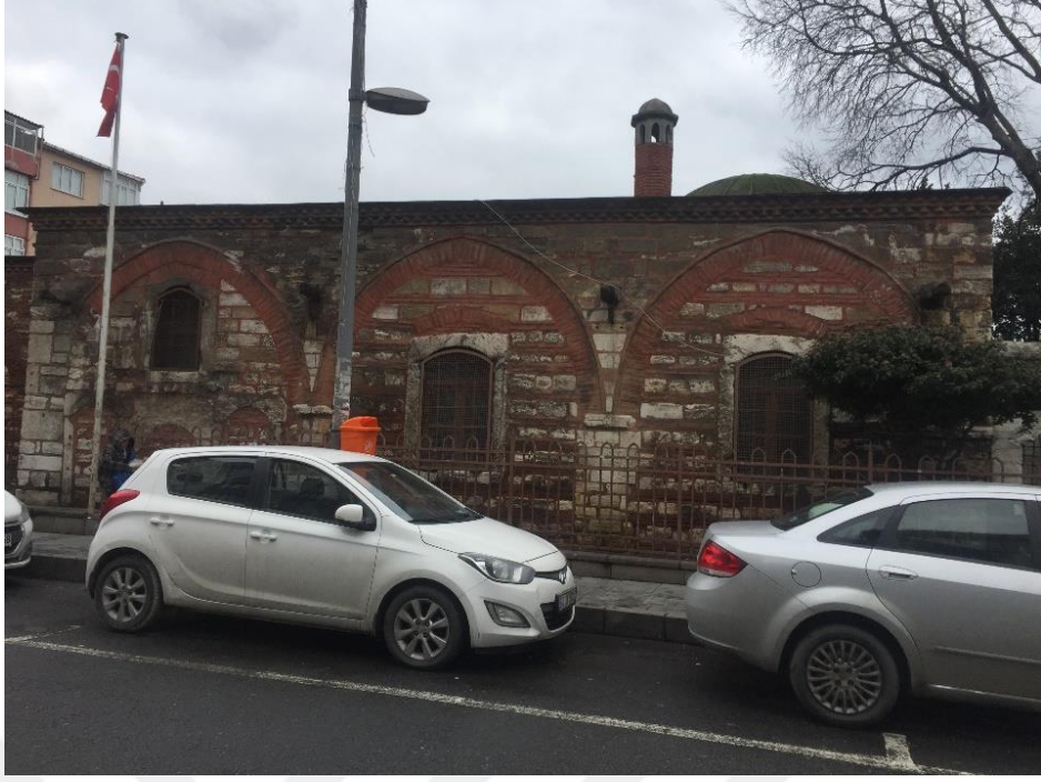
Şekil 606.Giriş cephesinde bulunan siyah kabuk oluşumu, yıkanmalar ve rutubet oluşumları (Öztürk, 2017)
