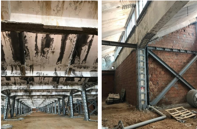
Şekil B. 27 : Tavan bozulma detayı (solda), kuzeybatı yönünde tuğla duvarla ayrılan ve yeni işlevi gereği sanat atölyesi olarak kullanılacak bölüm (sağda) (Ceylan Akış).
