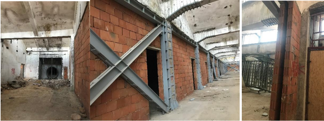
Şekil B. 24 : İşletme binası giriş bölümü korunması önerilen alan (solda), dilatasyon detayı ile yenilenen bölücü duvarlar (sağda) (Ceylan Akış).
