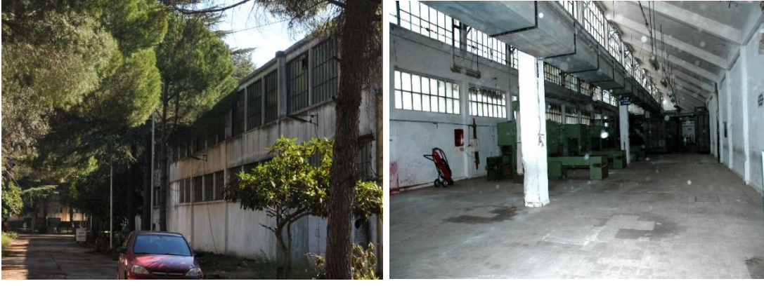
Şekil B. 10 : Doğu cephesi özgün pencere detayı ile cephe ve iç mekândan görünüşleri (Kepez Belediyesi).
