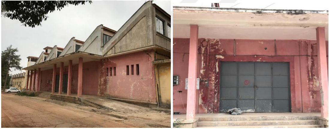
Şekil B. 14 : İşletme binası doğu cephesinde korunması önerilen özgün giriş kapısı (solda), cephede oluşan kir ve bozulmalar ile malzeme kayıpları (sağda) (Ceylan Akış).
