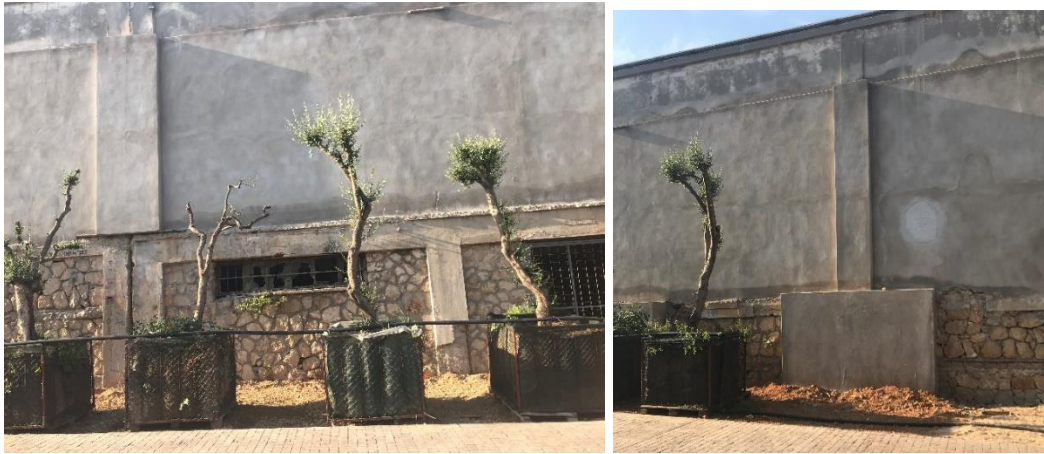
Şekil B. 21 : Güney cephesi dilatasyon detayı ile kolon ve temelde yapılan güçlendirme sonrası detaylar (Ceylan Akış).
