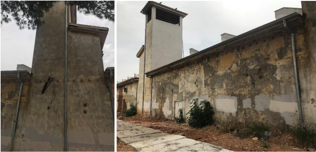
Şekil B. 6 : Batı cephesi muhdes elemanlar, kılcal çatlak görünümleri (Ceylan Akış).
