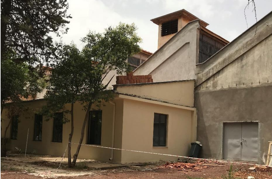
Şekil B. 12 : Dokuma A.Ş. tarafından kullanılan ofis birimi ve ana binada olması planlanan arşiv için açılan muhdes kapı açıklığı ile çatı onarımında kullanılan ekler (Ceylan Akış).
