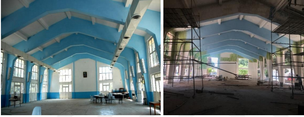
Şekil 6.10 : Yemekhane binası işçi yemekhanesi bölümü, 2015, (Kepez Belediyesi), işçi yemekhanesi bölümü restorasyon aşaması 2018, (Ceylan Akış).
