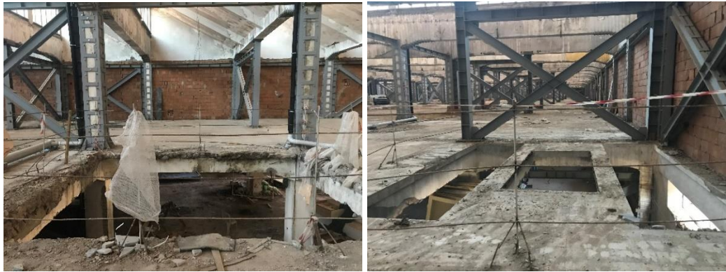
Şekil 6.34 : Merserize yıkama-bekleme havuz alanının atık toplama bölümü (solda), bodrum kata ulaşılan rampa ve merdiven boşluğu (sağda), (Ceylan Akış).
