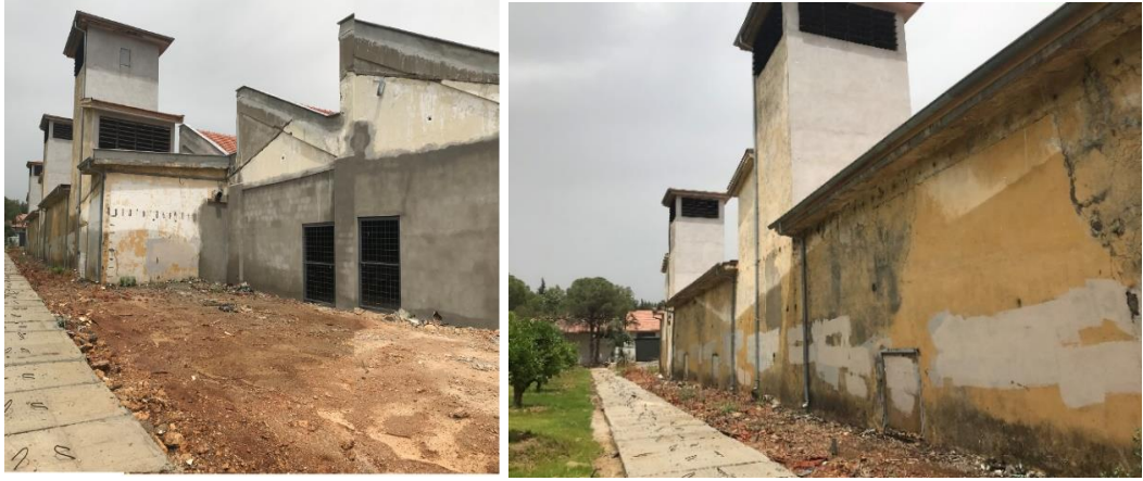
Şekil B. 7 : Soğtuma santrali alanına uygulama aşamasında eklenen kapı açıklıkları ile kapatılan merdiven alanı (solda) ve cephe duvarlarında bozulma detayı (sağda) (Ceylan Akış).
