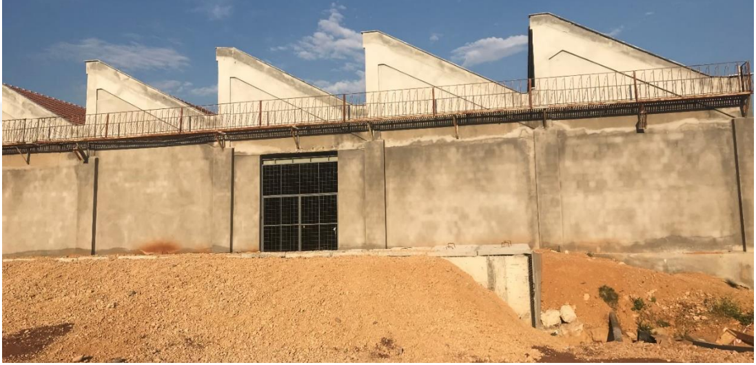
Şekil B. 2 : Uygulama aşamasında batı yönünün güney köşesinde kapatılan pencere açıklıkları ile ölçüsü değiştirilen kapı açıklığı (Ceylan Akış).
