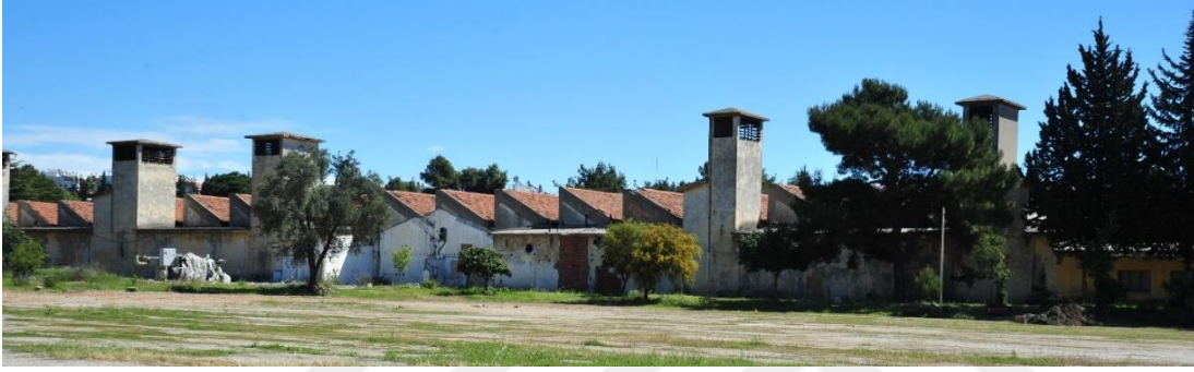
Şekil B. 5 : Soğutma Santrali olarak kullanılan alanın restorasyon uygulaması öncesi yıkılmış hali (Kepez Belediyesi).
