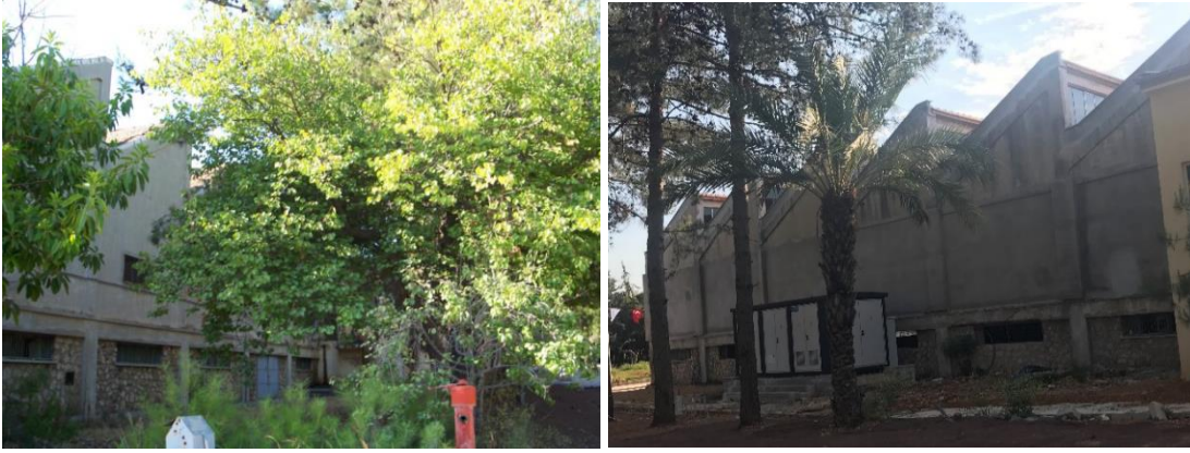
Şekil B. 16 : Doğu cephesi güney bölümü (solda), bodrum ve zemin katta kapatılan kapı açıklıkları (sağda) (Kepez Belediyesi).
