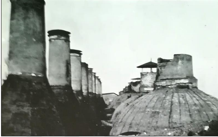
Resim 3.65: 1943 onarımlarından önce Mutfak bacalarının ve kubbelerinin durumu. 392
