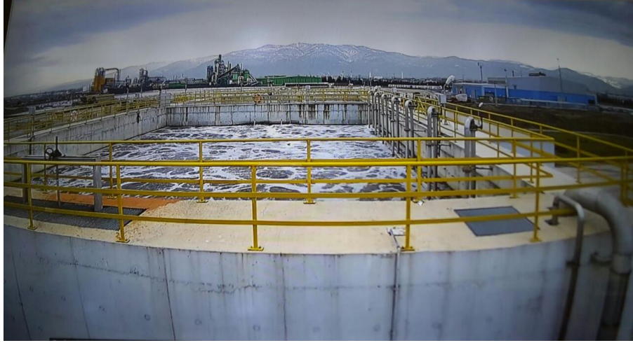
Görsel 5.2. Biyolojik(MBBR) arıtma ünitesi görüntüsü
