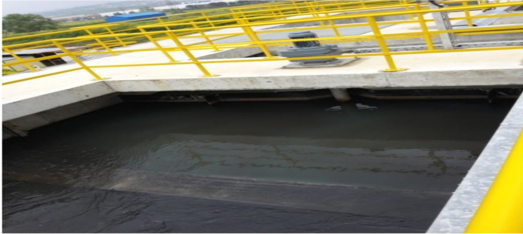
Görsel 5.5. Kimyasal Arıtma ünitesi görüntüsü(flokülasyon)
