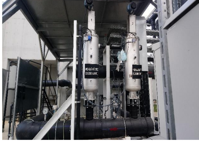
Görsel 5.7. Mekanik Filtre ünitesi görüntüsü
