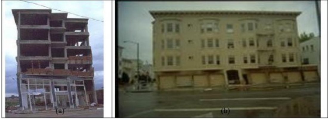
Şekil 2.13. 17 Ağustos 1999 Kocaeli depreminde yumuşak kat düzensizliğinden dolayı hasar gören binalar (Eren, 2009)
