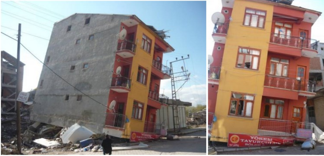
Şekil 2.14. Van depreminde yumuşak kat düzensizliğinden dolayı hasar gören bir bina (Atalay, 2015)
