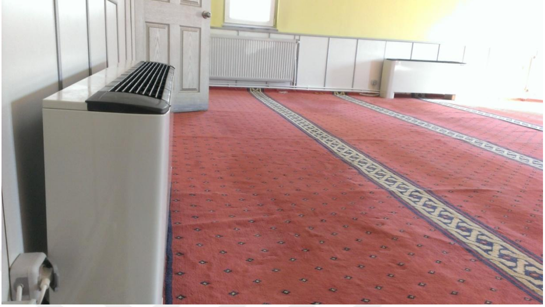
Şekil 3.10. Çalışma mahallinde kullanılan fan-coil cihazları
