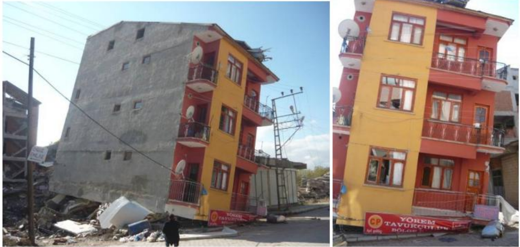
Şekil 2.10. Van depreminde B2 düzensizliğinden dolayı hasar gören bir bina.
