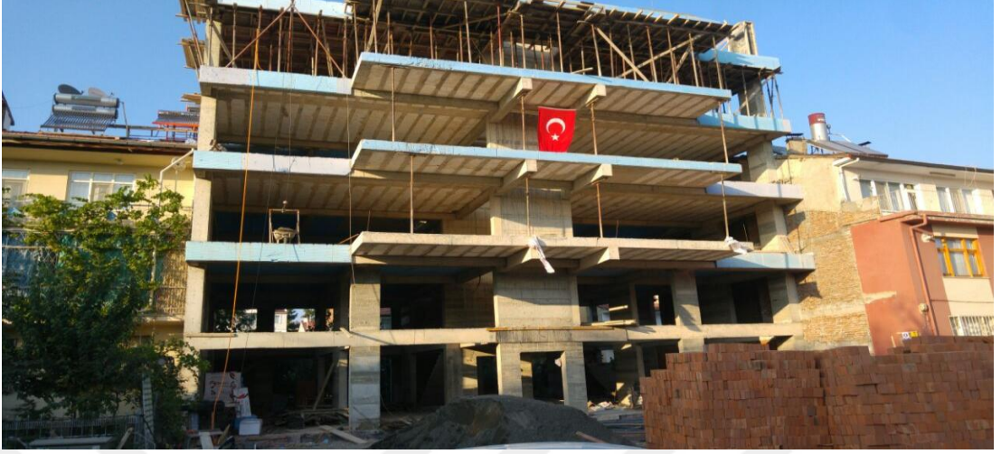
Şekil 2.13. Taşıyıcı sistem düşey elemanların süreksizliği durumu, Tokat 2016
