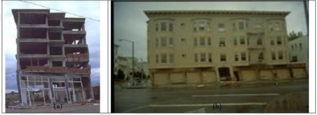
Şekil 2.9. 17 Ağustos 1999 Kocaeli depreminde B2 düzensizliğinden dolayı hasar gören binalar.
