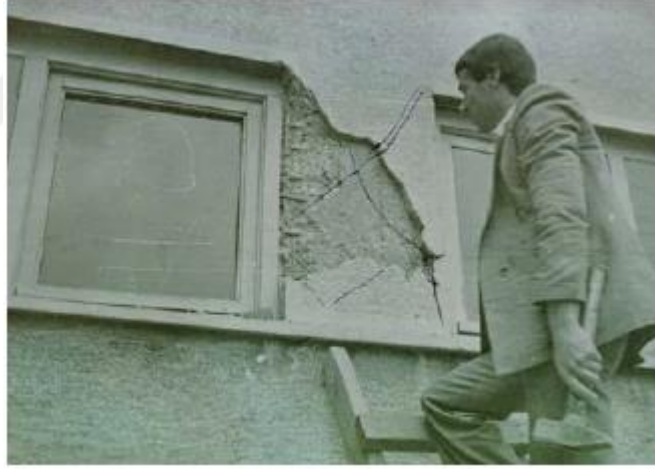
Şekil 3.17. 18 Kasım 1983 Erzincan depreminde bant pencereli bölümde sık etriyeli kolonda beton çatlamış ancak kısa kolon kırılmamıştır (Bayülke, 2003)
