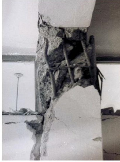
Şekil 3.11. 22 Mayıs Bingöl depreminde kısa kolon kırılması (Bayülke, 2003)
