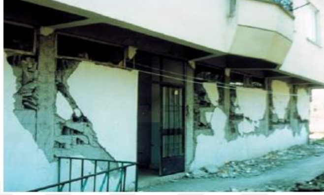
Şekil 3.16. 13 Mart 1992 Erzincan depreminde kısa kolon kırılmamasına rağmen düşük dayanımlı briket dolgu duvarlı bant pencere (Bayülke, 2003)
