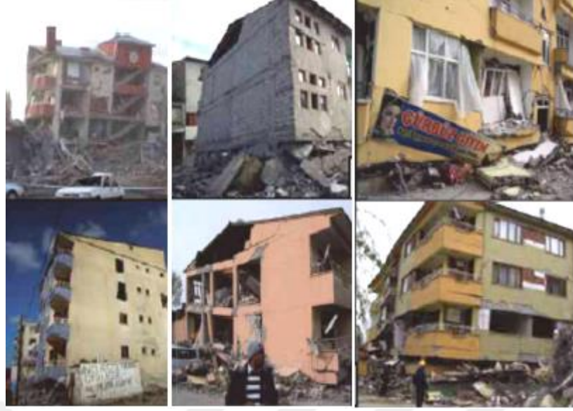
Şekil 3.8. Yumuşak kat düzensizliğinden dolayı yıkılan binalar (Timurağaoğlu, 2015)
