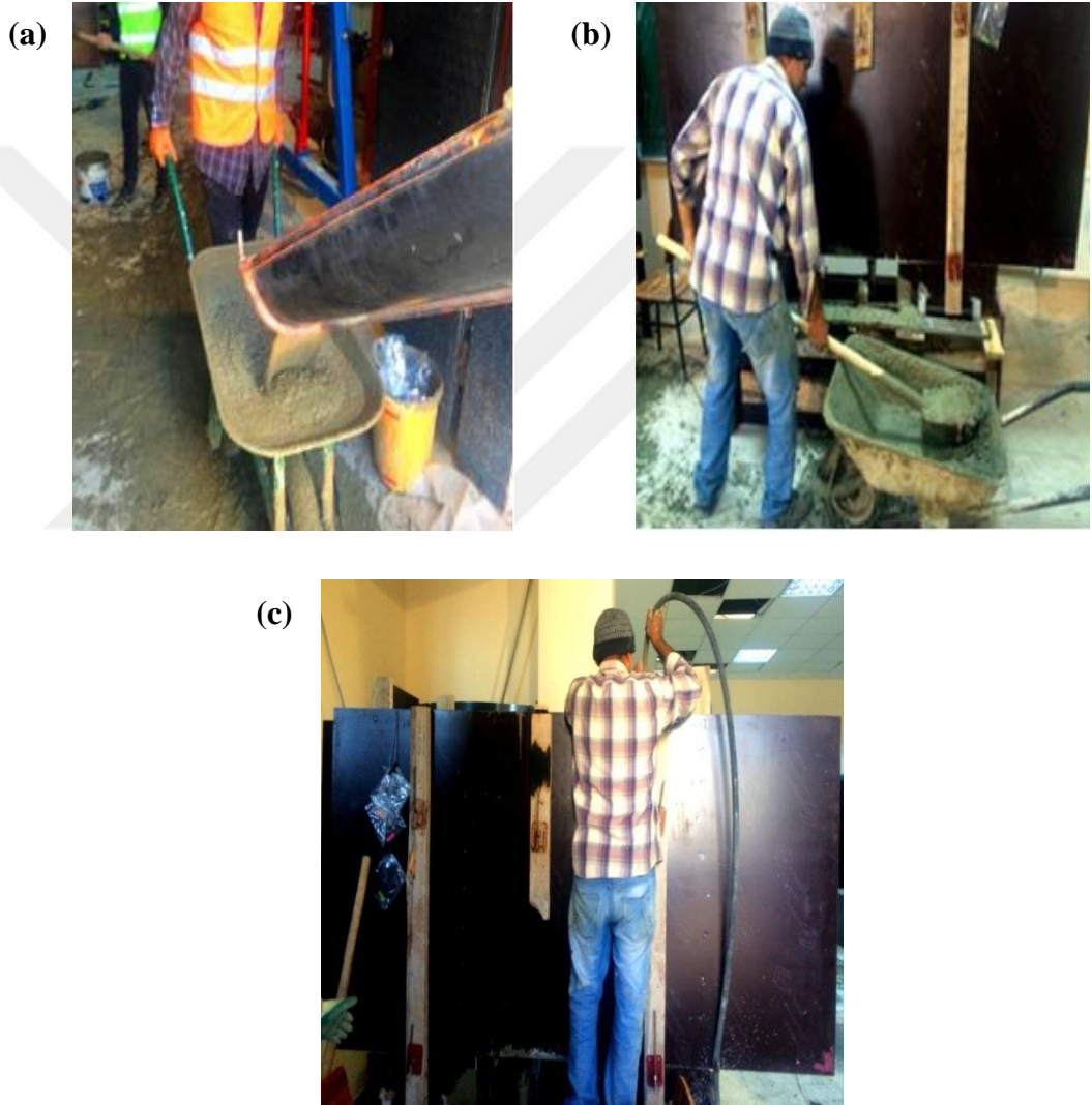
Şekil 4.13. Üç adet numunenin beton döküm işleri ((a) Betonun el arabaları yardımıyla taşınması, (b) Betonun kalıplara yerleştirilmesi ve (c) Betonun vibratörle sıkıştırılması)
