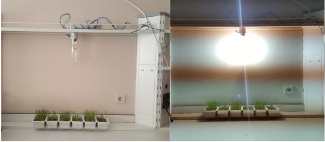
Şekil 4.7. Metal halojenli lambanın monte edildiği aydınlatma sistemi.
