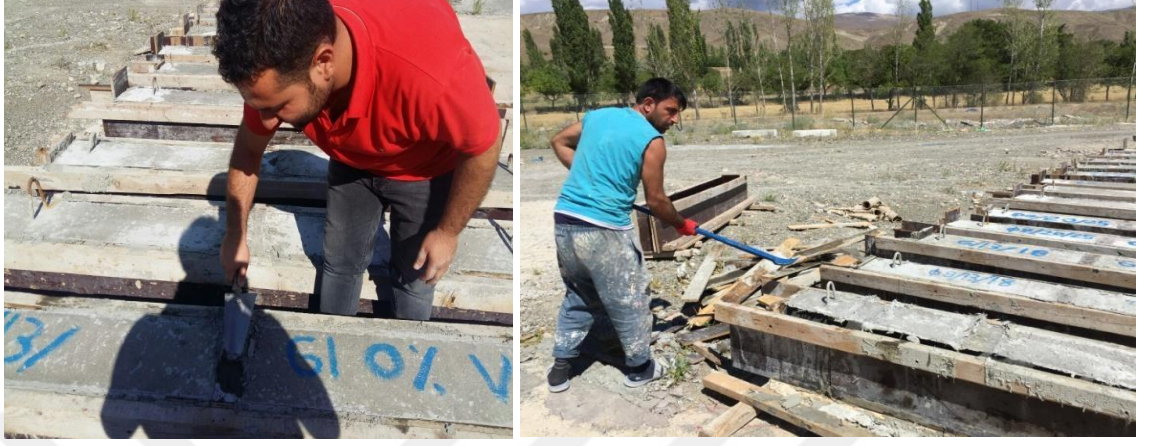
Şekil 3.15. Betonarme kiriş numunelerinde tamir harcı ile tadilat yapıma işlemi ve kalıpların sökülmesi.
