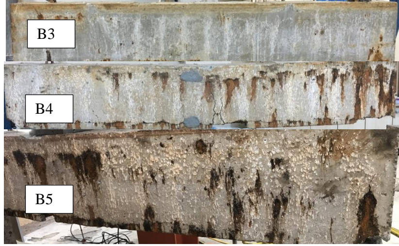
Şekil 4.31. Korozyona maruz kalmış kirişler
