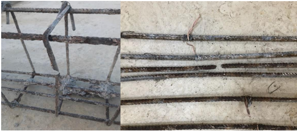
Şekil 4.27. Korozyona maruz kalmış donatılarda kopmalar
