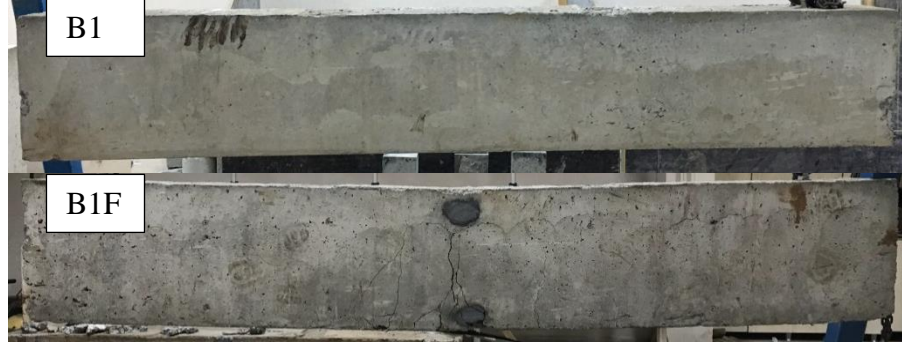
Şekil 4.29. Korozyona maruz kalmamış kirişler
