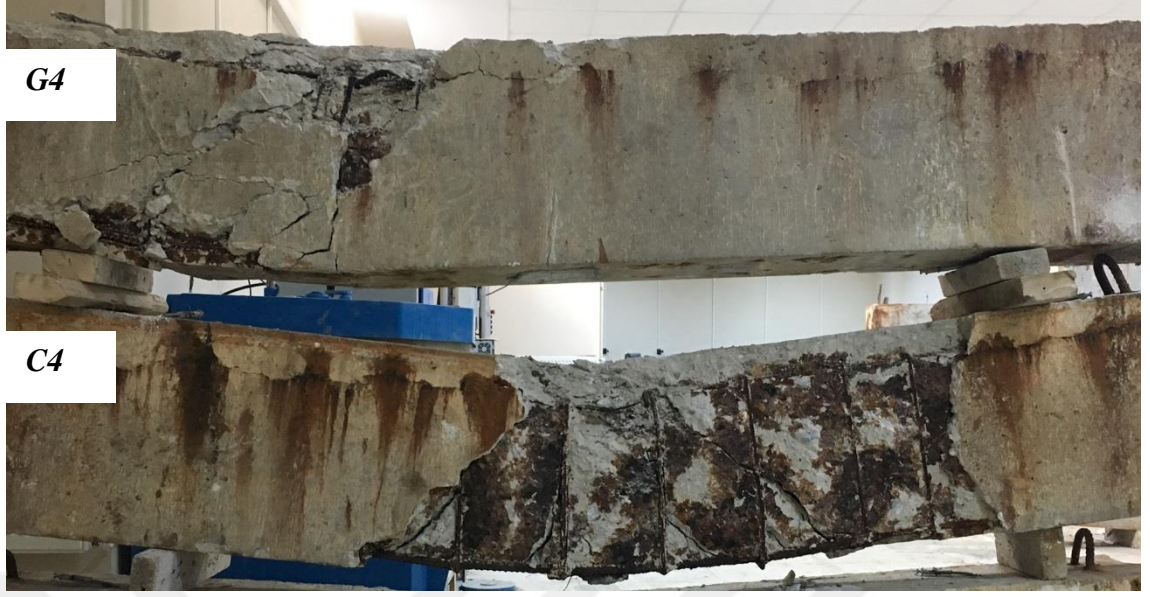
Şekil 5.19. G4 ve C4 Kırım Sonrası Çatlak Desenleri
