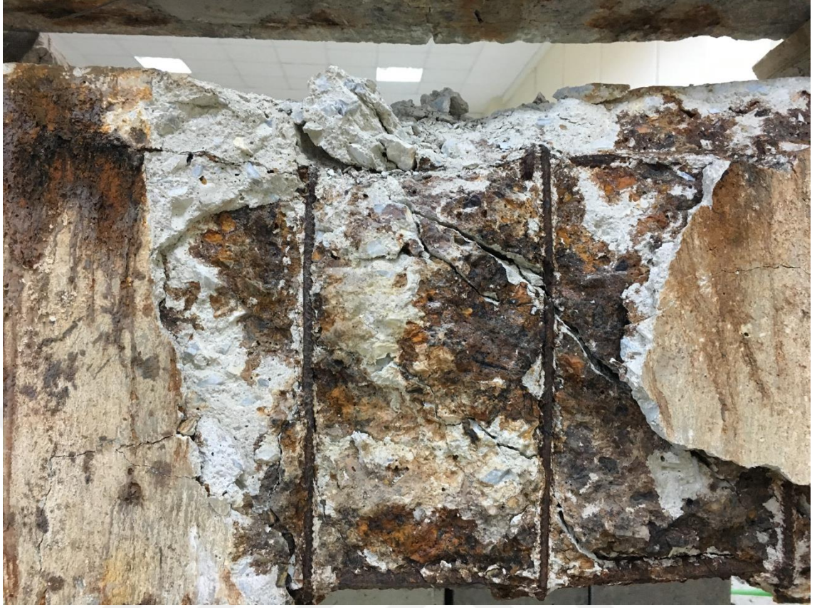
Şekil 5.23. C5 Kırım Sonrası Detaylı Çatlak Desenleri
