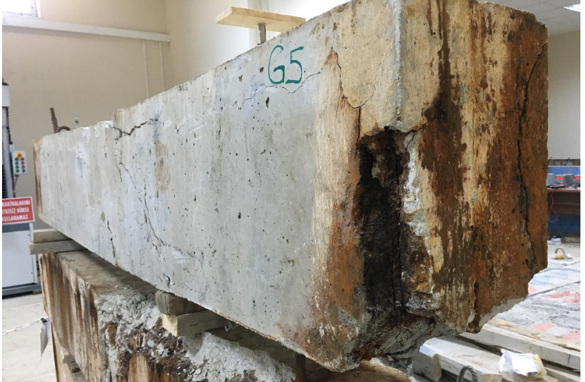
Şekil 5.24. G5 Kırım Sonrası Detaylı Çatlak Desenleri
