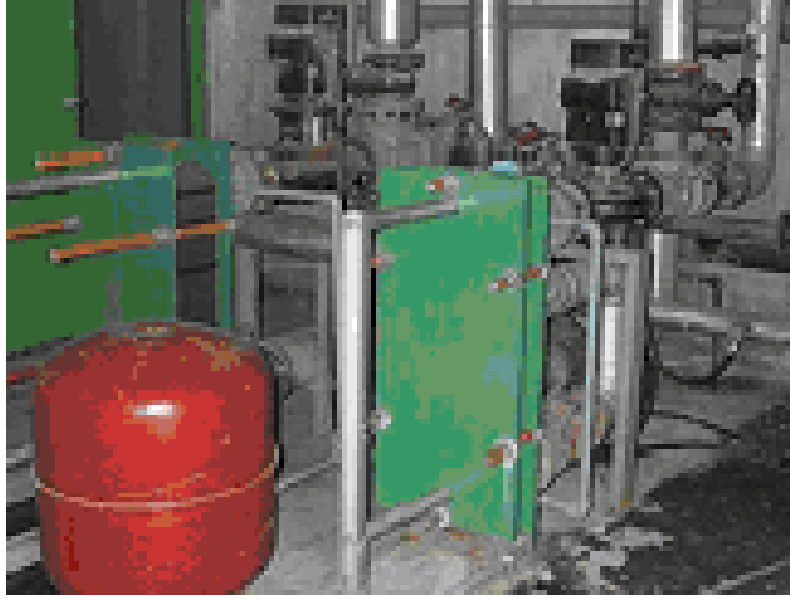
Şekil 3.3. Nuryıldız Tekstil Kojenerasyon Santrali (İçten Görünüş) [29].
