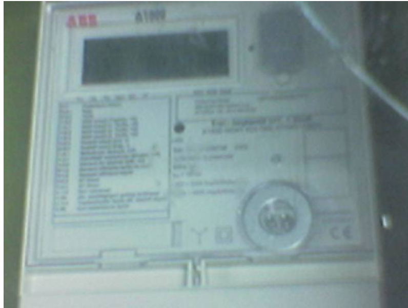
Şekil 4.4. GP-2 Dijital Elektrik Sayacı
