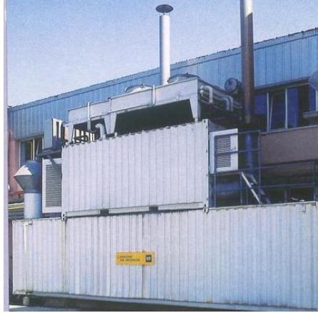
Şekil 3.1. Türk Henkel A.Ş. Gaz Motorlu Kojenerasyon Sistemi [27].
