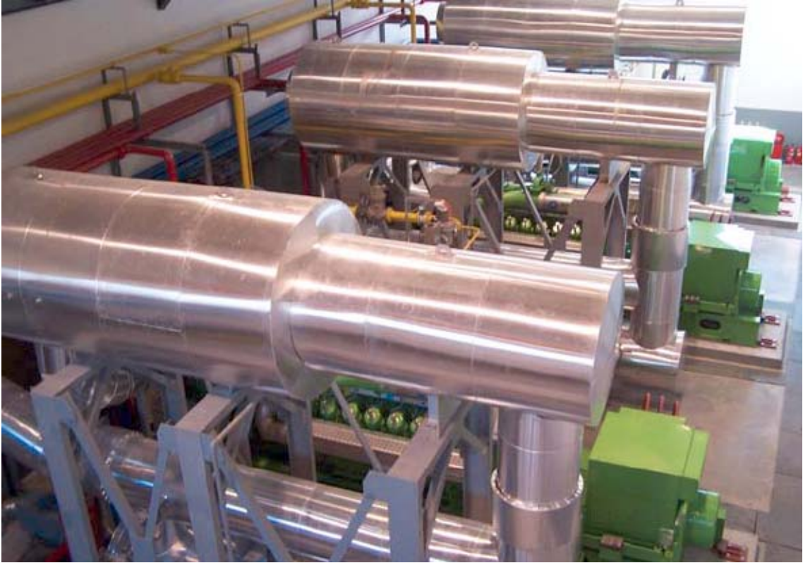
Şekil 3.7. Standart Profil Kojenerasyon Santrali [34].
