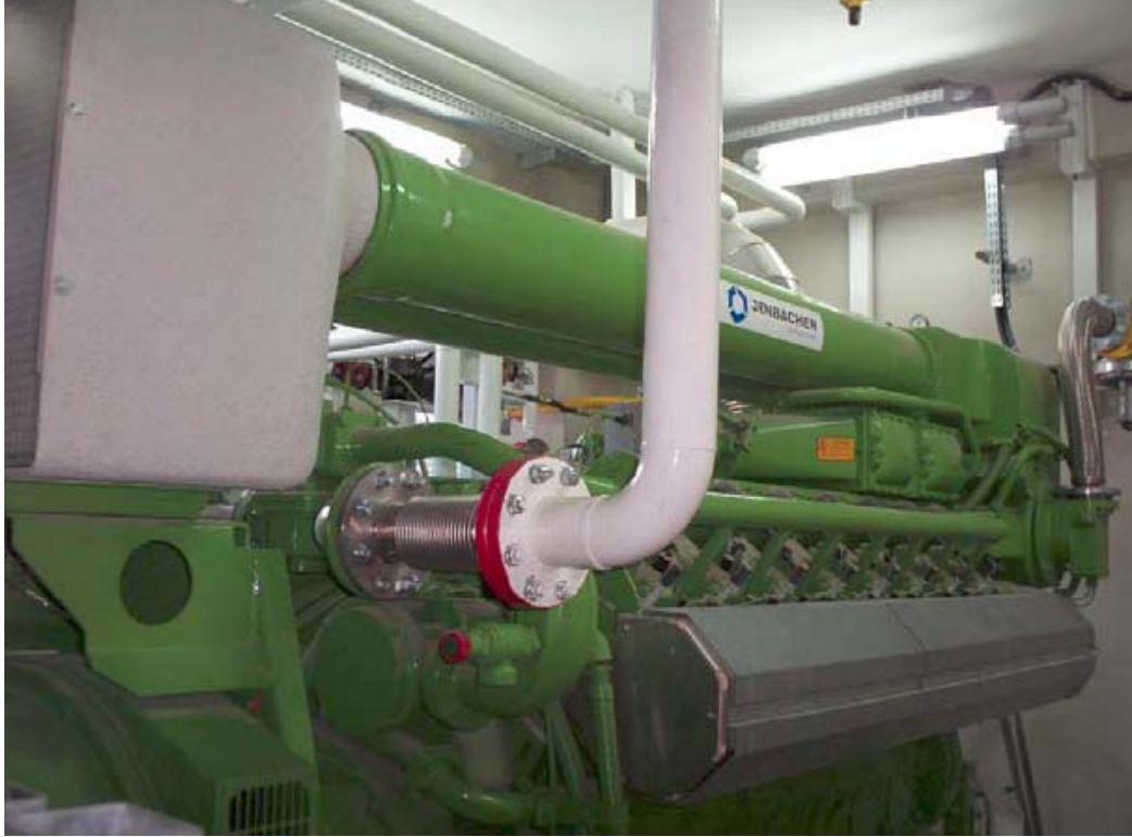
Şekil 3.6.Doğubayazıt Kojenerasyon Gaz Motoru [32].
