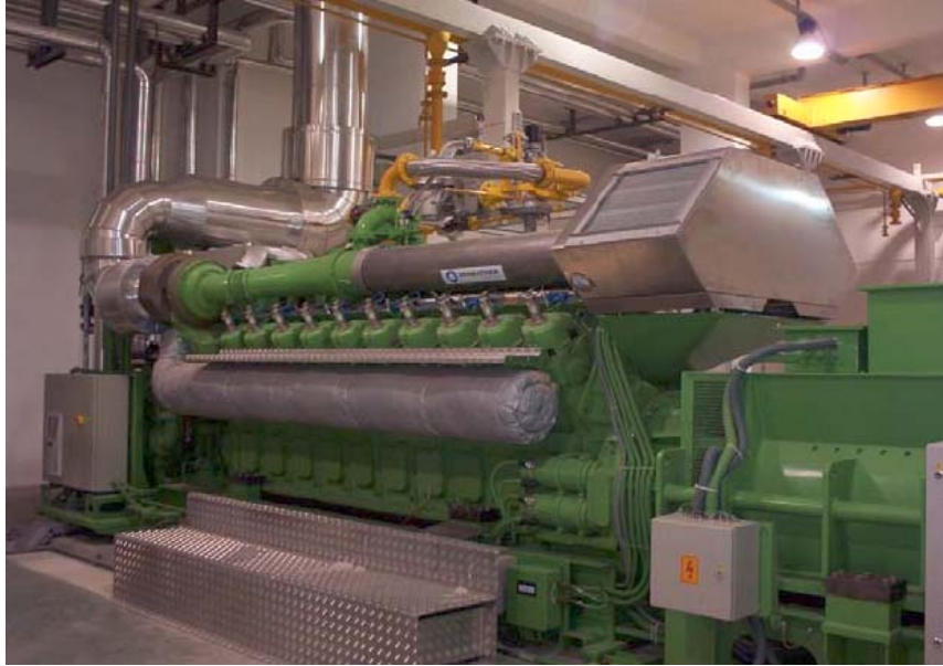
Şekil 3.5. Atateks Kojenerasyon Gaz Motoru [31].
