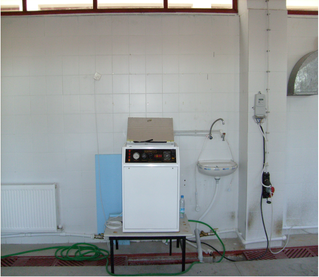
Ek 1 : Elektroşok ısıtma sisteminin fotoğrafı
