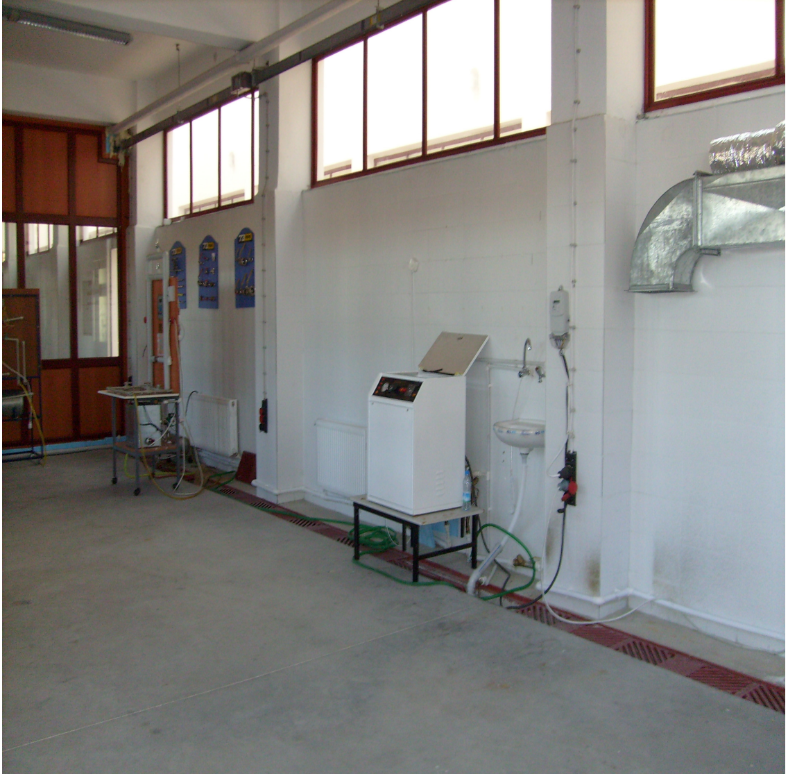
Ek 3 : Elektroşok ısıtma cihazı ve tesisatın fotoğrafı
