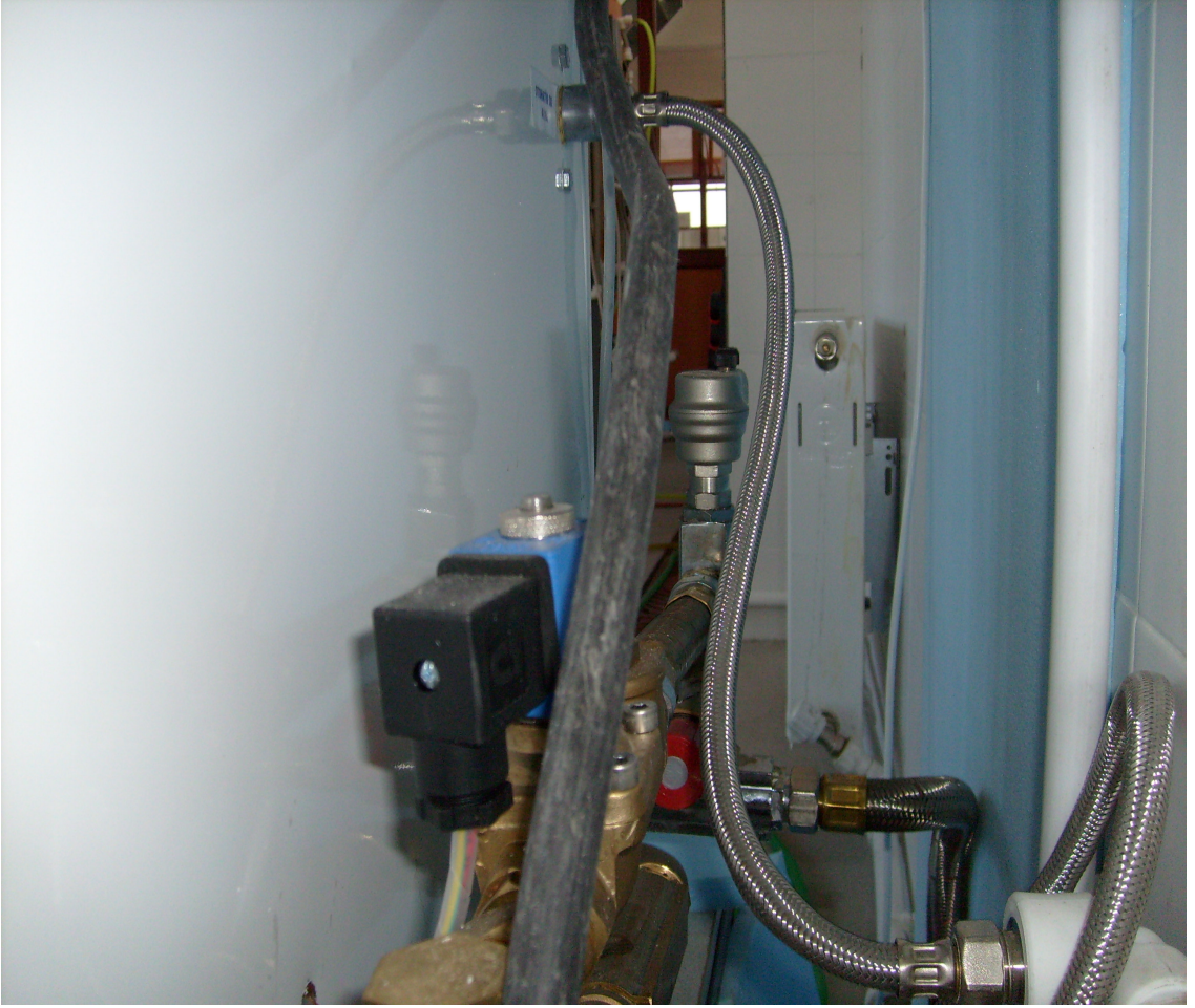
Ek 8 : Elektroşok ısıtma cihazının soğuk ve sıcak su bağlantı fotoğrafı
