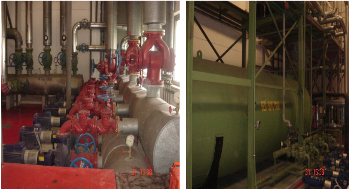
Şekil 4.8. Kazan Dairesinde Bulunan Pompaların ve Besi Suyu Deposunun Görünümü
