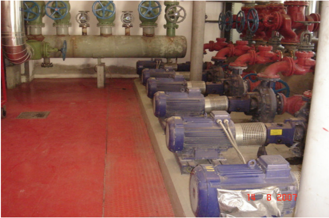
Şekil 4.6. Kızgın Su Pompaları [19]
