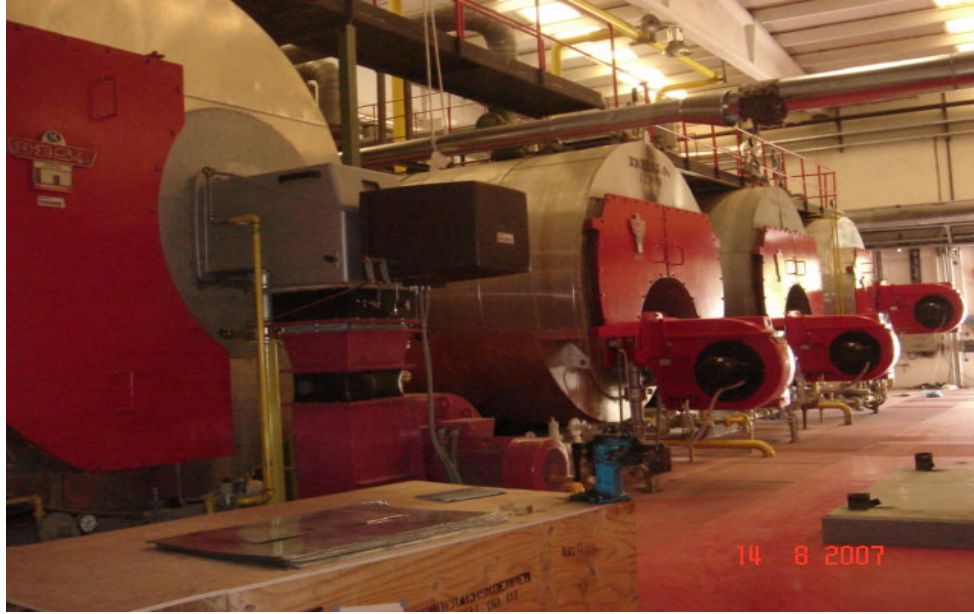
Şekil 4.3. Kazan Dairesinde Bulunan Pompaların ve Besi Suyu Deposunun [19]
