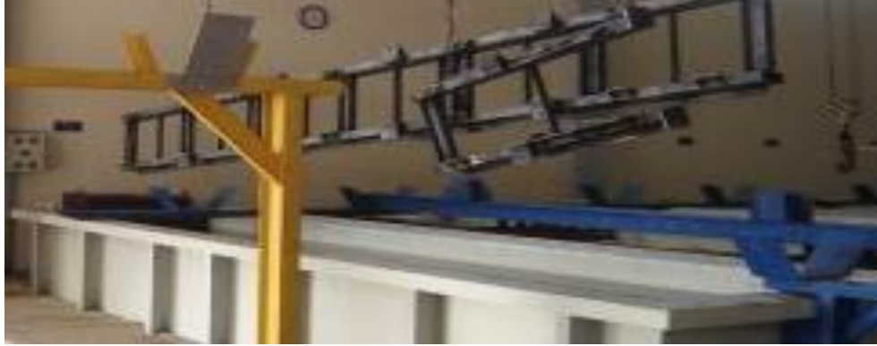
Şekil 1.3 Sıcak daldırma yöntemiyle galvanizleme yapan bir işletmeye ait galvanizleme banyosu.
