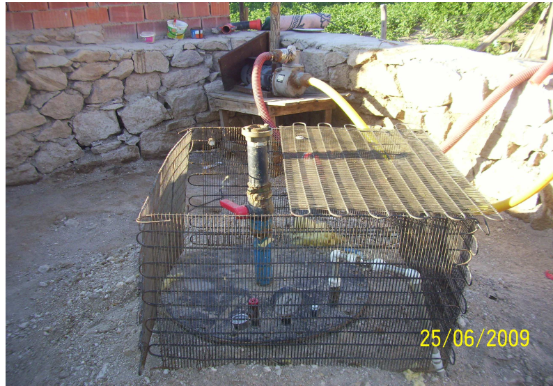
Şekil 9.10 Biyogaz reaktörü koruyucu kafes sistemi ve bağlantılar.
