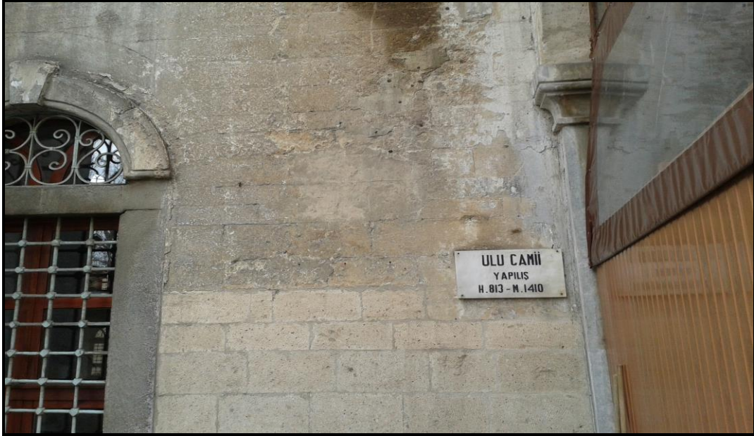
Şekil 2.5. Kütahya ulu cami duvarlarında su etkisiyle bozunma örnekleri.
