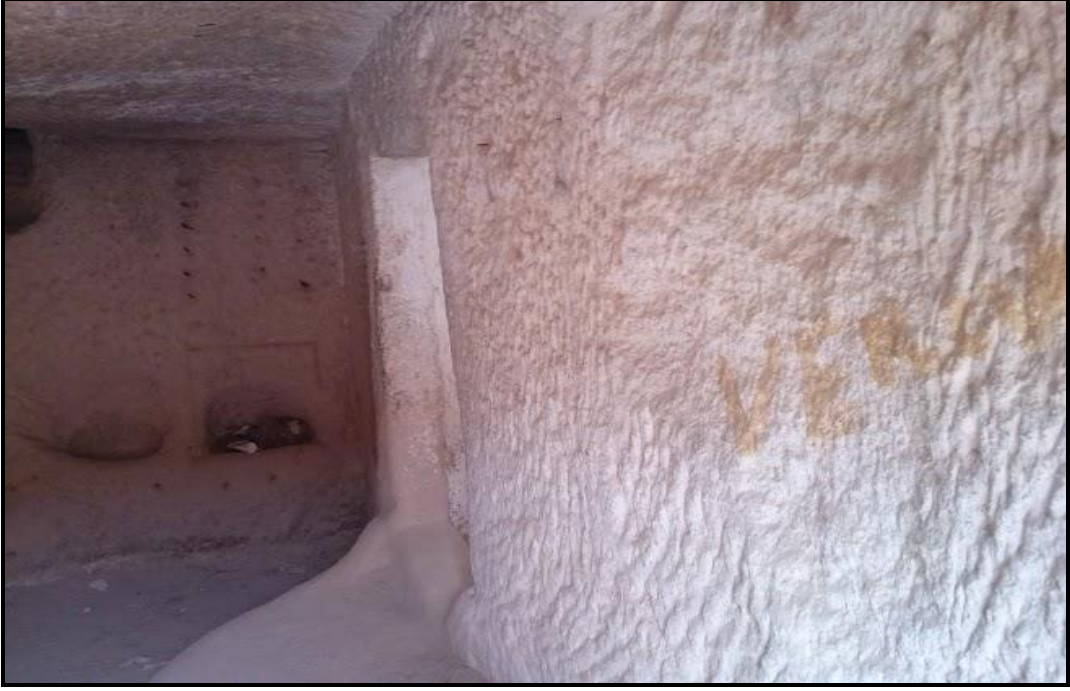
Şekil 2.11. Karbonatlaşma nedeniyle traşlama örneęi.
