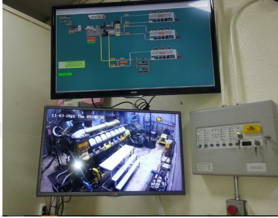
Şekil 7.7. Soğutma sistemi veri görüntüleme ekranı motor test alanı görüntüleme ekranı.
