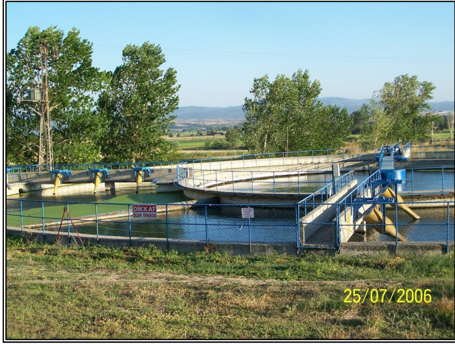
Şekil 69: Gümüşçay'da bulunan DEMKO Salça Fabrikası'na ait atık su arıtma bölümü
