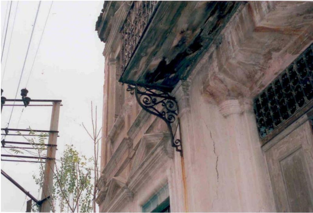
Resim 256: Katalog No:40 Balkon Taşıyıcı Elemanı Görünüşü (2006 – F.Oral)
