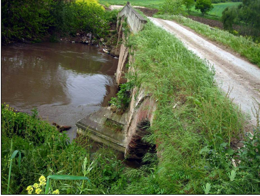
Foto.53: Nilüfer Hatun Köprüsü Orta Ayak Önündeki Selyaran.
