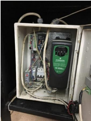
Şekil 6.3: Sürücü hız kontrol ünitesi.
