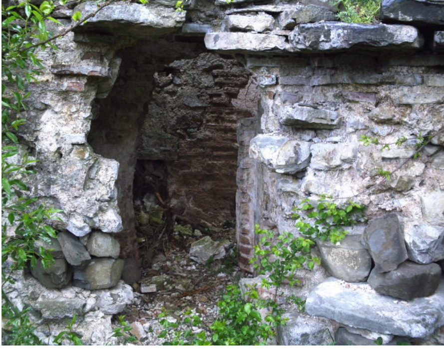
Resim 303 : Güzelköy Konak Hamamı Usturalık Yıkılan Doğu Duvarı .
