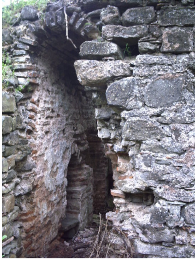
Resim 296 : Güzelköy Konak Hamamı Yıkılan Koridor Duvarı.
