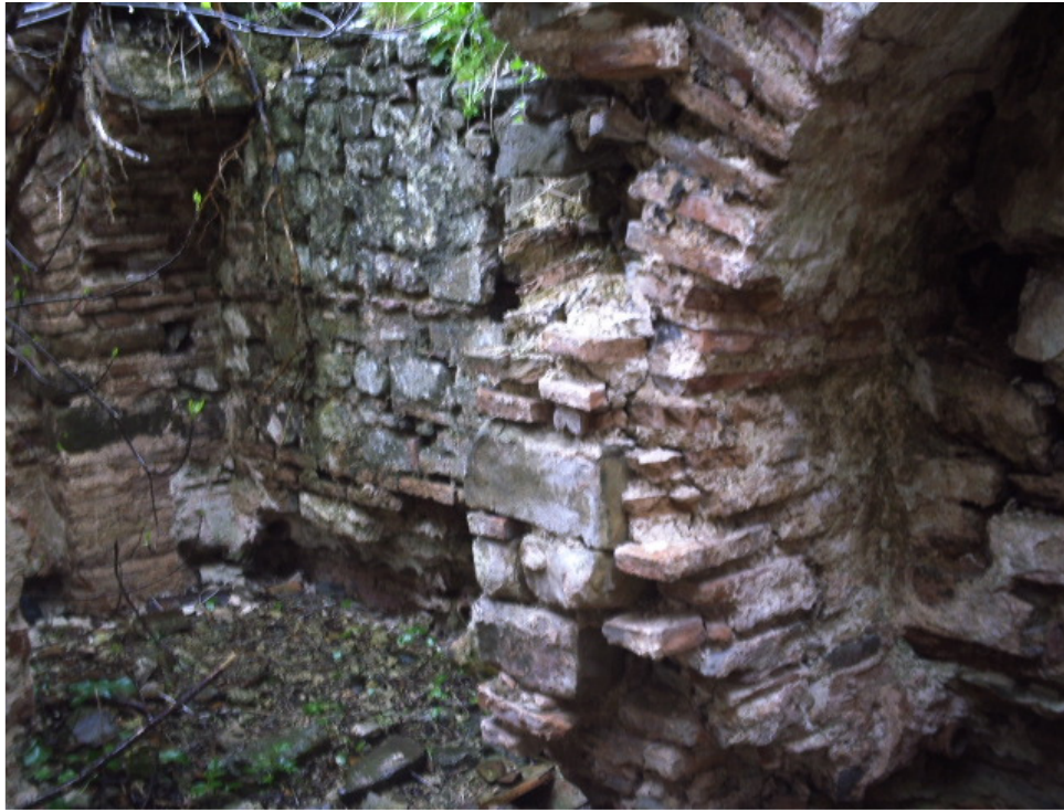
Resim 306: Güzelköy Konak Hamamı Ilıklık Kısmı Güney Duvarı.
