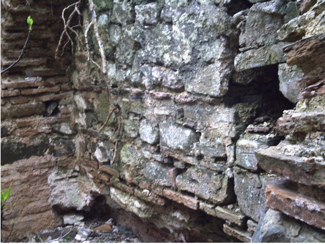
Resim 305: Güzelköy Konak Hamamı Ilıklık Kısmı Güney Duvarı.
