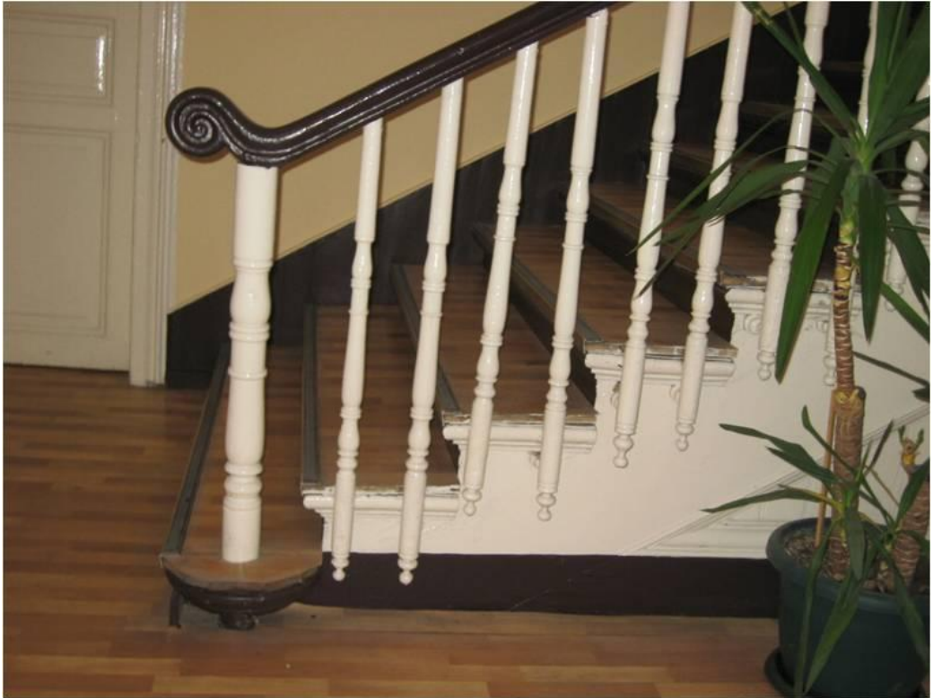
Resim 99: Süleymanpaşa Belediye Binası, restorasyon öncesi zemin kat merdiven korkuluklarının görünümü (Çağatay Çavuşoğlu).
