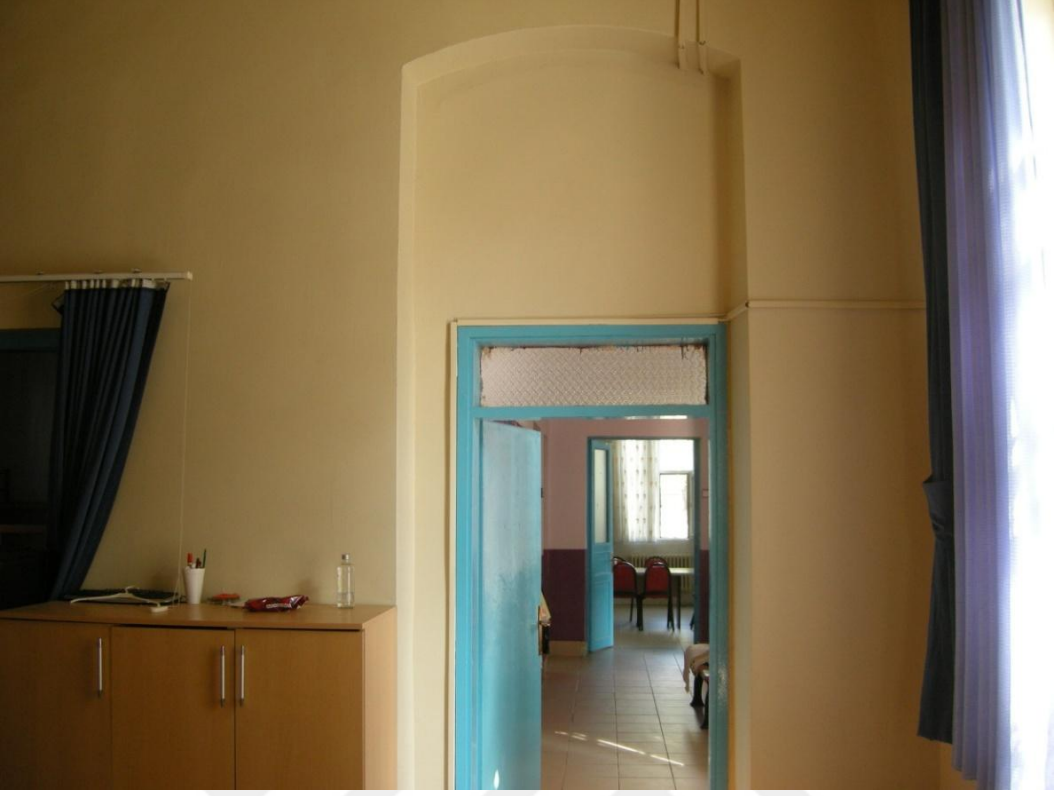
Resim 21: Yahya Kemal Beyatlı Anaokulu, zemin kat doğu cephede pencereden kapıya dönüştürülen açıklık.
