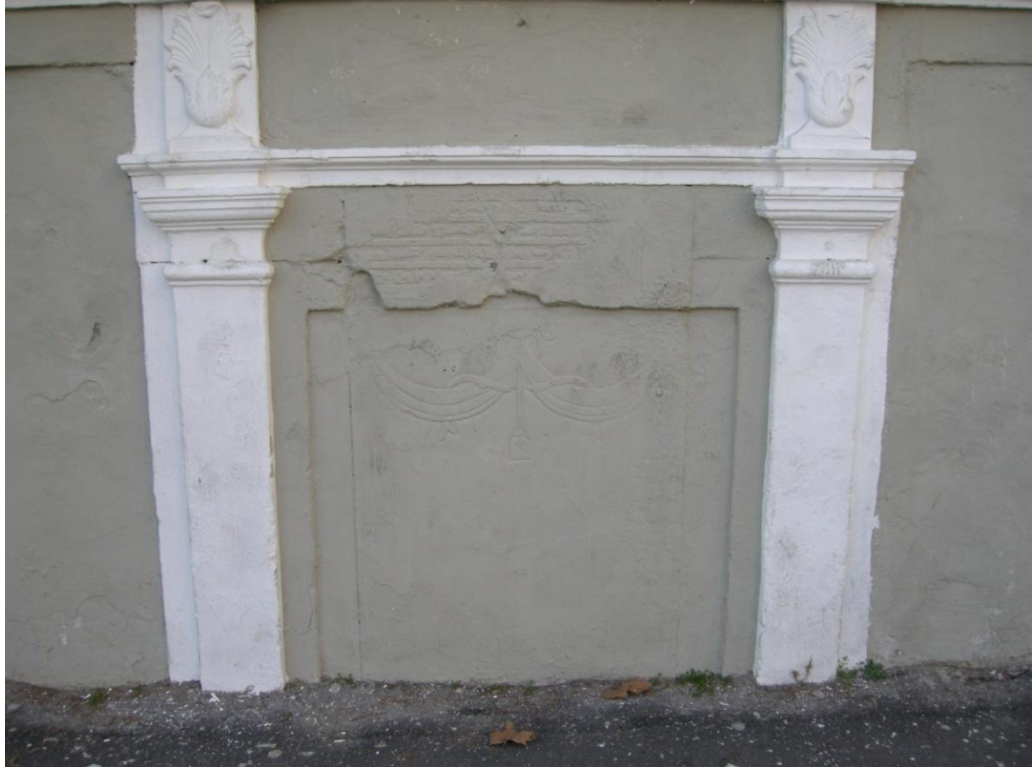
Resim 42: Güzel Sanatlar ve Spor Lisesi, 2. bodrum kat cephesinde çeşme.
