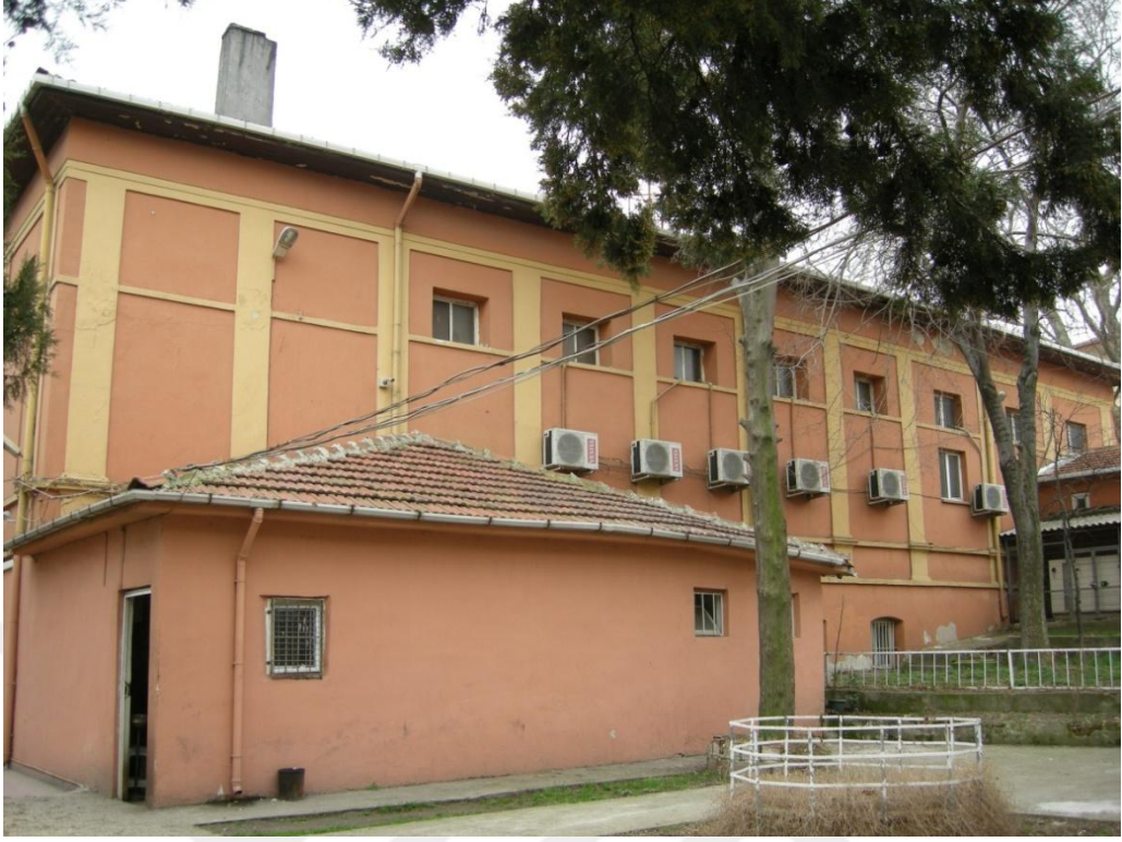
Resim 164: İl Milli Eğitim Toplantı Salonu ve İlçe Milli Eğitim Müdürlüğü, kuzey cephe.
