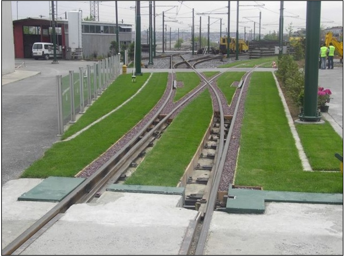
Şekil EK 2.14: Hemzemin geçitlerinde yerinde dökme beton ile boden boşluğu tespiti
