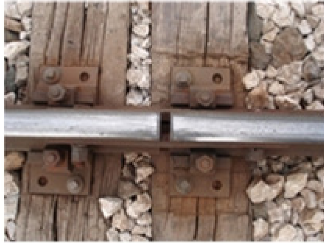
Şekil EK 2.3: Arızalı Ahşap Travers
