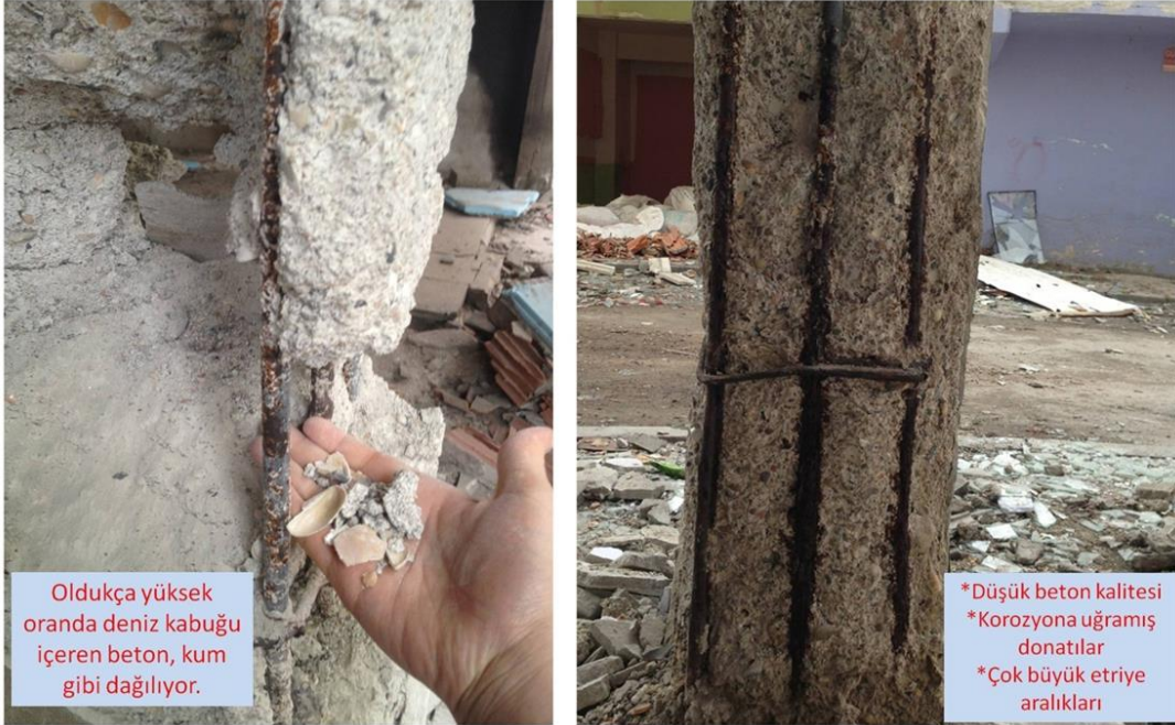
Şekil 5.21: Korozyona uğramış kolonlar
