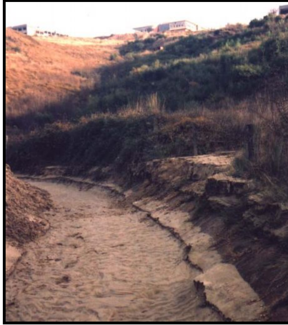
Şekil 5.2. Botanik Bahçesindeki Dere Kenarında Meydana Gelen Oyulmalardan Görünüm (Anon., 2002)
