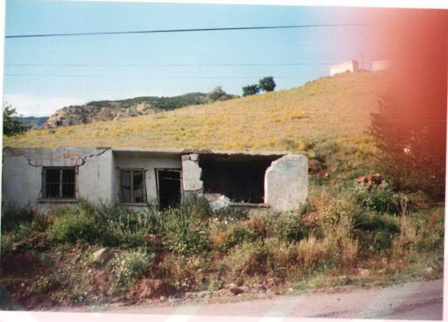
Foto 1.1. Orta mahalle civarında heyelanların etkisiyle hasar görmüş bir yapının görünümü.
