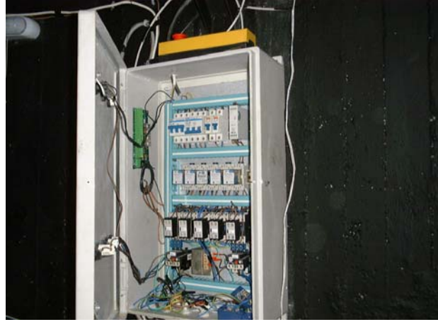
Şekil 5.7 Kubbe İçerisindeki Elektrik Panosu
