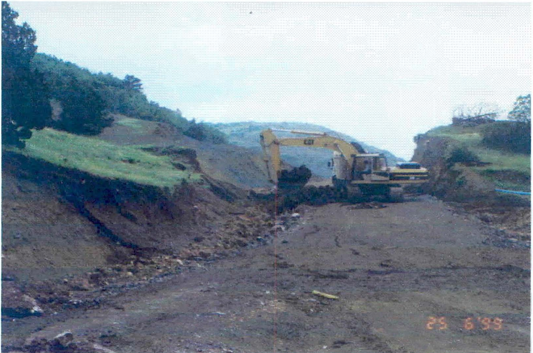
Foto 4.5. Heyelanlı bölgede yapılan makineli çalışma ve yolda oluşan çatlaklar.
