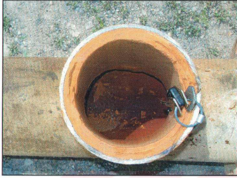
Şekil 3-2: Sıcak Çermik Sosyal Tesislerine su sağlayan borular içerisinde traverten oluşumu
